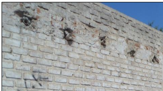
Figura 18. Erosión mecánica Nota. Fuente: (Broto C. 2005) (27)
