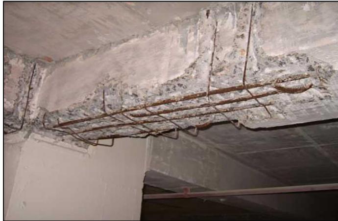
Figura 16. Patología del concreto armado
