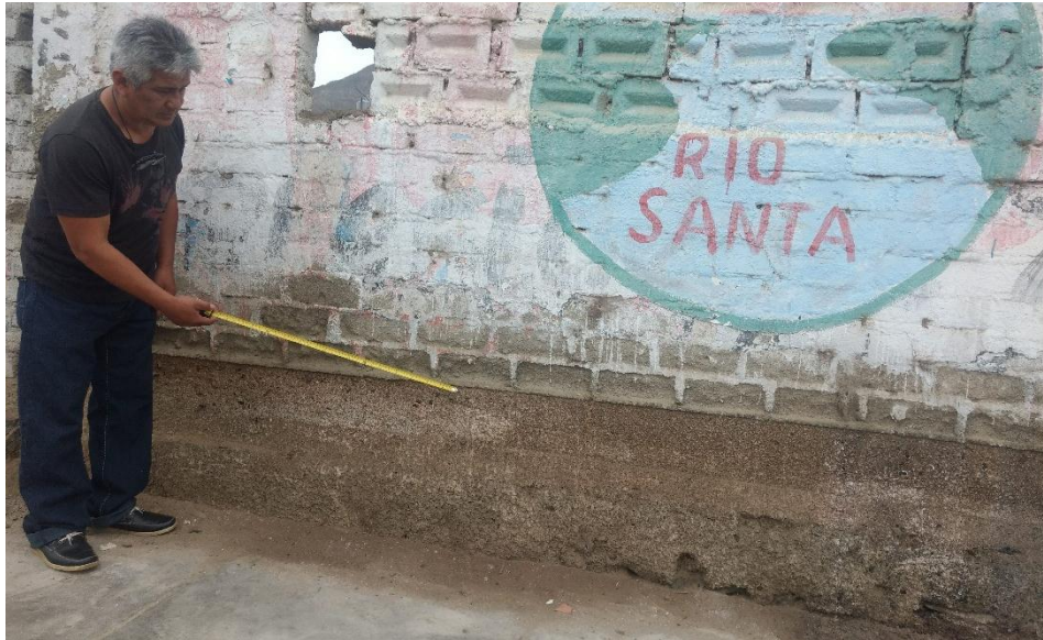
Fotografía 5. Erosión en la unidad de muestra 04
