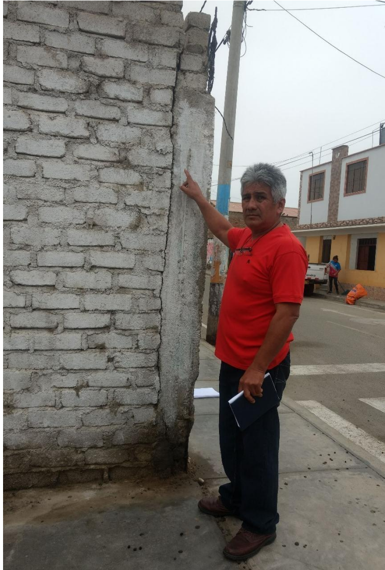
Fotografía 7. Grieta en la unidad de muestra 11
