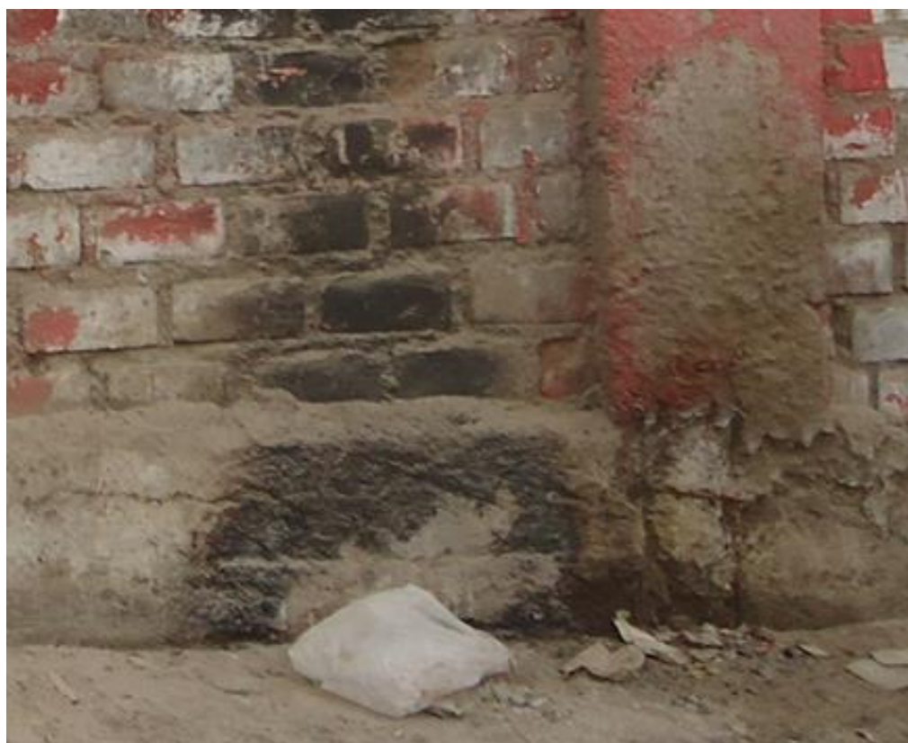
Foto 4 Corrosión en la UM 06
