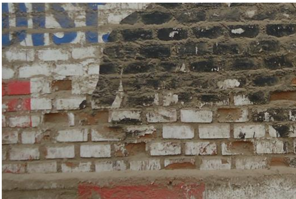
Foto 6 Erosión en la UM 05
