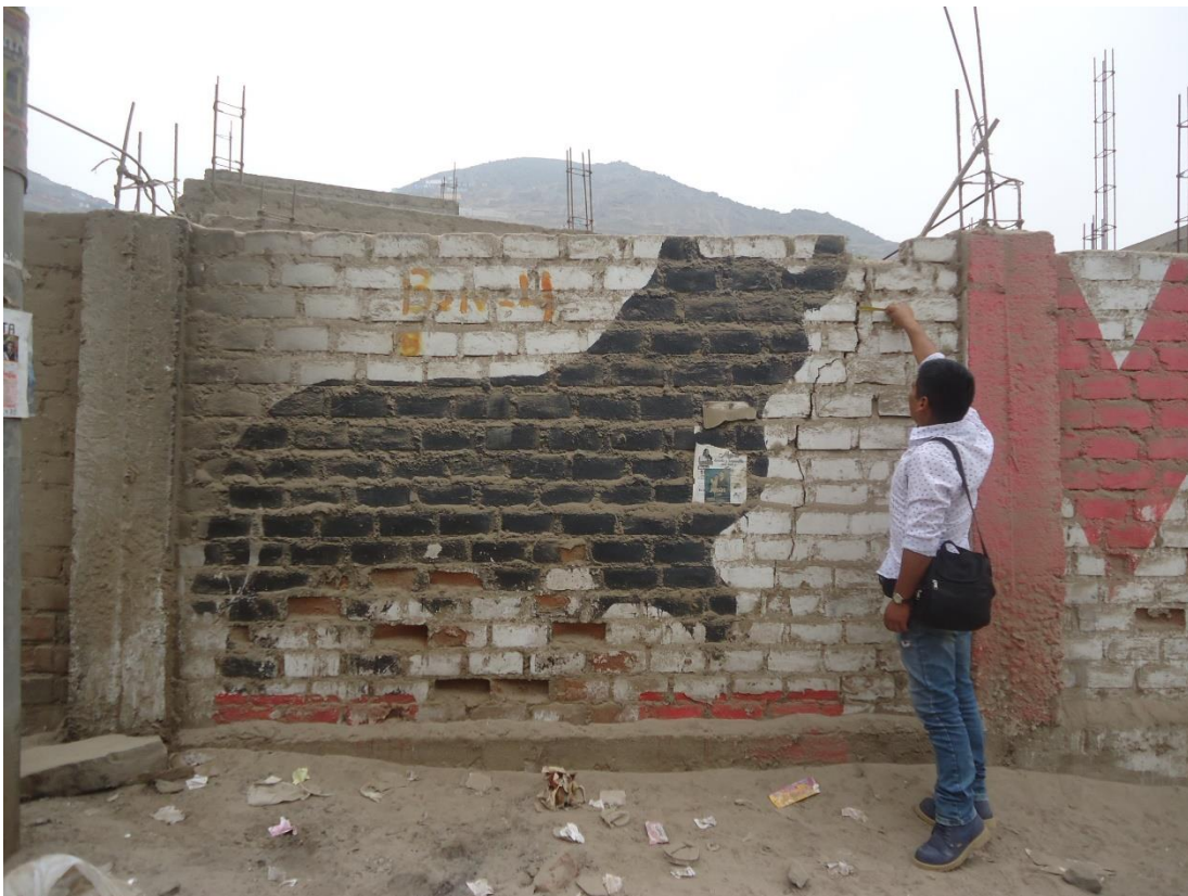
Foto 8 Dimensionando la patología
