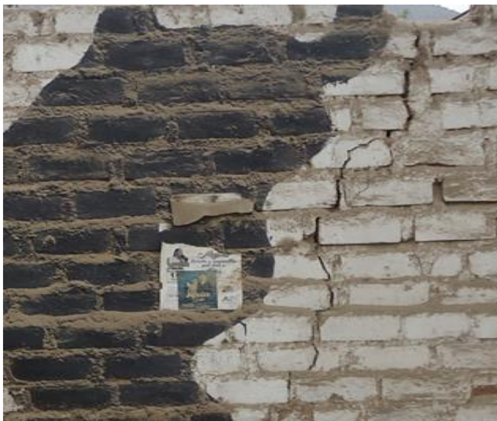
Foto 5 Grieta en la UM 01
