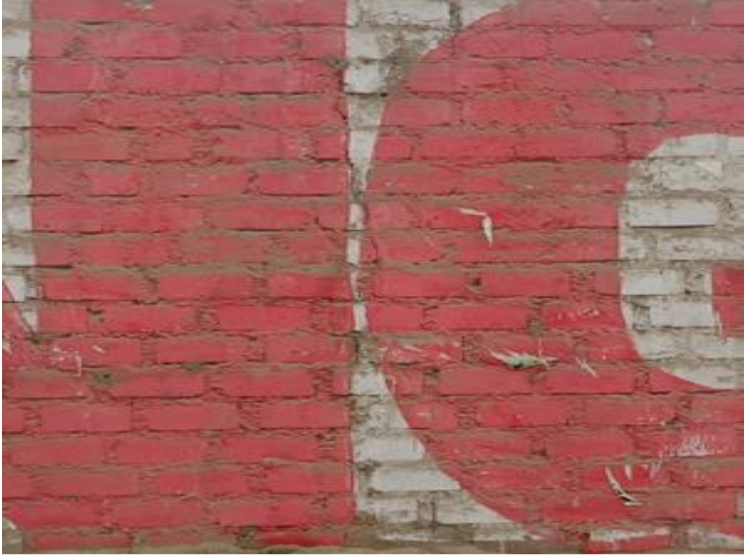
Foto 7 Fisura en la UM 10
