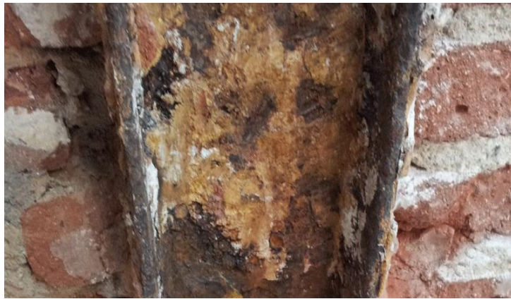
Figura 10: Imagen de corrosión
