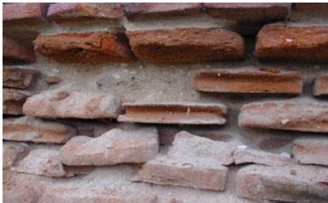
Figura 6: imagen de erosión.
