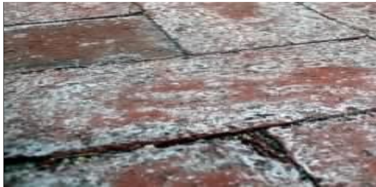
Figura 9: imagen de fisuras en paredes.
