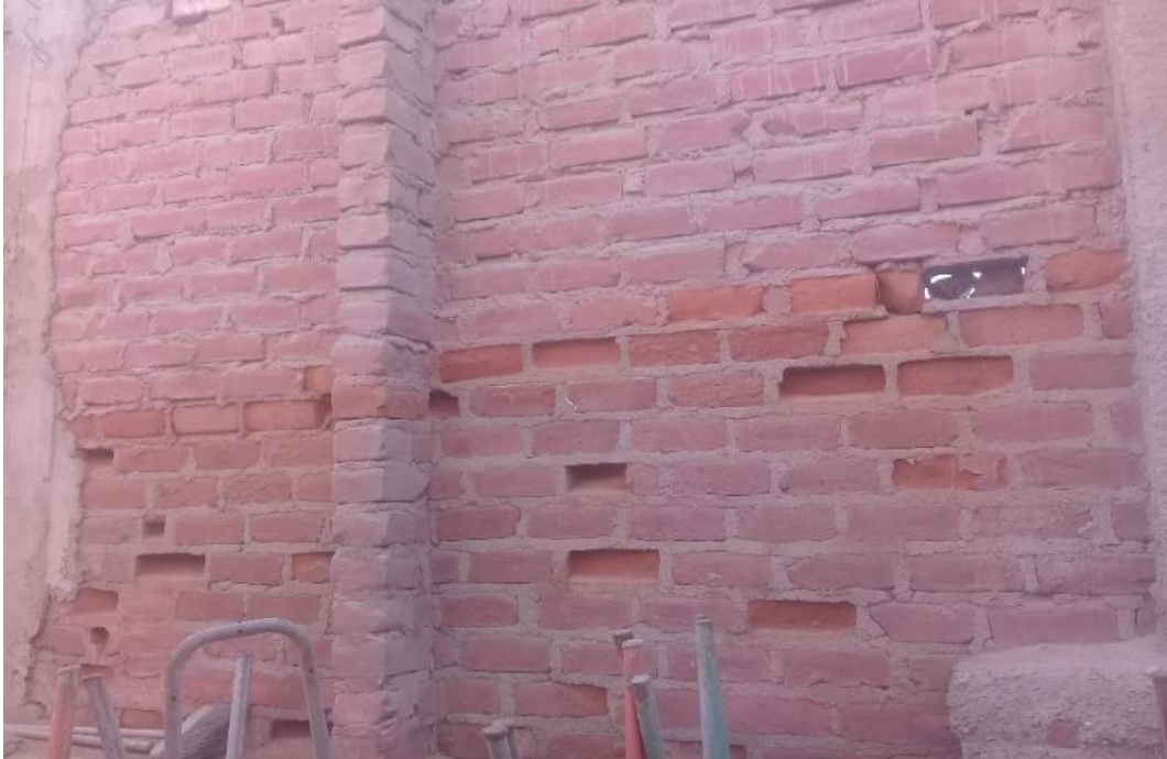
Fotografía 2: Albañilería afectada por erosión física unidad de muestra 2
