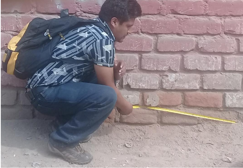
Fotografía 6: Muro afectada por erosión física en la Unidad de Muestra 12
