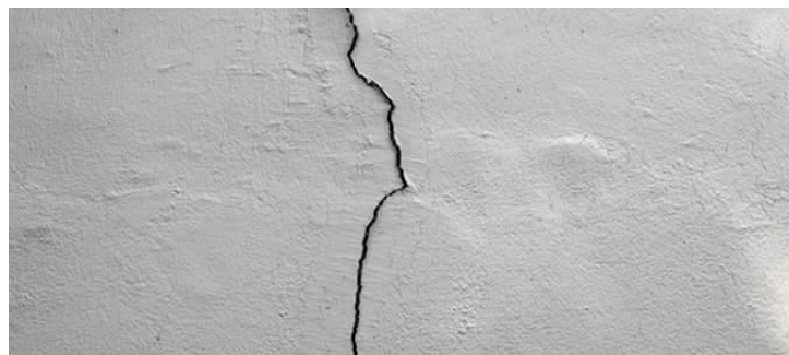
Figura 8: Imagen de fisuras en paredes.
