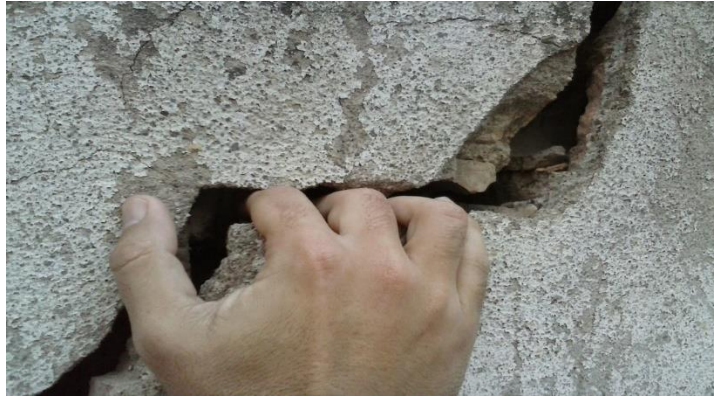
Figura 7: Imagen de grieta en muro.
