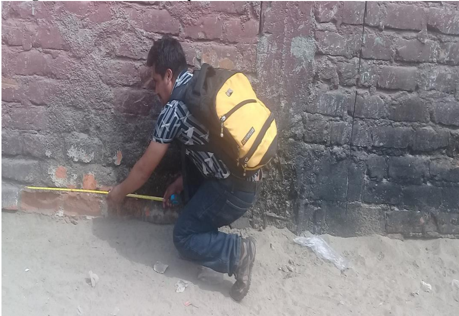
Fotografía 7: Muro afectada por erosión física en la Unidad de Muestra 06
