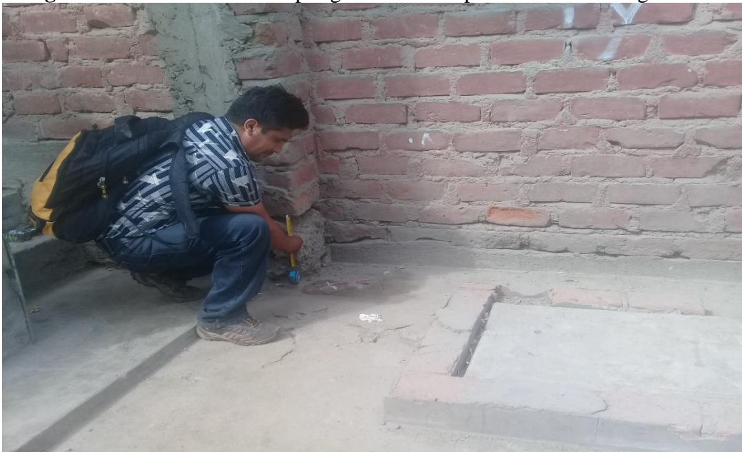
Fotografía 3: Columna afectada por grieta como se podrá ver en la fotografía
