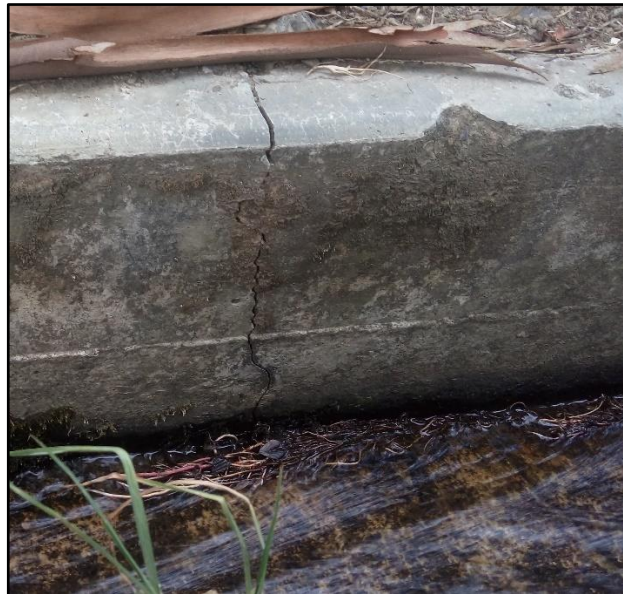
Gráfico 15. Grietas - Canal de riego Monterrey.
