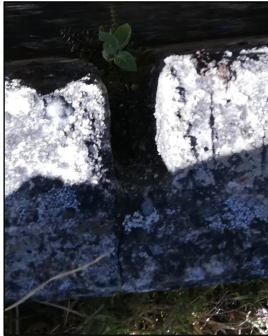
Gráfico 17. Sello de Junta - Canal de riego Monterrey.
