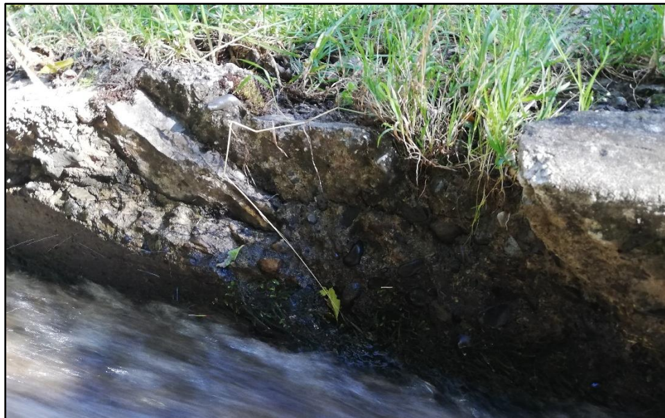
Gráfico 14. Erosión - Canal de riego Monterrey.
