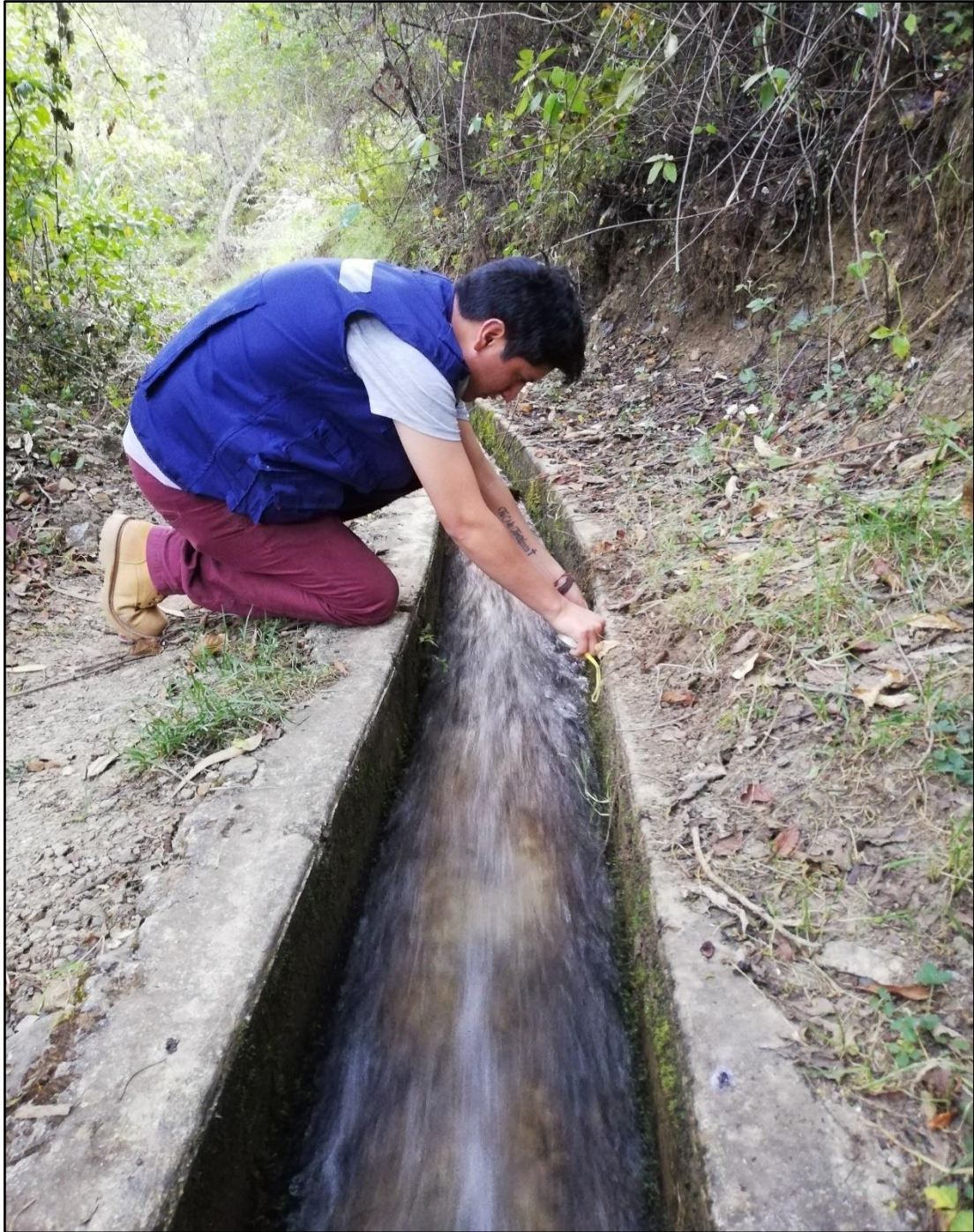
Fotografía 07: En esta fotografía se puede apreciar la toma de medidas de la patología (musgo) ubicada en el muro derecho del canal de riego Monterrey.
