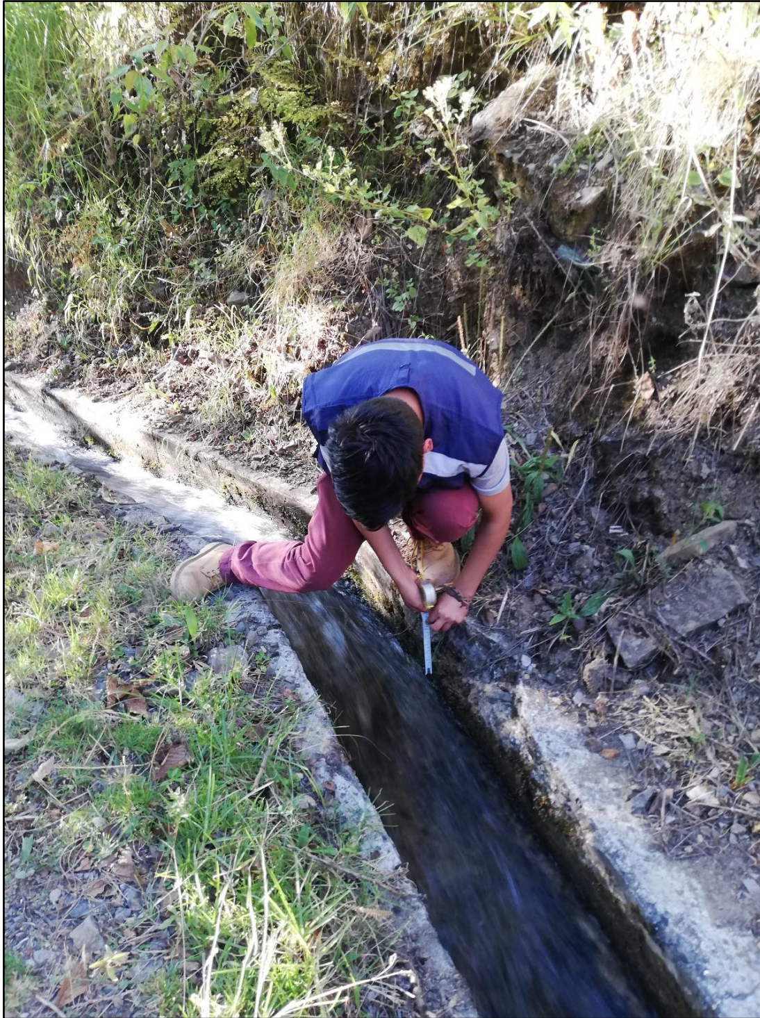
Fotografía 04: En esta fotografía se puede apreciar la toma de medidas de la patología (erosión) ubicada en el muro derecho del canal de riego Monterrey.
