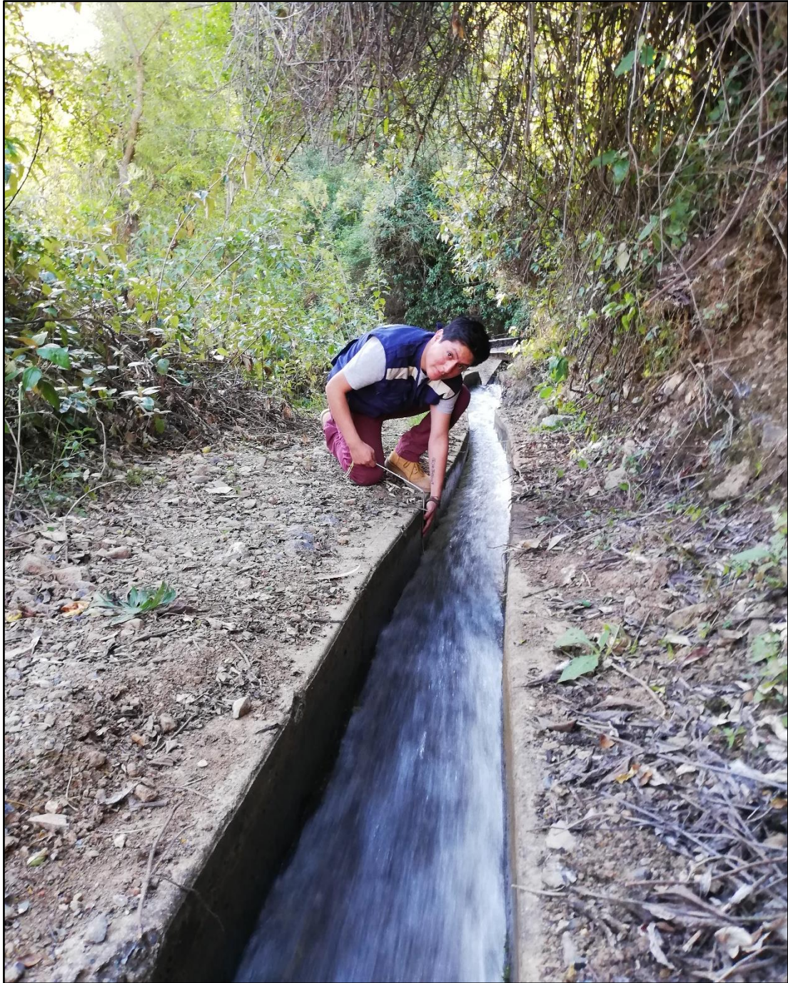
Fotografía 06: En esta fotografía se puede apreciar la toma de medidas de la patología (erosión) ubicada en el muro izquierdo del canal de riego Monterrey.
