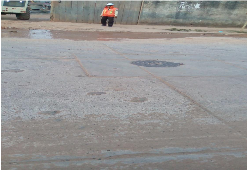
figura 123: daño de parche grande
