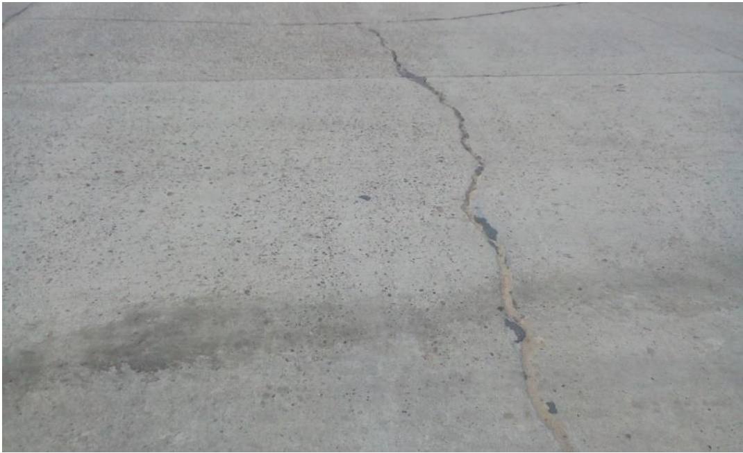
Figura 132: vista de daño grieta lineal
