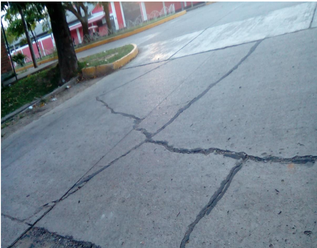
figura 139 daño de losa dividida
