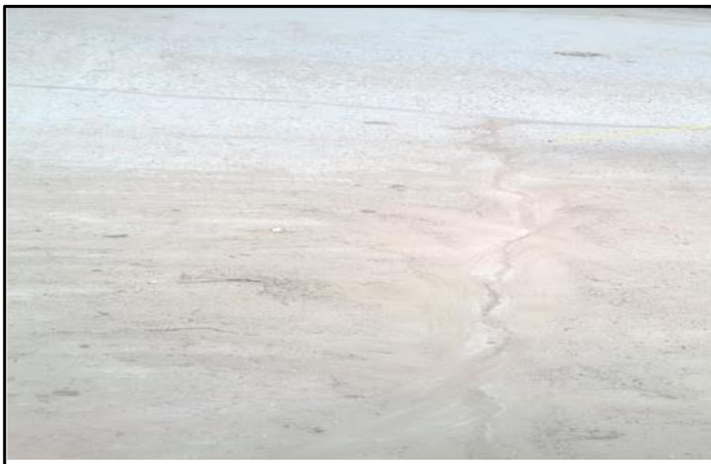
Figura 14: Grieta lineal transversal de media severidad.
