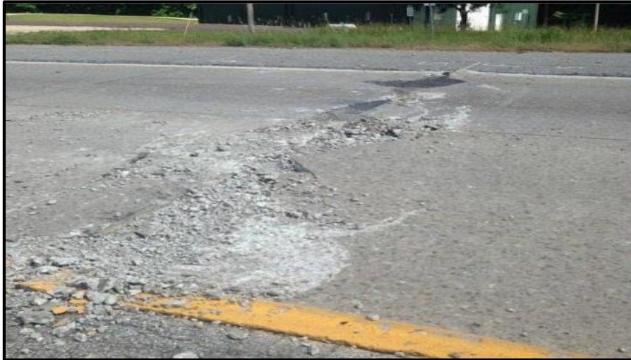
Figura 10: Blowup – Buckling (21) de severidad media.
