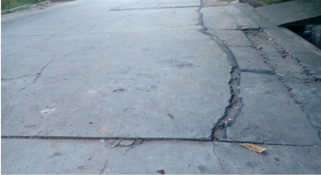
Figura 138: vista de daños, parche grande, daño del sellado de junta, losa dividida
