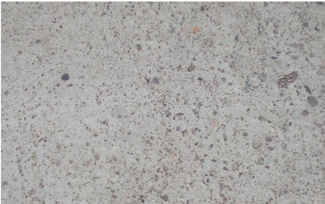
figura 133: daño de graquelado , pulimiento de agregado
