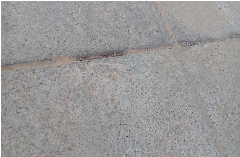
Figura 124: vista daño de junta
