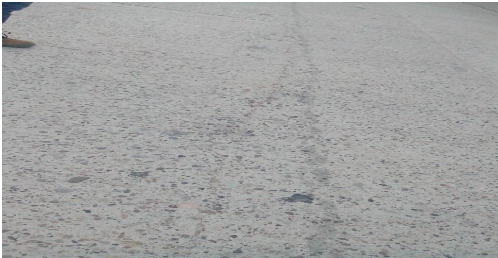
Figura 16: desconchamiento nivel de severidad media
