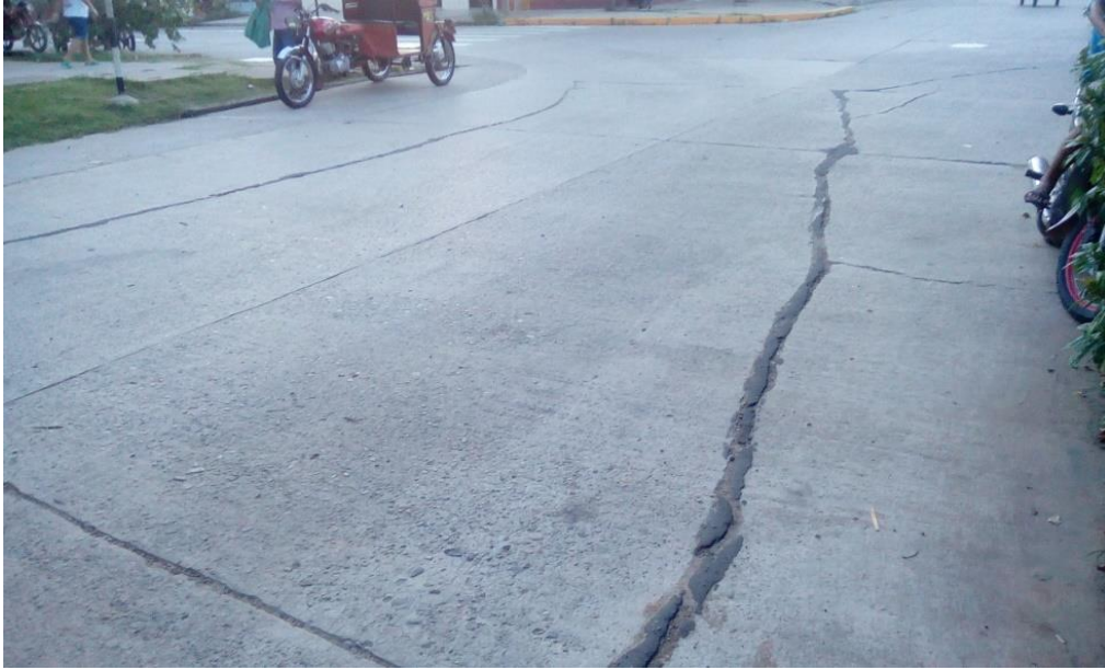
Figura 135: vista de daño grieta lineal
