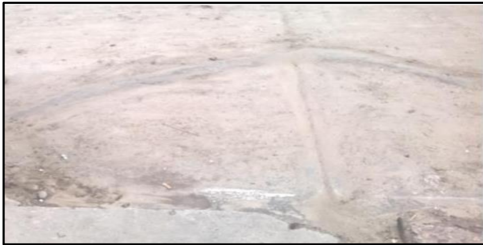
Figura 17: Descascaramiento de esquina de severidad media.
