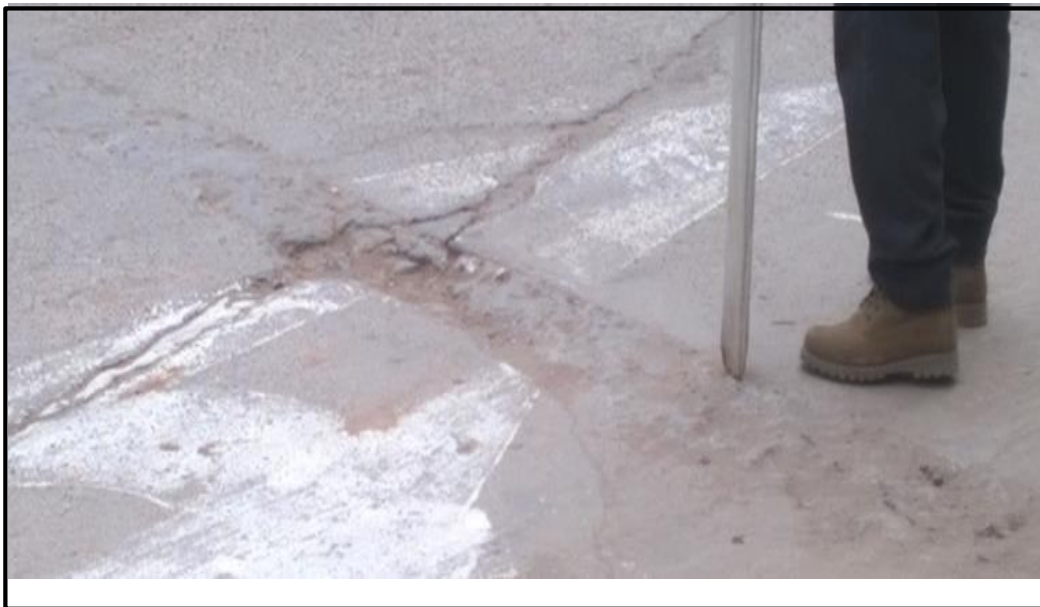
Figura 23: Punzonamiento de nivel de severidad media.
