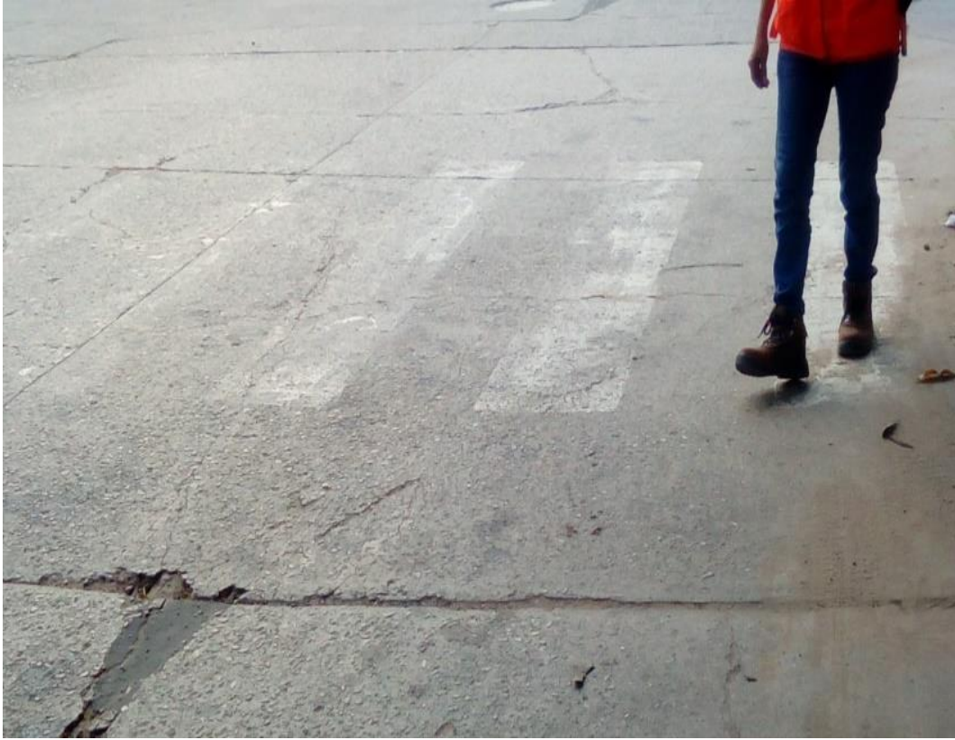
Figura 129: vista de daño de junta
