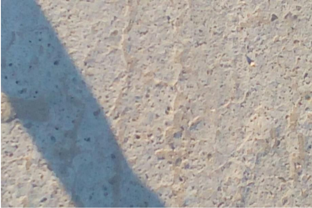
Figura 120: vista daño pulimiento de agregado:
