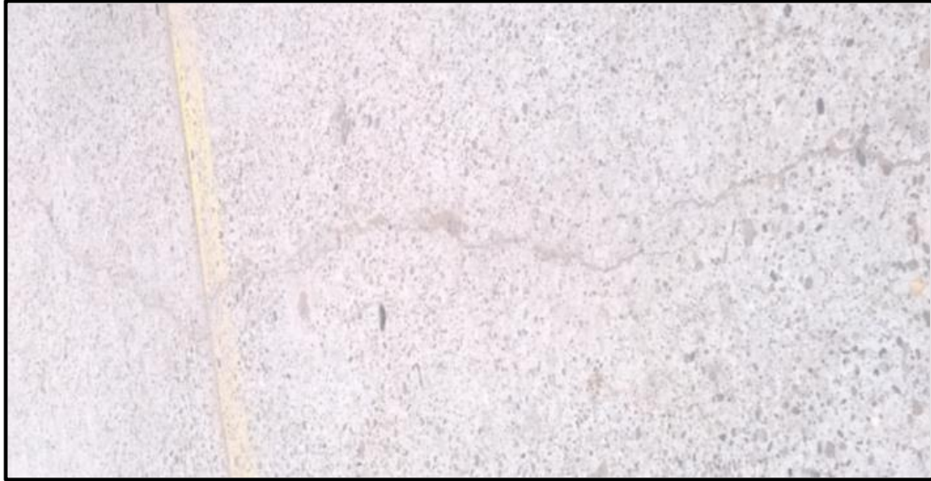
Figura 24: Grieta de retracción.
