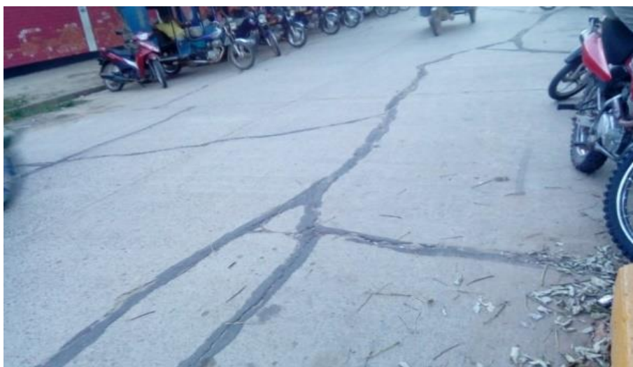
Figura 12: Losa dividida de nivel de severidad media.
