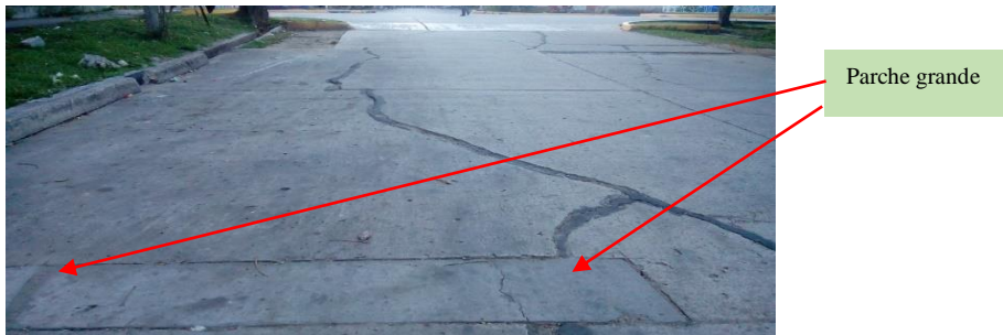
Figura 145: daño parche grande
