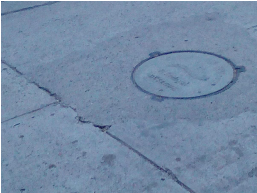
figura 136: daño de sellado de junta , parche grande
