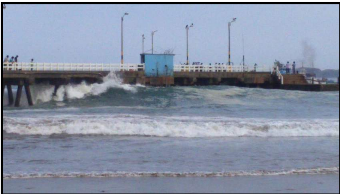
Gráfico 52: el oleaje del mar golpeando la estructura del muelle
