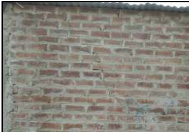
Gráfico 12: Agrietamiento en muro de albañilería.
