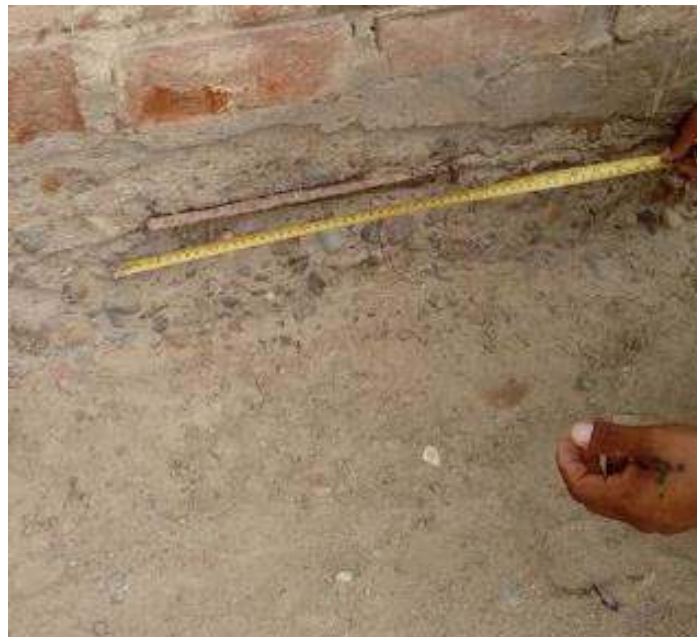
Gráfico 116: Oxidación y corrosión en el sobrecimiento.
