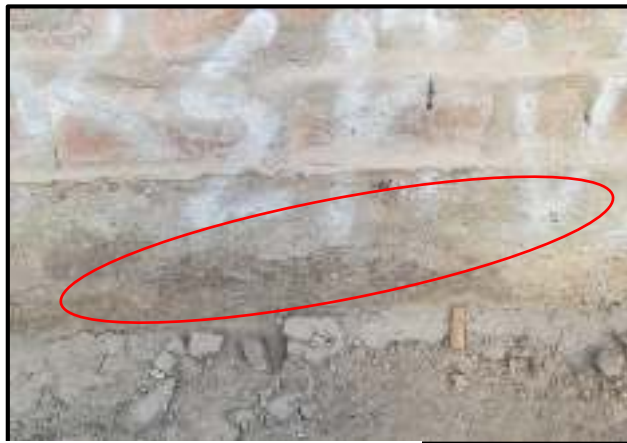
Gráfico 13: Fisura en sobrecimiento.
