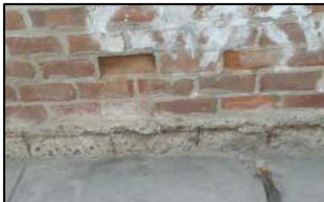
Gráfico 9: Corrosión en el acero del sobrecimiento.
