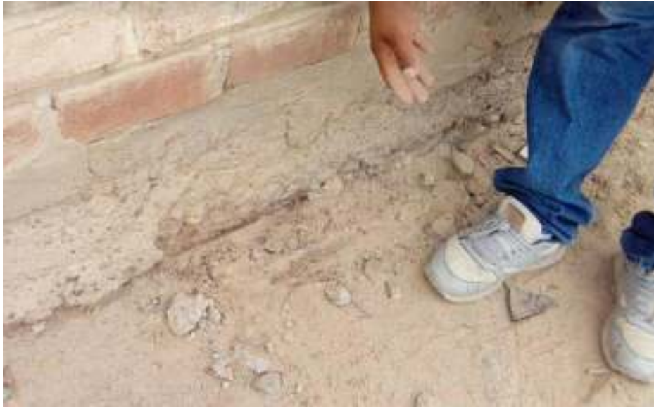
Gráfico 117: Humedad en el sobrecimiento y muro de albañilería.
