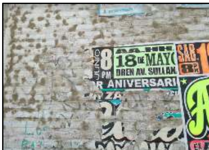
Gráfico 8: Suciedad en muro y columna de albañilería.
