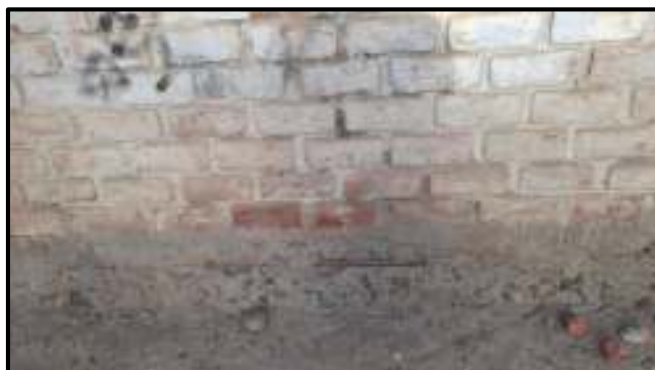
Gráfico 6: Erosión en sobrecimiento armado.
