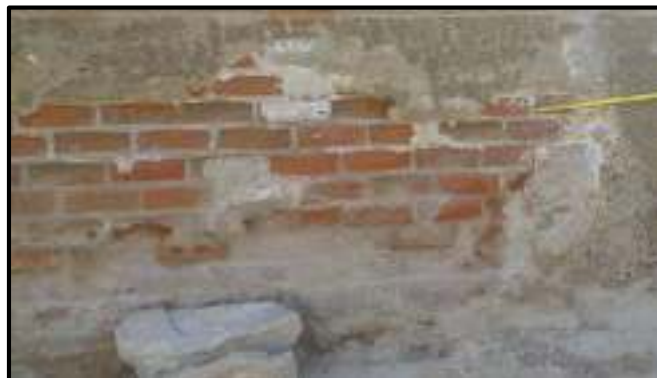
Gráfico 7: eflorescencia en muro de albañilería.
