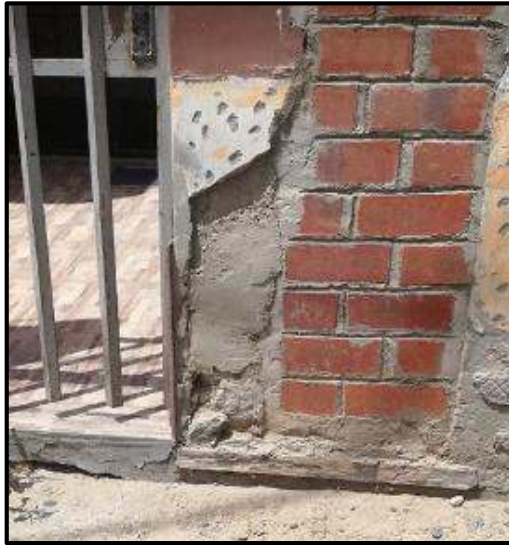
Gráfico 11: Desprendimiento en tarrajeo de columna.
