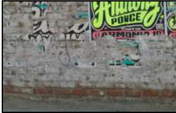
Gráfico 5: Humedad en muro de albañilería.
