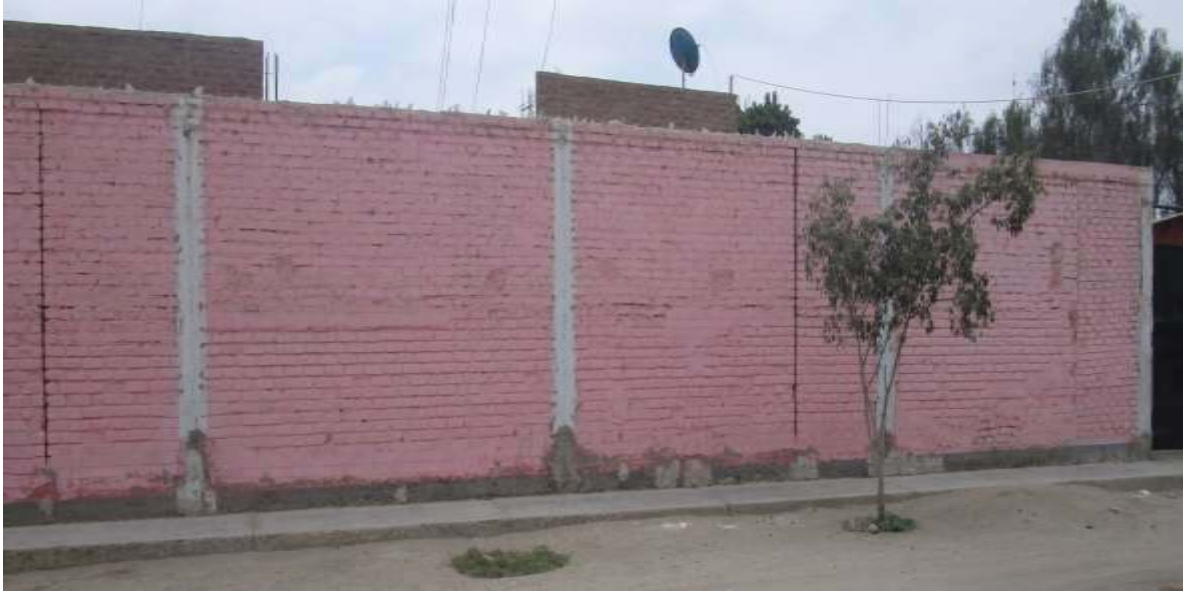
Fotografía 09: Vista panorámica de Unidad de Muestra N° 8 , se logra apreciar la presencia de corrosión, disgregamiento y eflorescencia
