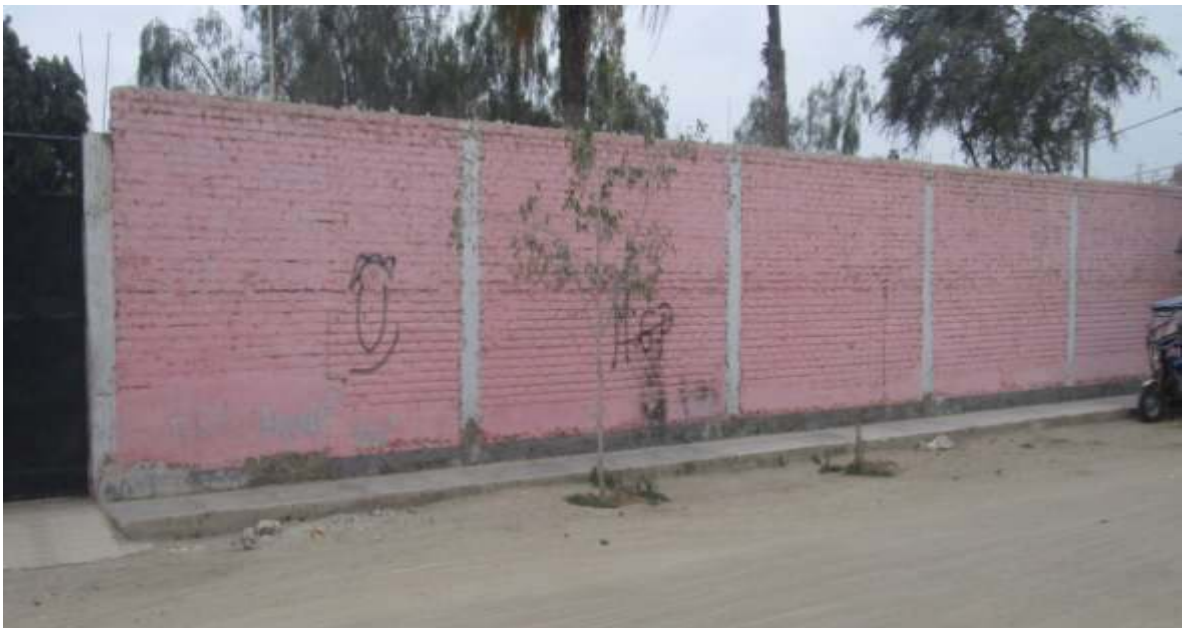
Fotografía 10: Vista panorámica de Unidad de Muestra N° 9 , se logra apreciar la presencia de corrosión, disgregamiento y eflorescencia
