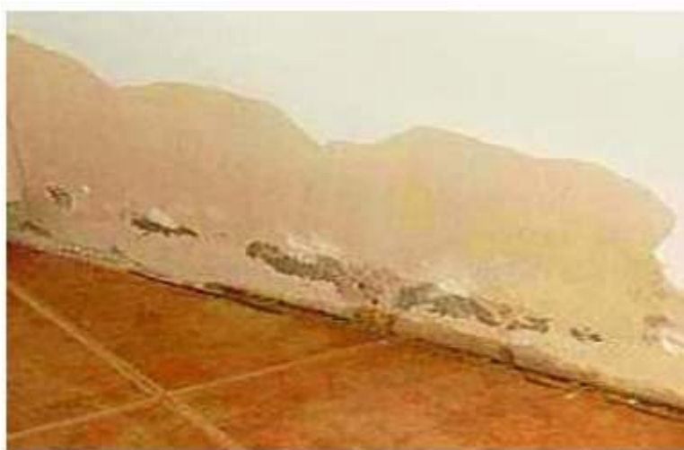
Gráfico 11: Humedad en paredes.
