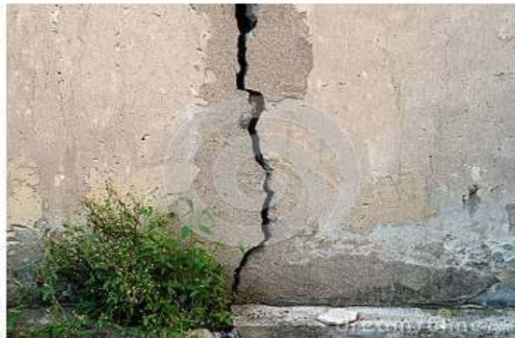
Gráfico 07. Grieta de muros
