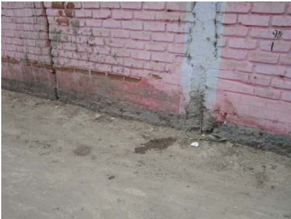
Fotografía 19: Presencia de eflorescencia y corrosión , en el muro y en la columna respectivamente del cerco perimétrico. Fuente ( I.E. MANUEL A. MESONES MURO)
