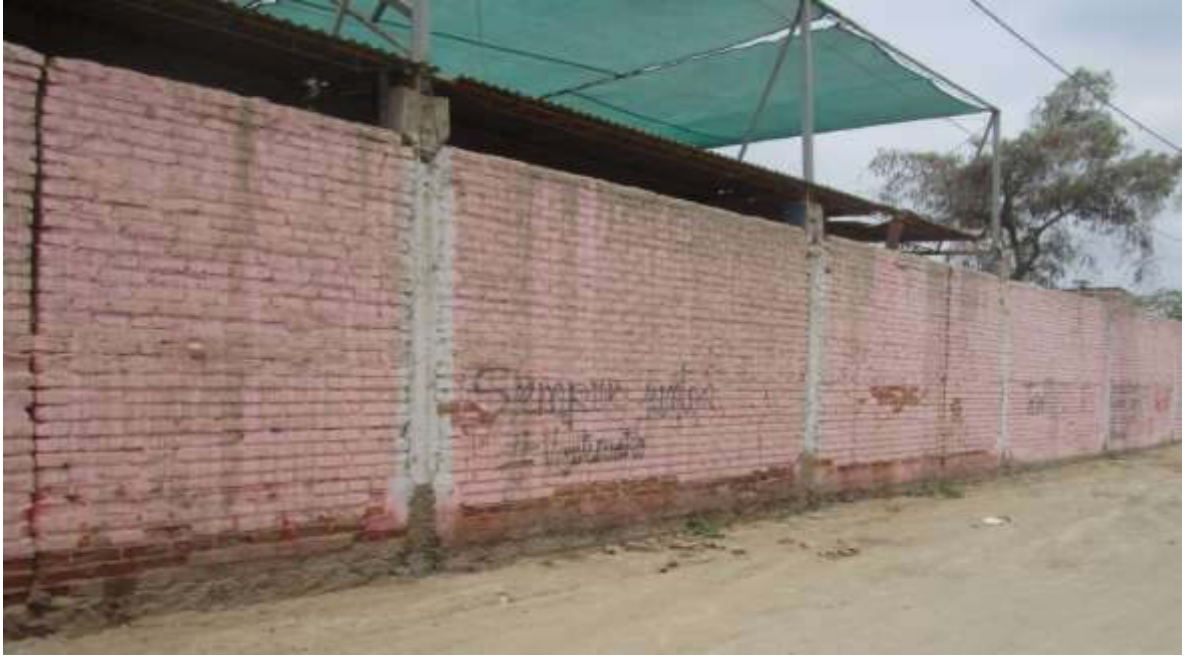
Fotografía 05: Vista panorámica de Unidad de Muestra N° 4, se logra apreciar la presencia de grietas, corrosión, disgregamiento y eflorescencia
