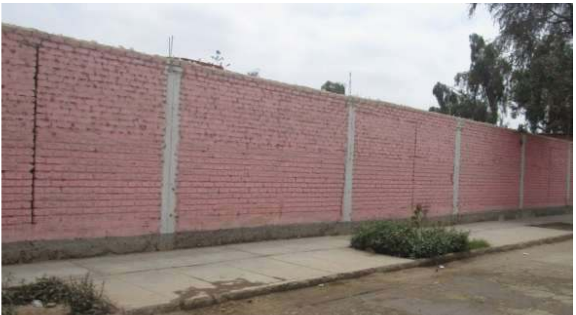
Fotografía 14: Vista panorámica de Unidad de Muestra N° 13, se logra apreciar la presencia de grieta, picadura y eflorescencia Fuente ( I.E. MANUEL A. MESONES MURO)
