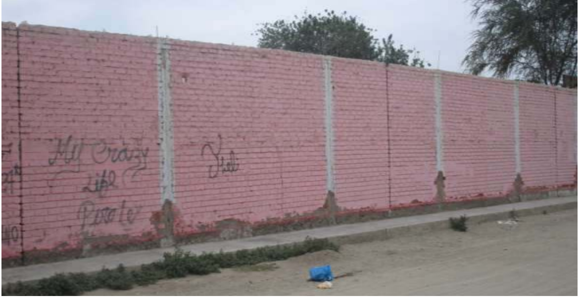
Fotografía 07: Vista panorámica de Unidad de Muestra N° 6, se logra apreciar la presencia de grietas, corrosión, disgregamiento y eflorescencia
