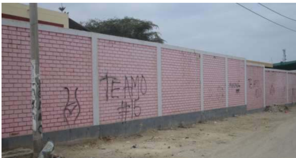
Fotografía 02: Vista panorámica de Unidades de Muestra N°1, se logra apreciar la presencia de grietas, corrosión y eflorescencia
