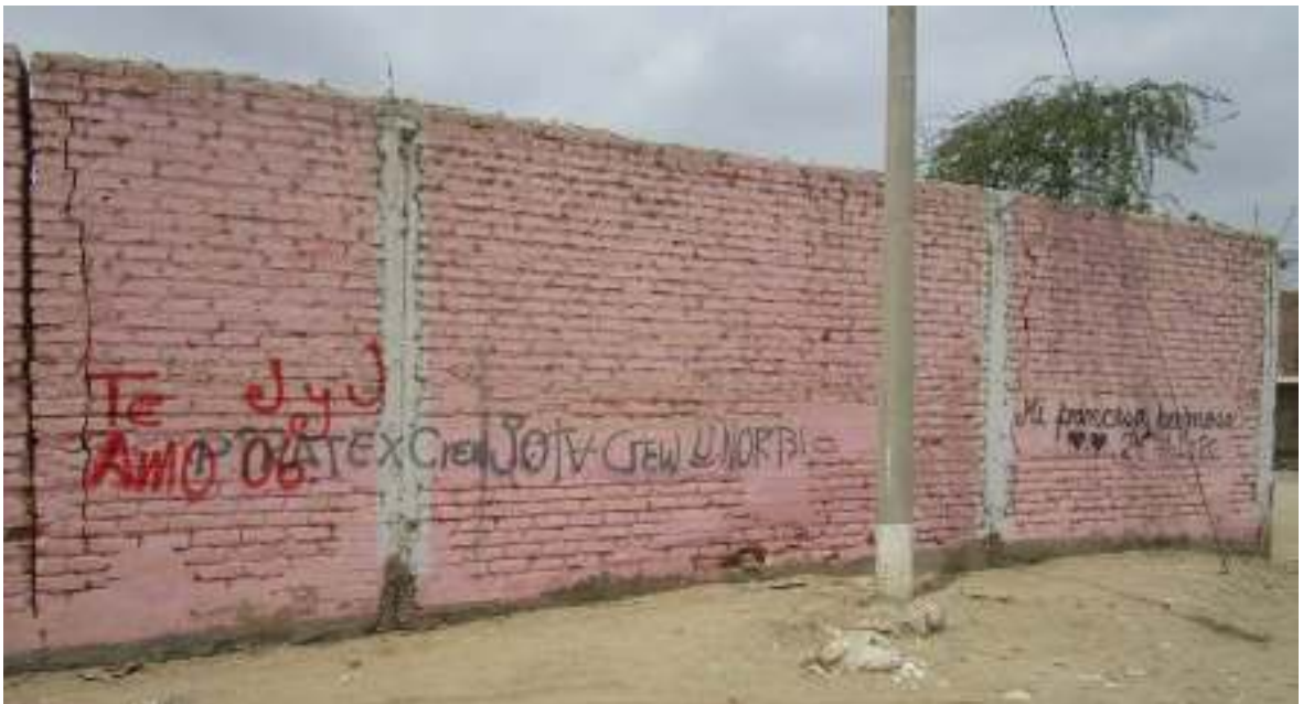
Fotografía 06: Vista panorámica de Unidad de Muestra N° 5, se logra apreciar la presencia de grietas, corrosión, disgregamiento y eflorescencia
