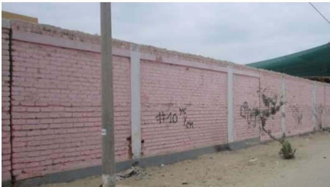
Fotografía 03: Vista panorámica de Unidad de Muestra N° 2, se logra apreciar la presencia de grietas , corrosión , disgregamiento y eflorescencia
