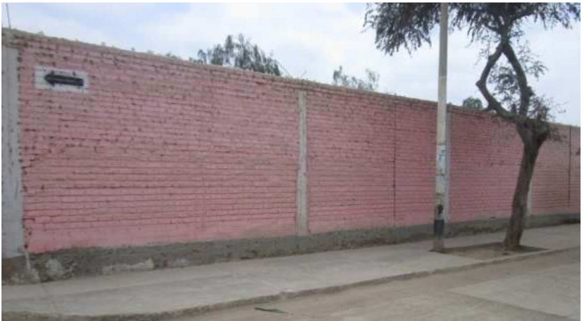
Fotografía 12: Vista panorámica de Unidad de Muestra N° 11, se logra apreciar la presencia de grieta, disgregamiento y eflorescencia Fuente ( I.E. MANUEL A. MESONES MURO)
