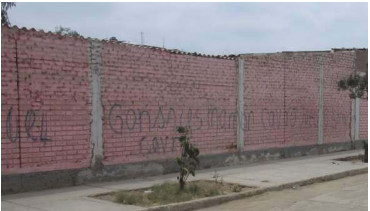
Fotografía 16: Vista panorámica de Unidad de Muestra N° 15, se logra apreciar la presencia de picadura y eflorescencia Fuente (I.E. MANUEL A. MESONES MURO)
