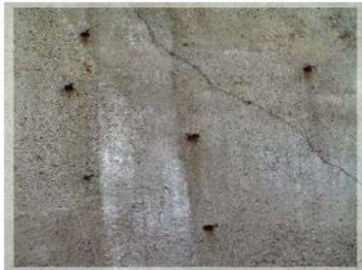
Gráfico 10. Imagen de fisuras
