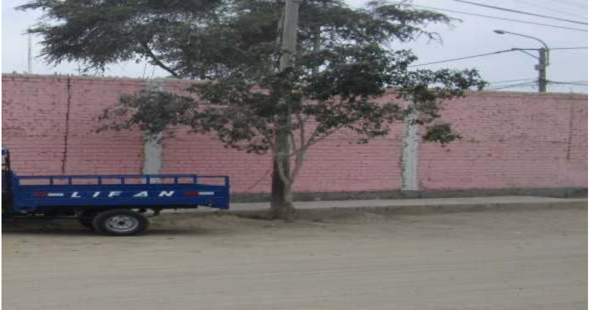
Fotografía 11: Vista panorámica de Unidad de Muestra N° 10, se logra apreciar la presencia de grieta, disgregamiento y eflorescencia Fuente ( I.E. MANUEL A. MESONES MURO)
