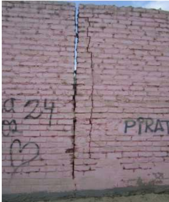
Fotografía 19: Presencia de grieta en muro del cerco perimétrico. Fuente ( I.E. MANUEL A. MESONES MURO)
