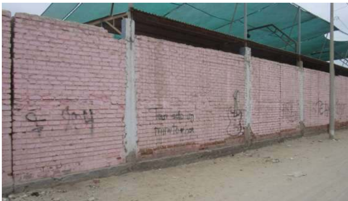
Fotografía 04: Vista panorámica de Unidad de Muestra N° 3, se logra apreciar la presencia de grietas, corrosión, disgregamiento y eflorescencia
