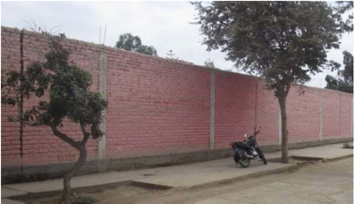
Fotografía 13: Vista panorámica de Unidad de Muestra N° 12, se logra apreciar la presencia de grieta, picadura y eflorescencia Fuente ( I.E. MANUEL A. MESONES MURO)
