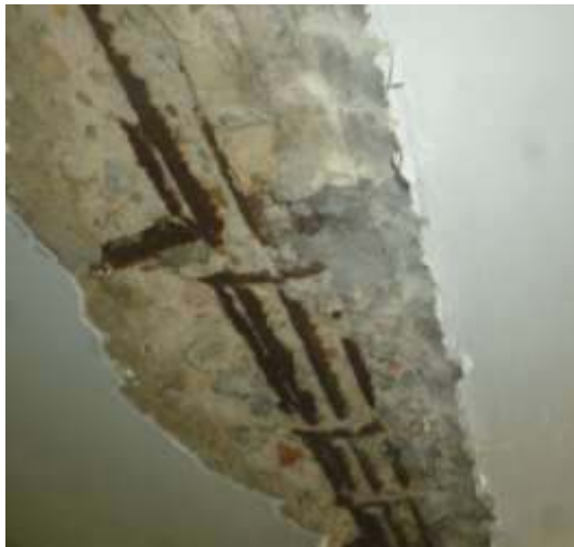
Gráfico 12. Corrosión en columna
