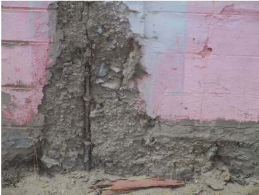
Fotografía 17: Presencia de Corrosión en columna del cerco perimétrico. Fuente ( I.E. MANUEL A. MESONES MURO)
