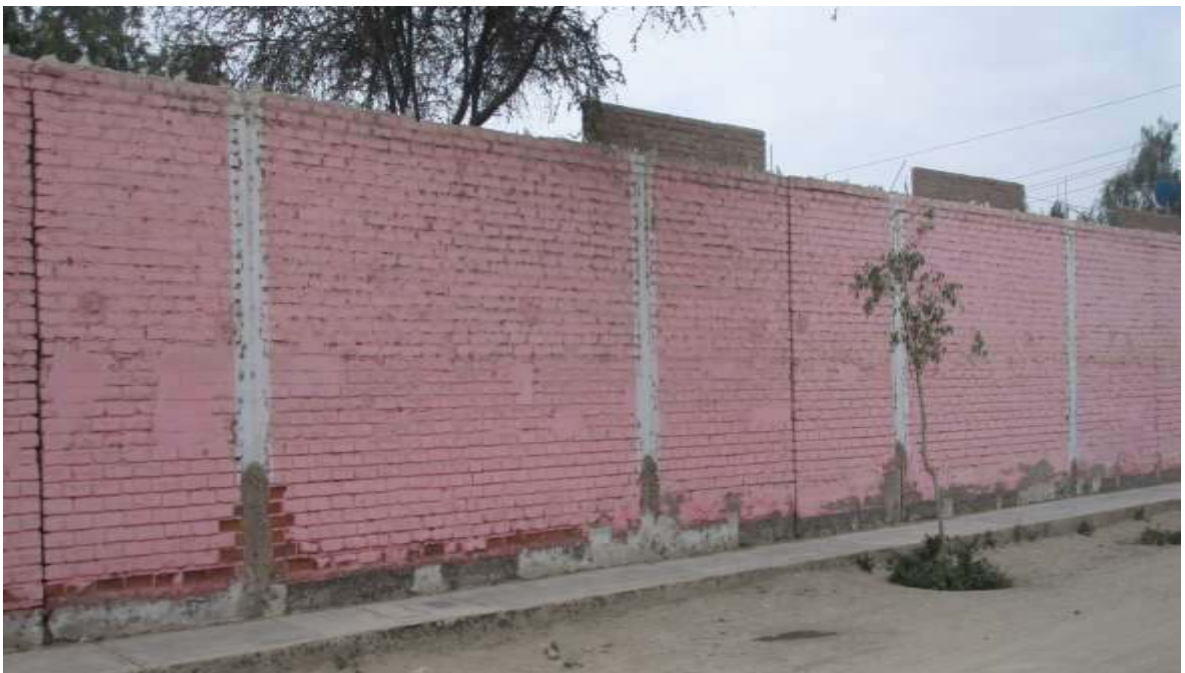
Fotografía 08: Vista panorámica de Unidad de Muestra N° 7, se logra apreciar la presencia de corrosión, disgregamiento y eflorescencia
