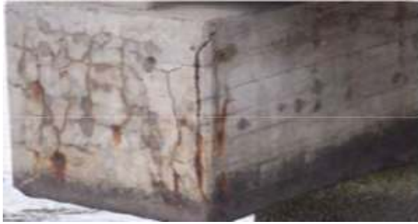
Gráfico 09. Picadura en el concreto.
