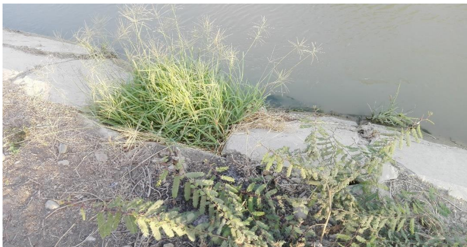
Gráfico 3: Hundimiento en estructura de concreto.
