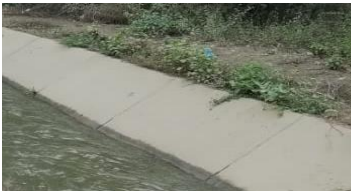
Gráfico 86: Presencia de eflorescencia en la parte lateral del canal.
