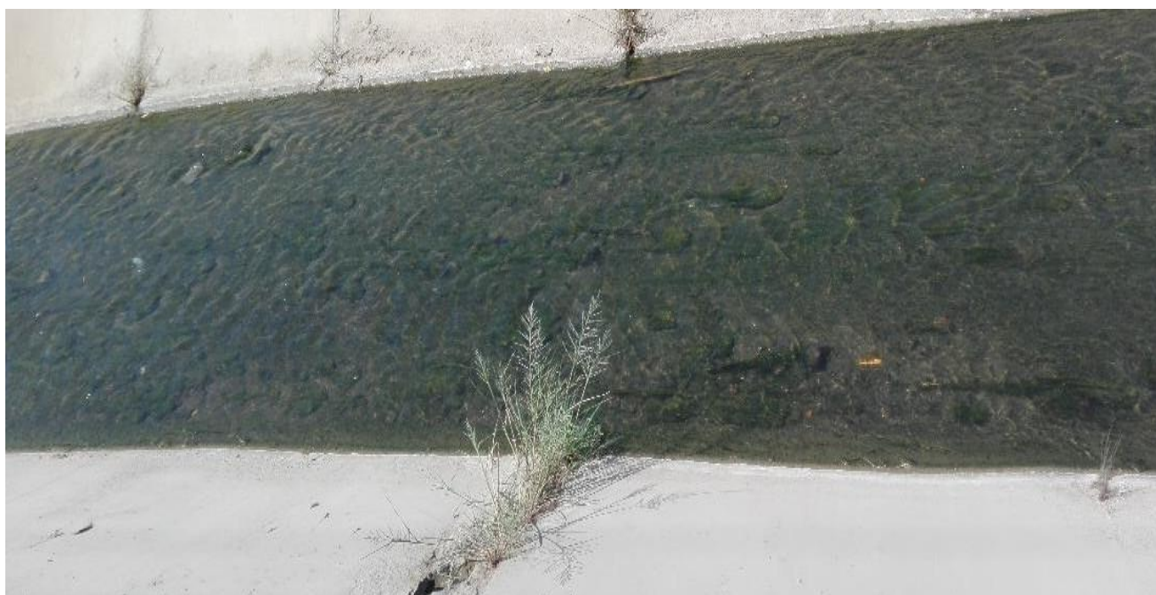
Gráfico 88: Presencia de sedimentación en la parte lateral del canal.
