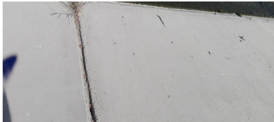
Gráfico 7: Sello de Juntas en estructura de concreto.
