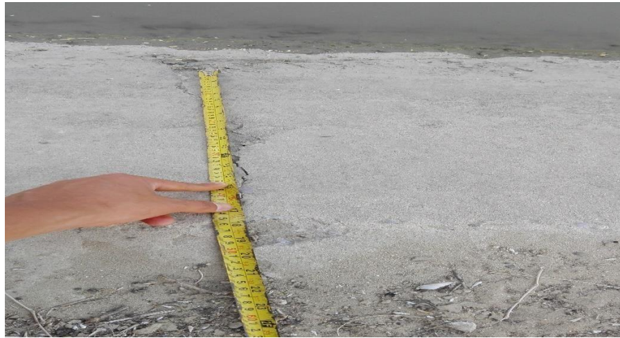
Gráfico 1: Fisura en estructura de concreto.
