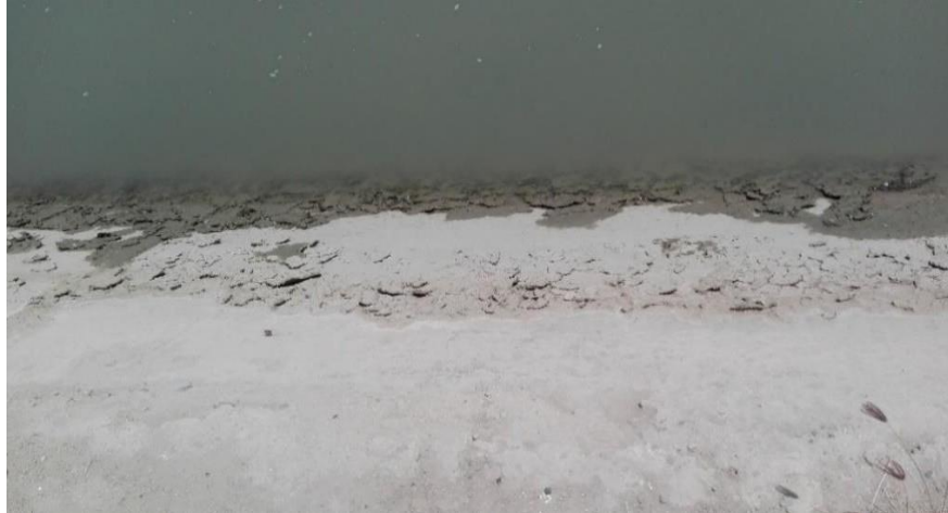
Gráfico 9: Descascaramiento en estructura de concreto.
