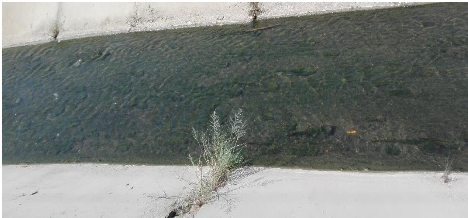
Gráfico 4: Erosión en estructura de concreto.
