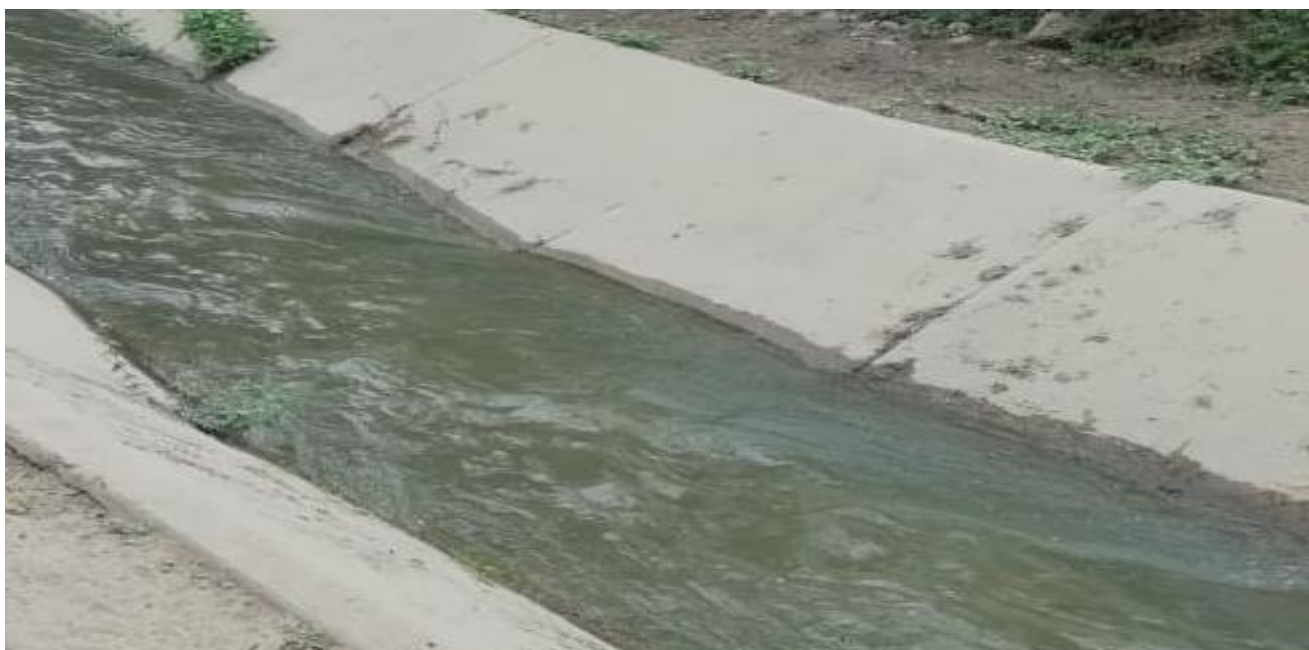
Gráfico 87: Presencia de sedimentación en la parte lateral del canal.
