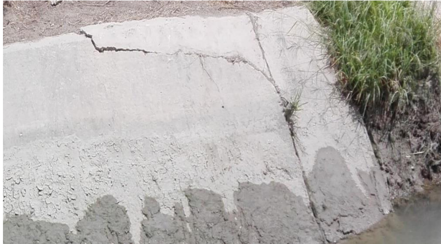
Gráfico 2: Grieta en estructura de concreto.
