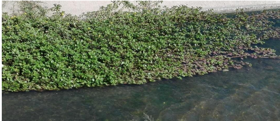
Gráfico 6: Vegetación en estructura de concreto.
