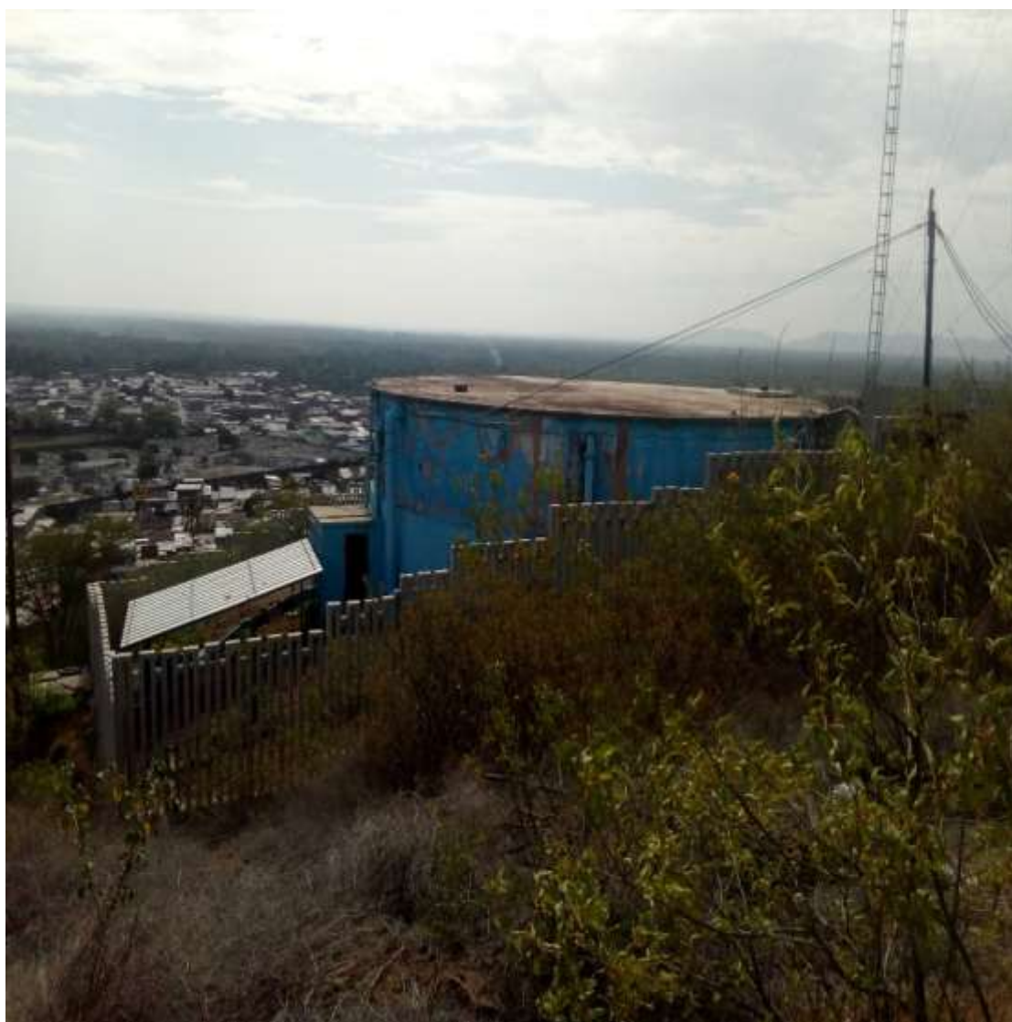
Figura 34: Vista Panorámica del Reservorio Apoyado R1
