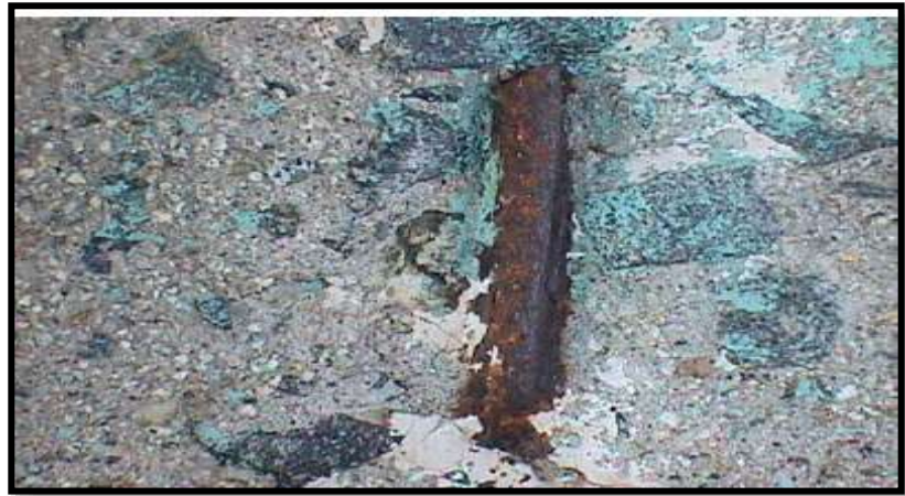
Figura 27: Daño Ataques por Sulfatos
