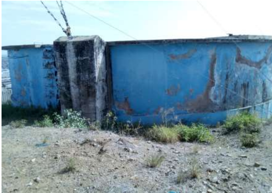
Figura 35: Identificación de Patologías del Reservorio Apoyado R1
