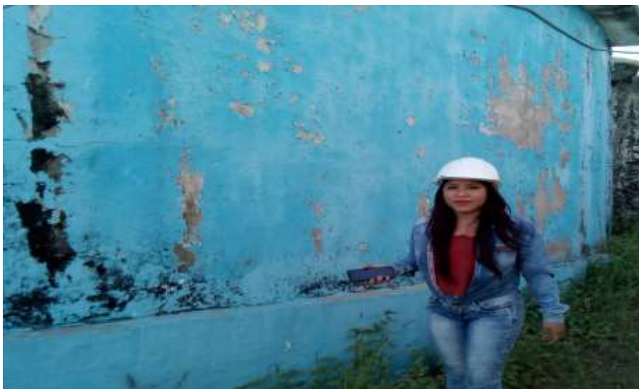
Figura 36: Identificación de Patologías del Reservorio Apoyado R1
