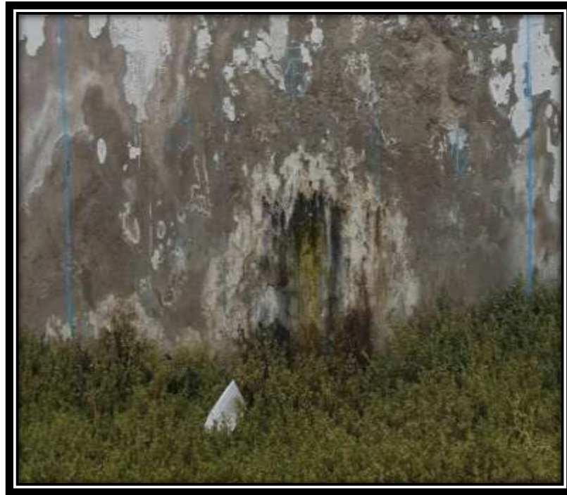
Figura1: Se Aprecia en la Muestra las Patologías de Eflorescencia y Erosión
