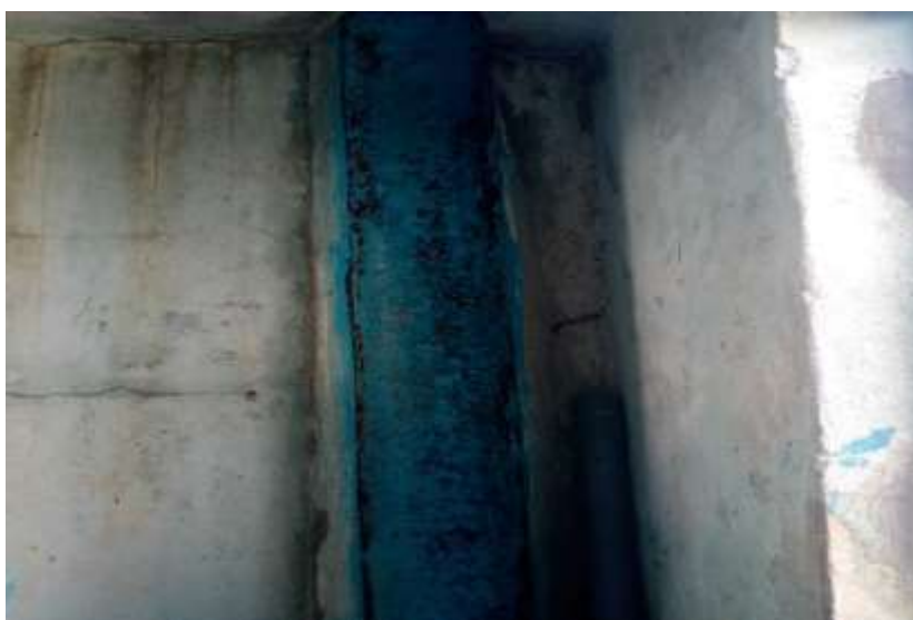
Figura 17: Grietas por asentamiento – Reservoirio Apoyado R1
