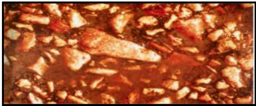
Figura 25: Daño por Cavitación
