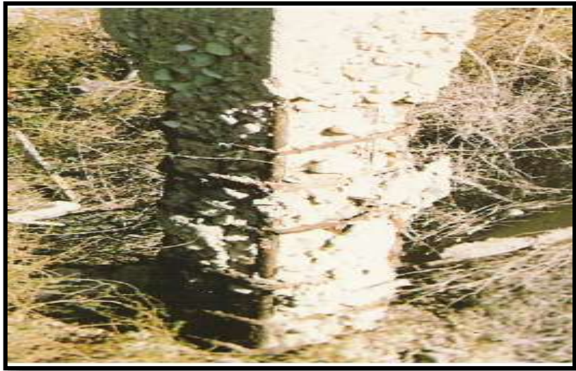
Figura 26: Daño Ataques de Ácidos
