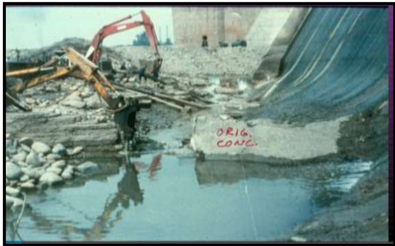
Figura 24: Daño por Abrasión
