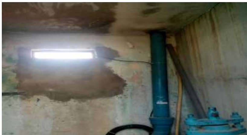
Figura 23: Filtración – Reservorio Apoyado R1
