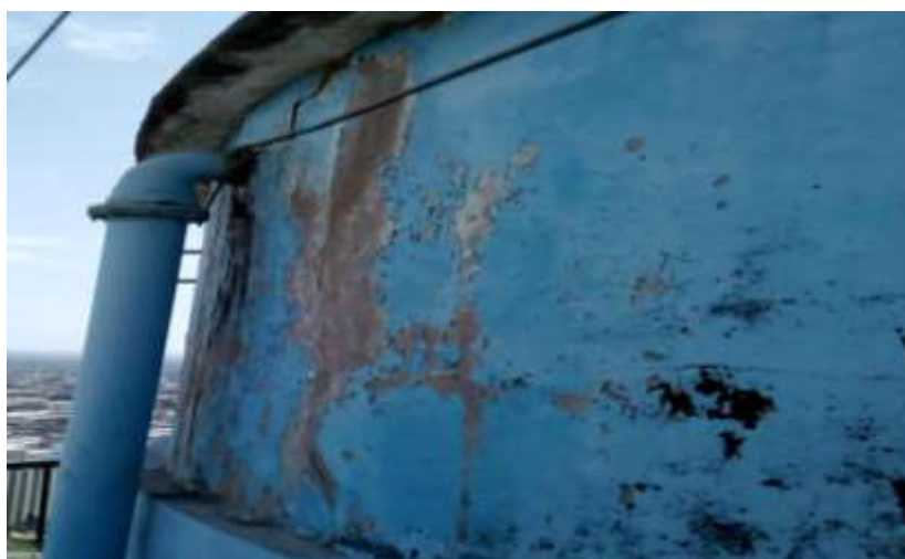
Figura 18: Fisuras– Reservoirio apoyado R1
