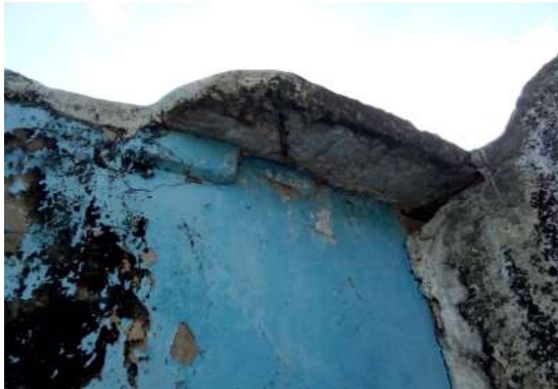
Figura 19: Deterioro – Reservorio Apoyado R1
