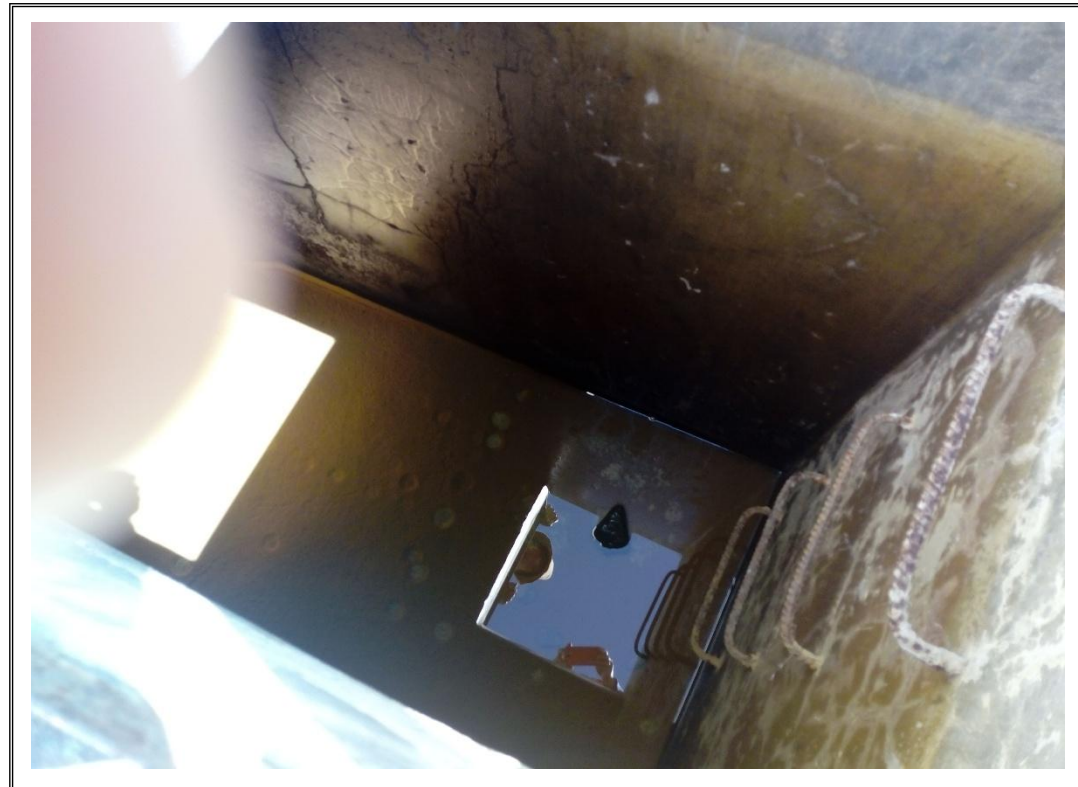
Fotografía N° 08: Parte interna del Reservorio deteriorada. Sin mantenimiento
