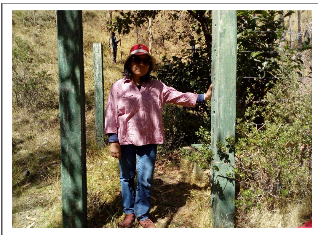
Fotografía N° 04: Cerco de seguridad de la captación sin mallas de puas.
