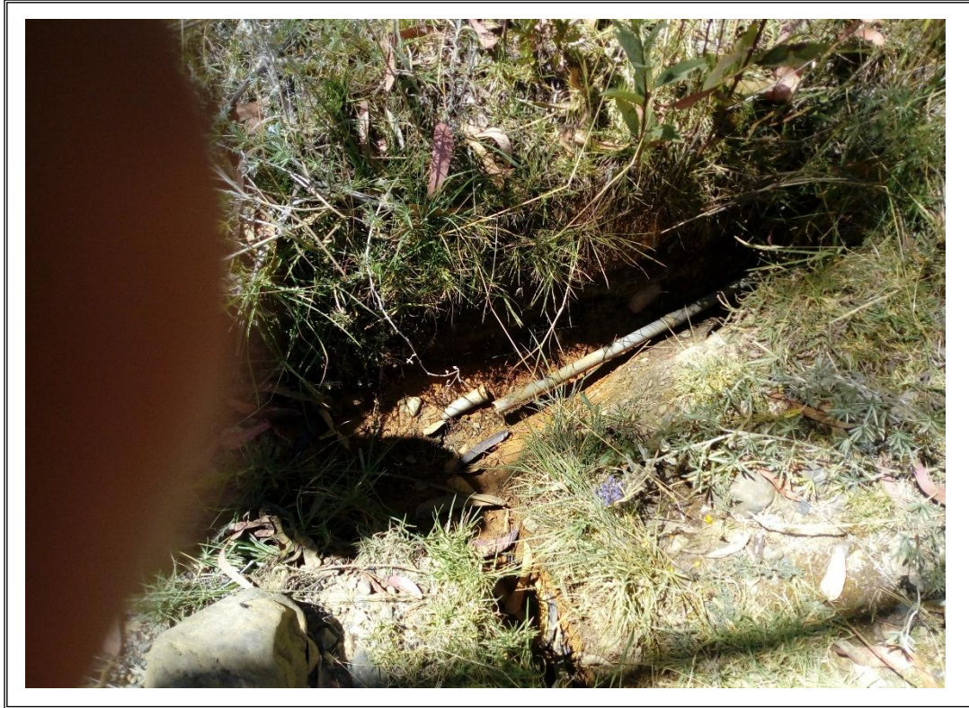
Fotografía N° 05; Líneas de conducción rotos en ciertos tramos.
