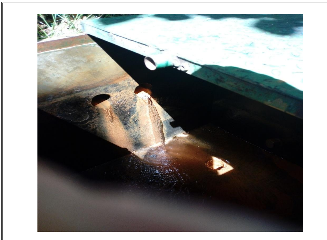
Fotografía N° 03; Estado Actual de Caja de Captación de Agua oxidado.
