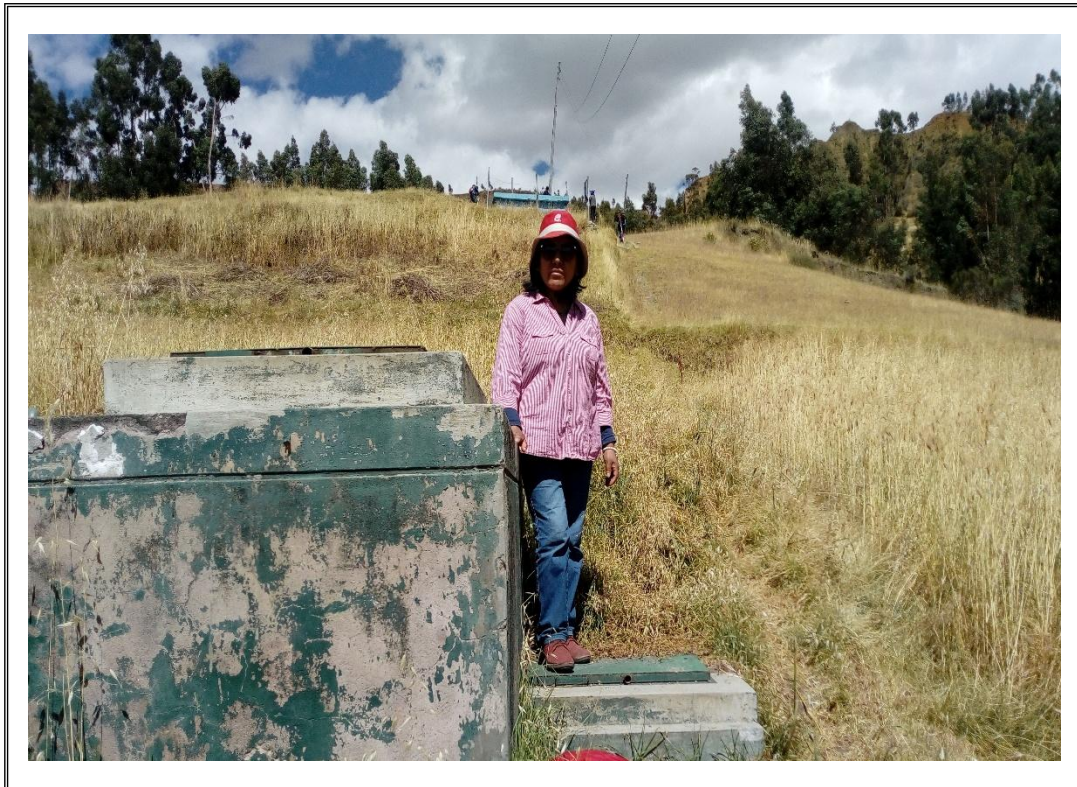
Fotografía N° 06: Reservorio sin mantenimiento.. Dteteriorado por el paso del tiempo
