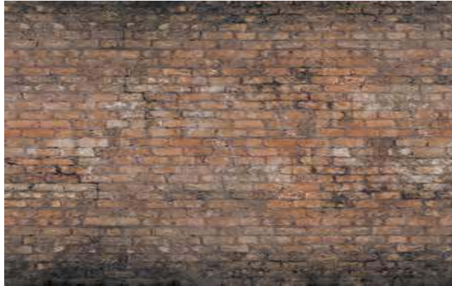
Figura 9: Suciedad en Muro de Ladrillo
