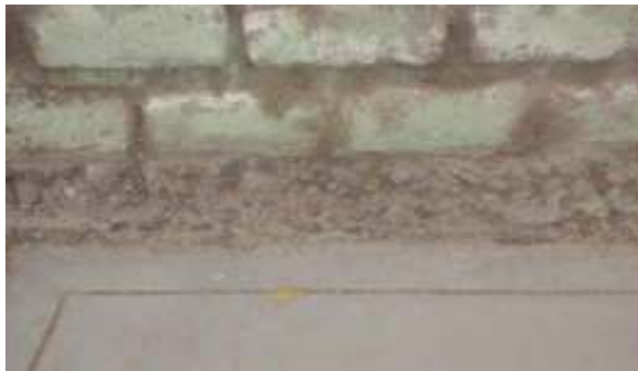
Figura 10: Erosión en Sobrecimiento
