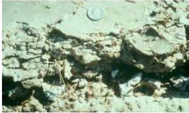
Figura 6: Desintegración del Concreto
