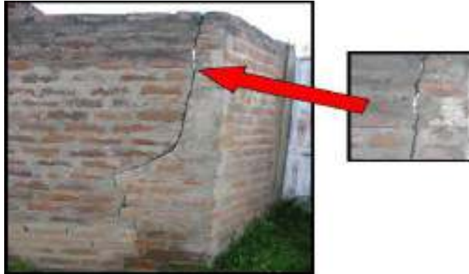
Figura 3: Grieta en Muro de Ladrillo
