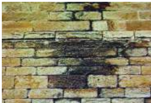
Figura 8: Manchas en Muro de Ladrillo
