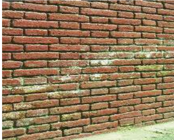
Figura 7: Eflorescencia en Ladrillo
