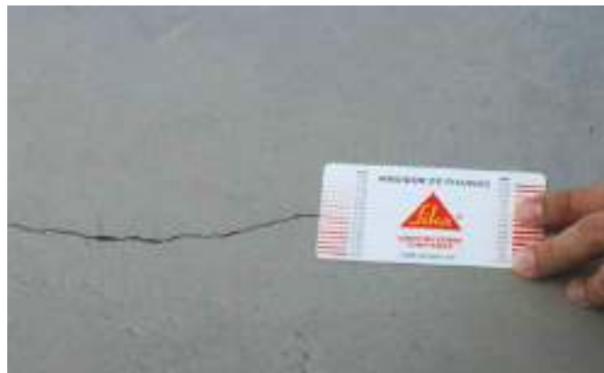
Figura 4: Fisura en Pared
