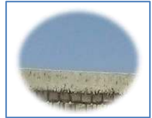
Fotografía 07: presencia de patología suciedad
