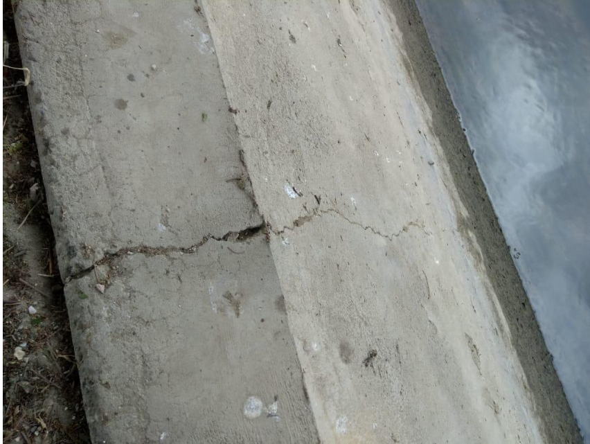
Gráfico 72. Agrietamiento del concreto en el canal
