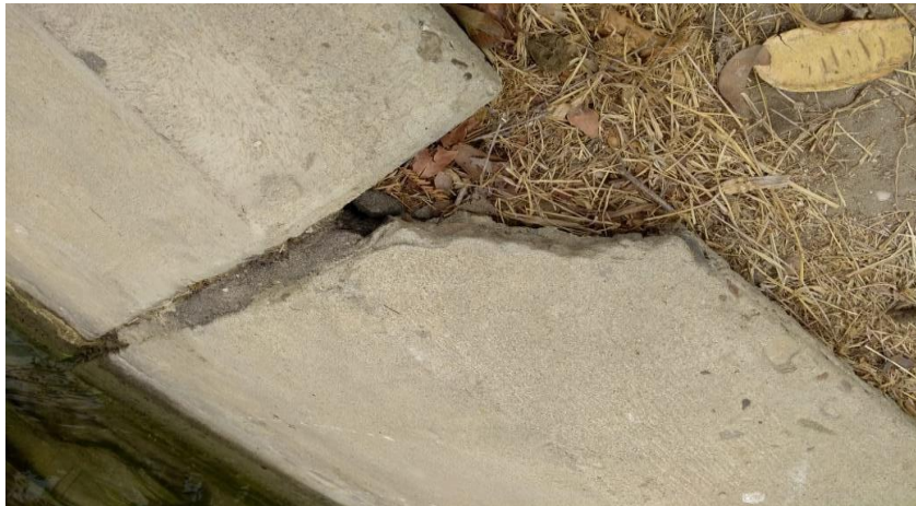
Gráfico 9. Desprendimiento en concreto
