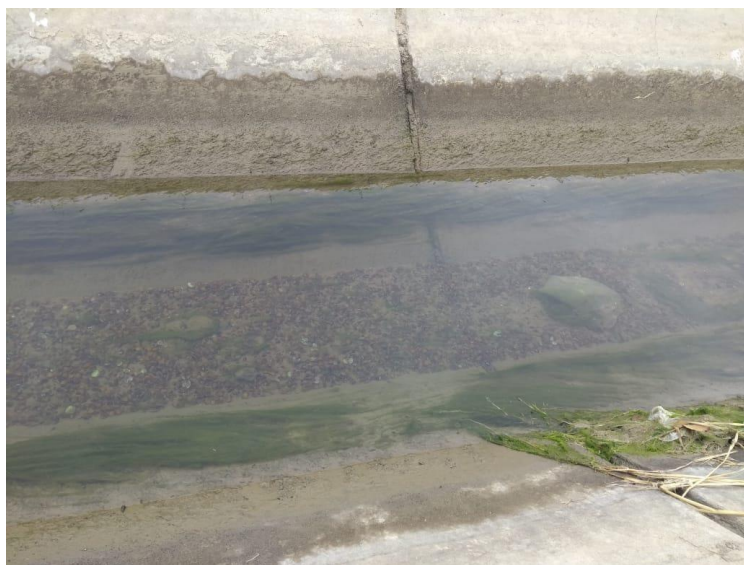
Gráfico 8. Erosión en fondo del canal de concreto
