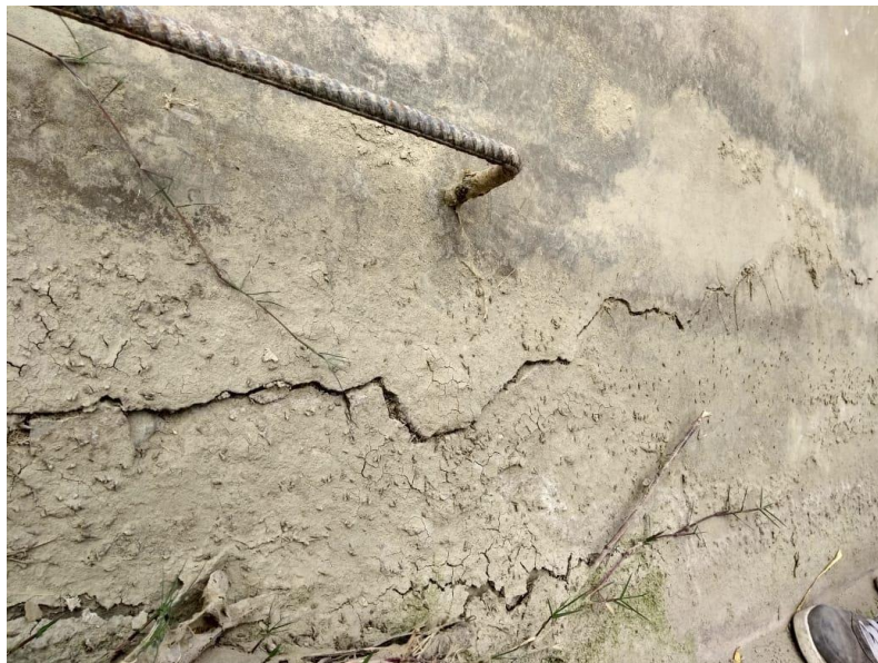
Gráfico 11. Grieta en estructura de canal
