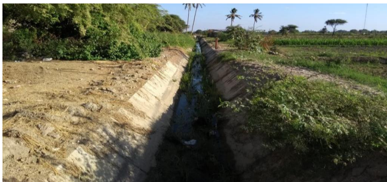
Gráfico 12. Vegetación en canal de concreto
