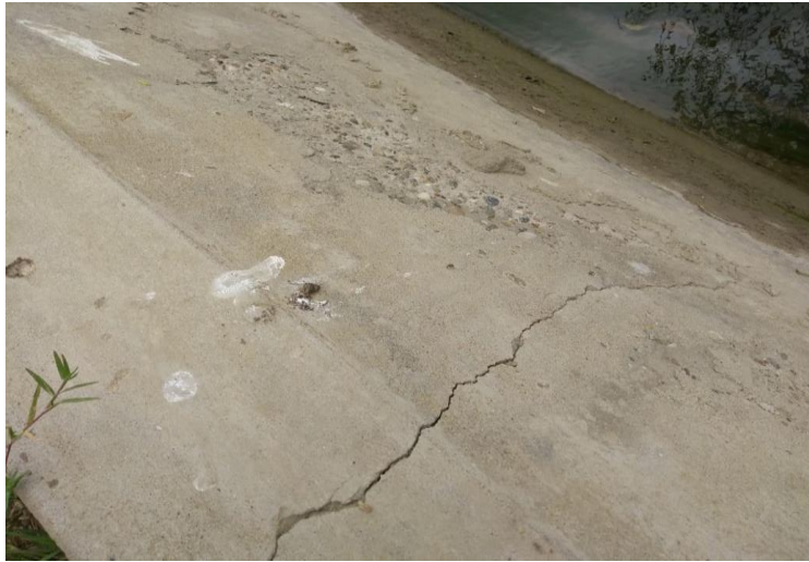
Gráfico 10. Fisuración en losa lateral de canal
