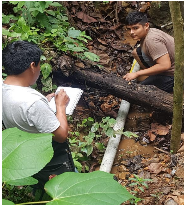
Figura 22: Línea de conducción sin protección al intemperie
