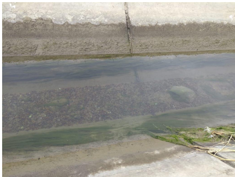
Gráfico 8: Erosión en fondo del canal de concreto.
