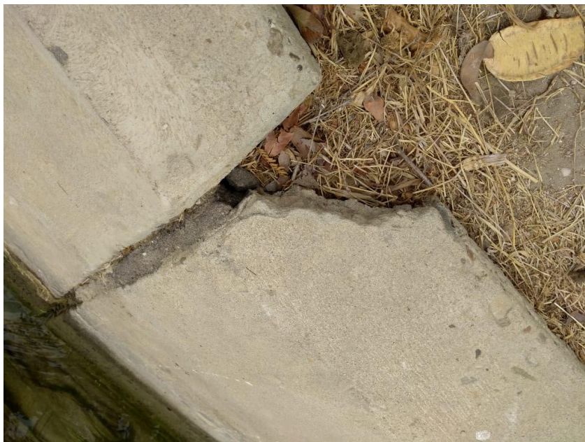
Gráfico 9: Desprendimiento en concreto.
