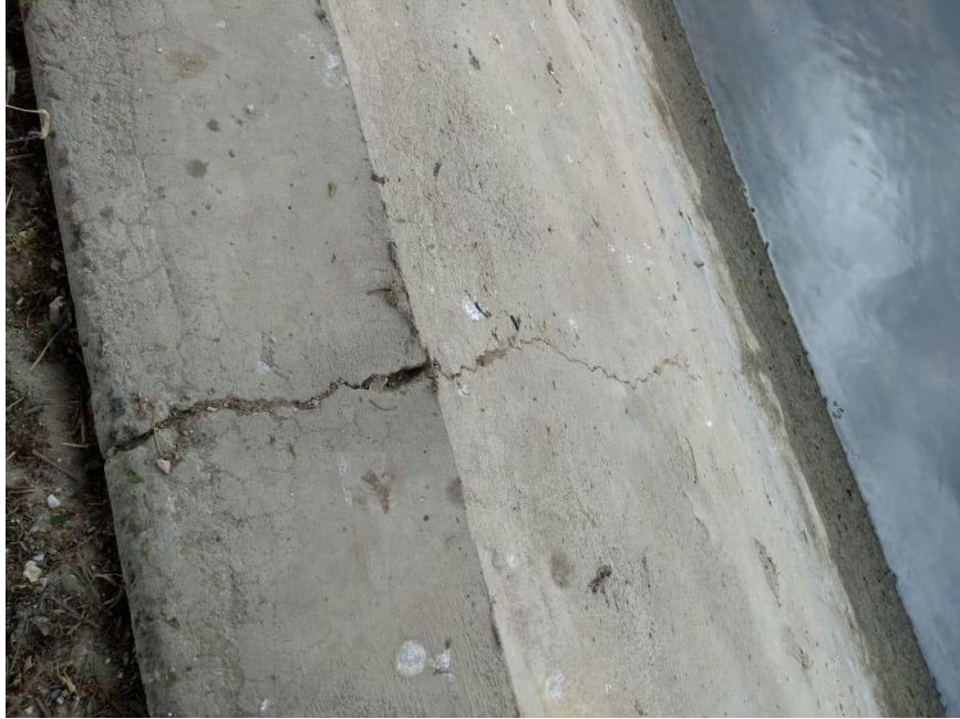
Gráfico 89: Agrietamiento del concreto en el canal
