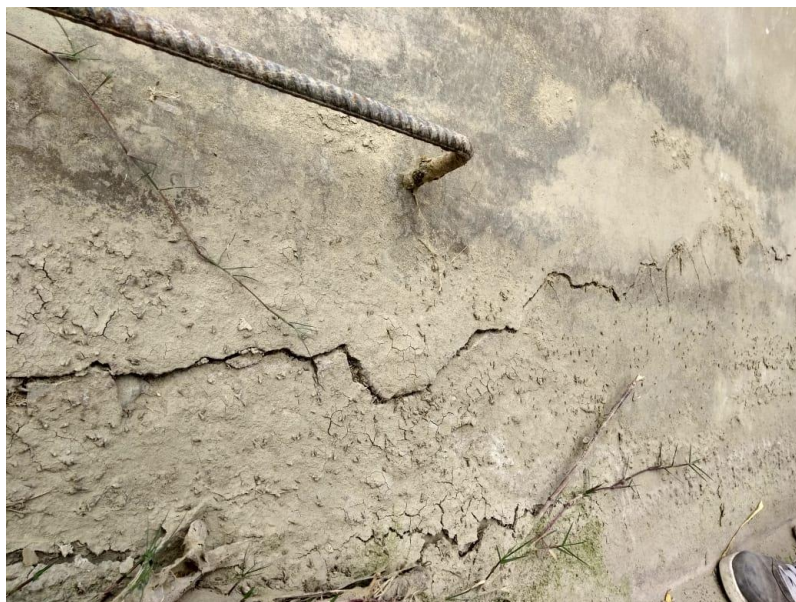
Gráfico 11: Grieta en estructura de canal.
