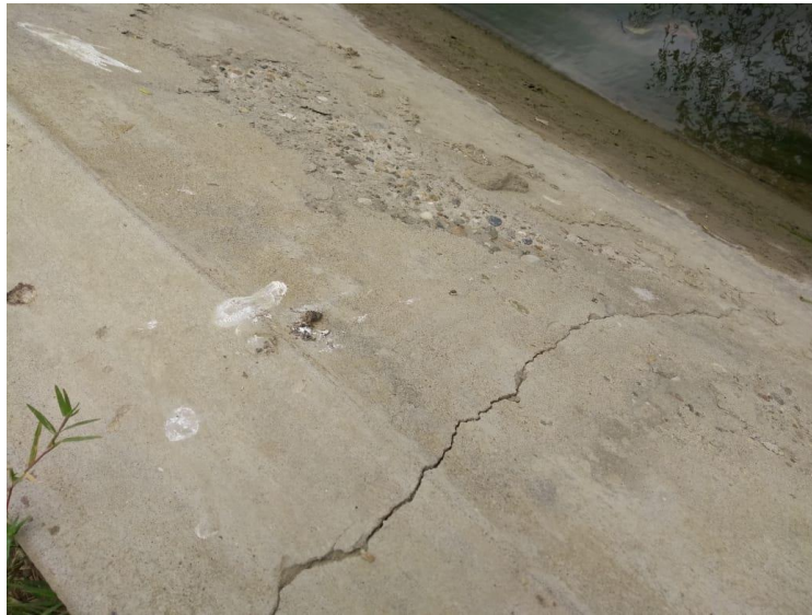
Gráfico 10: Fisuración en losa lateral de canal.
