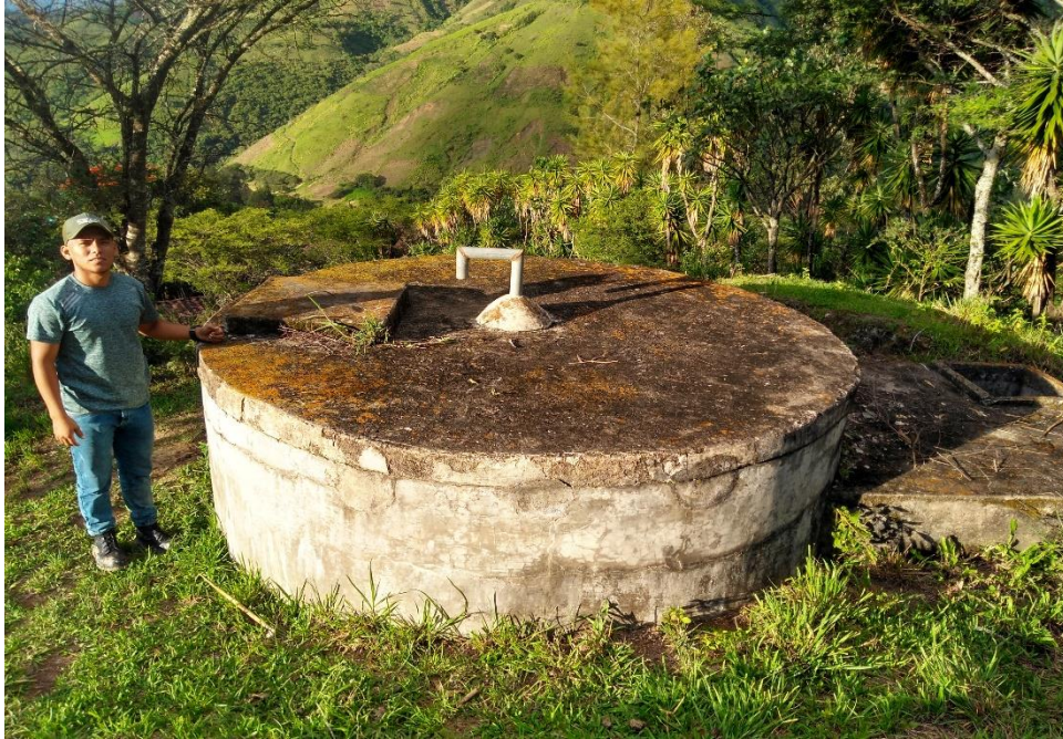
ANEXO 3. Reservorio apoyado de 5m 3 que se encuentra en buen estado de funcionamiento y conservación.
