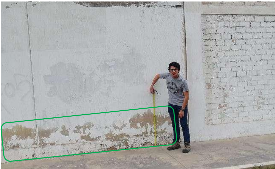
Fotografía 14: Muro de albañilería y sobrecimiento afectados por la patología eflorescencia en la unidad muestral 19.
