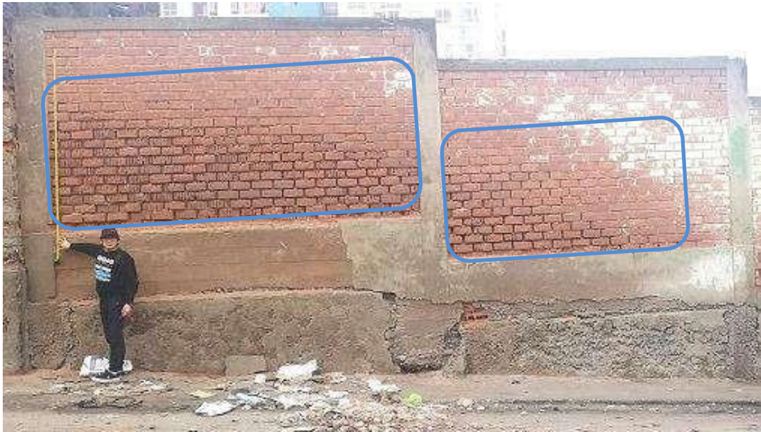
Fotografía 4: Muro de albañilería afectado por la patología erosión física en la unidad muestral 07.
