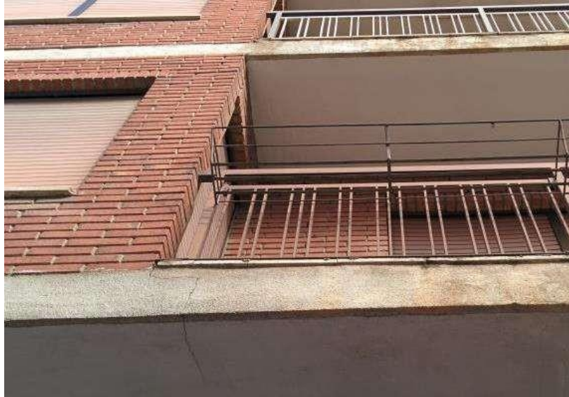
Gráfico 22: Patología fisuras en techo de edificación. Nota. Fuente: Caroca H. (2012).
