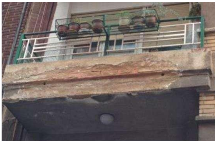
Gráfico 24: Patología desprendimiento en edificación.
