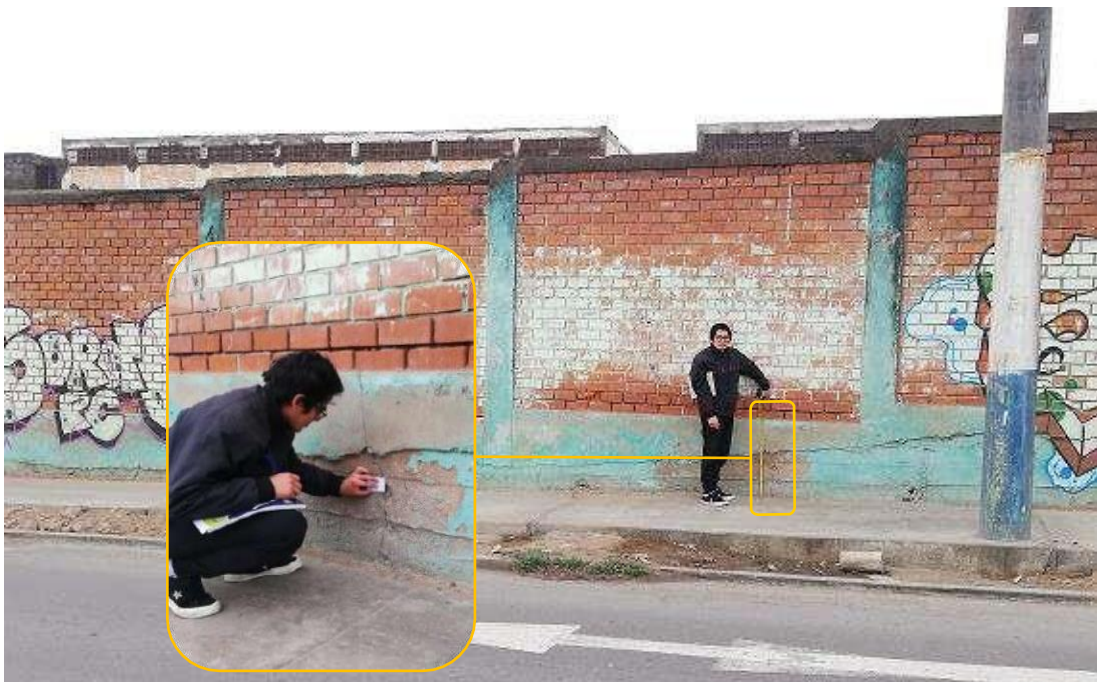
Fotografía 7: Sobrecimiento afectado por la patología grietas en la unidad muestral 14, la cual afectó todo el alto del elemento y tuvo un espesor de 2.5 mm.
