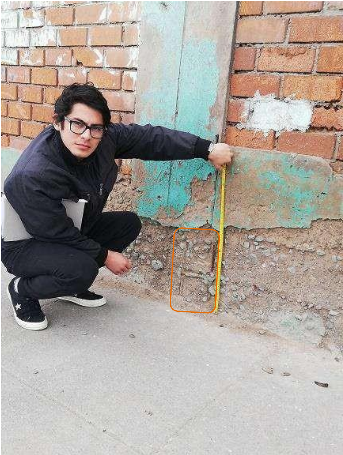
Fotografía 13: Columna afectada por la patología corrosión encontrada en la unidad muestral 15.
