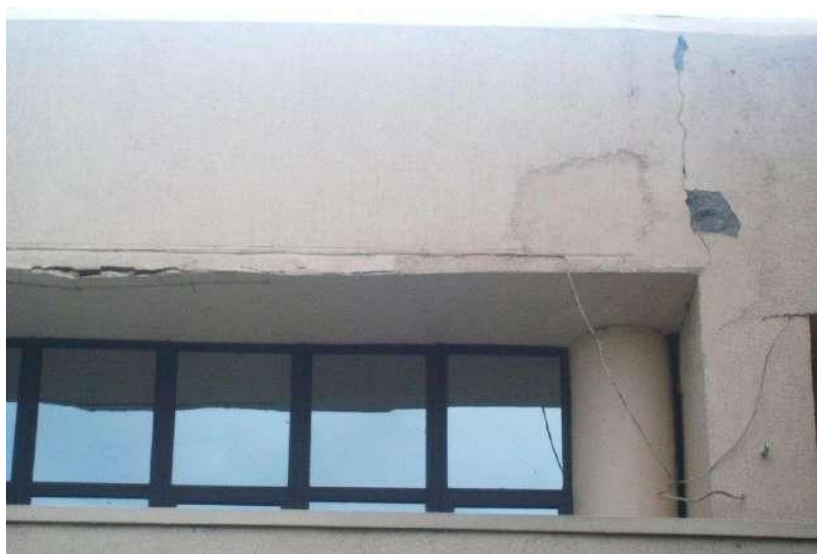
Gráfico 20: Patología grietas en elementos de concreto armado. Nota. Fuente: Caroca H. (2012).
