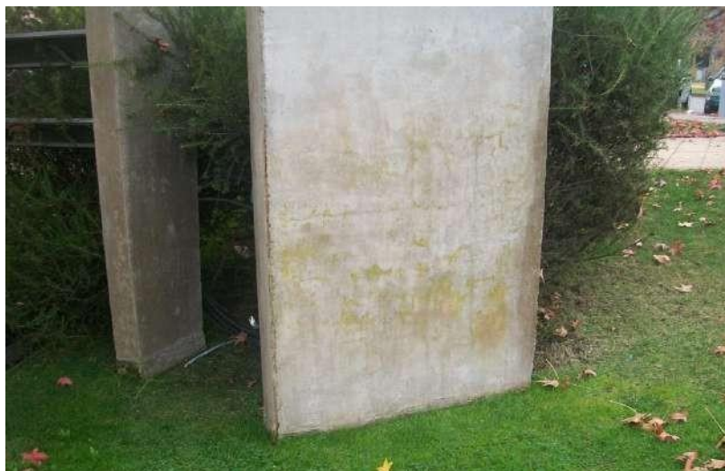
Gráfico 26: Patología eflorescencia en elementos de concreto. Nota Fuente: Caroca H. (2012).
