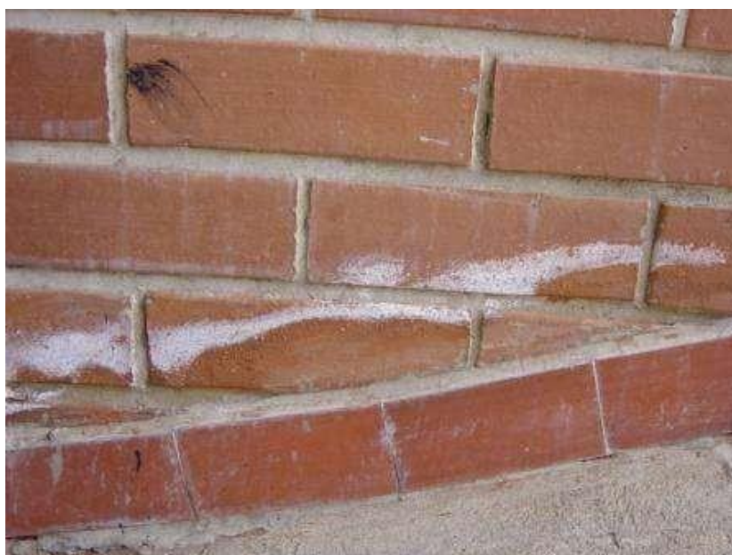
Gráfico 27: Patología eflorescencia en muros. Nota Fuente: Rojas J. (2005).
