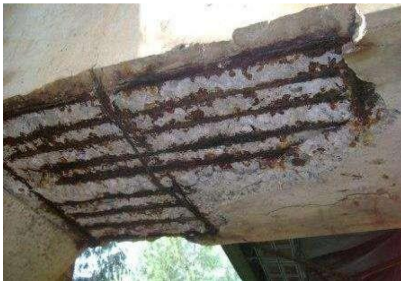
Gráfico 25: Patología oxidación y corrosión del acero de refuerzo.
