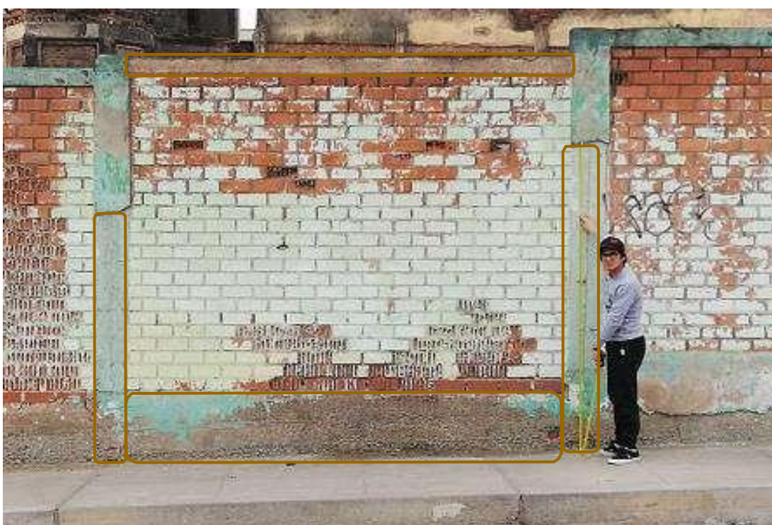
Fotografía 11: Columnas, vigas y sobrecimientos afectados por la patología desprendimiento en la unidad muestral 11.
