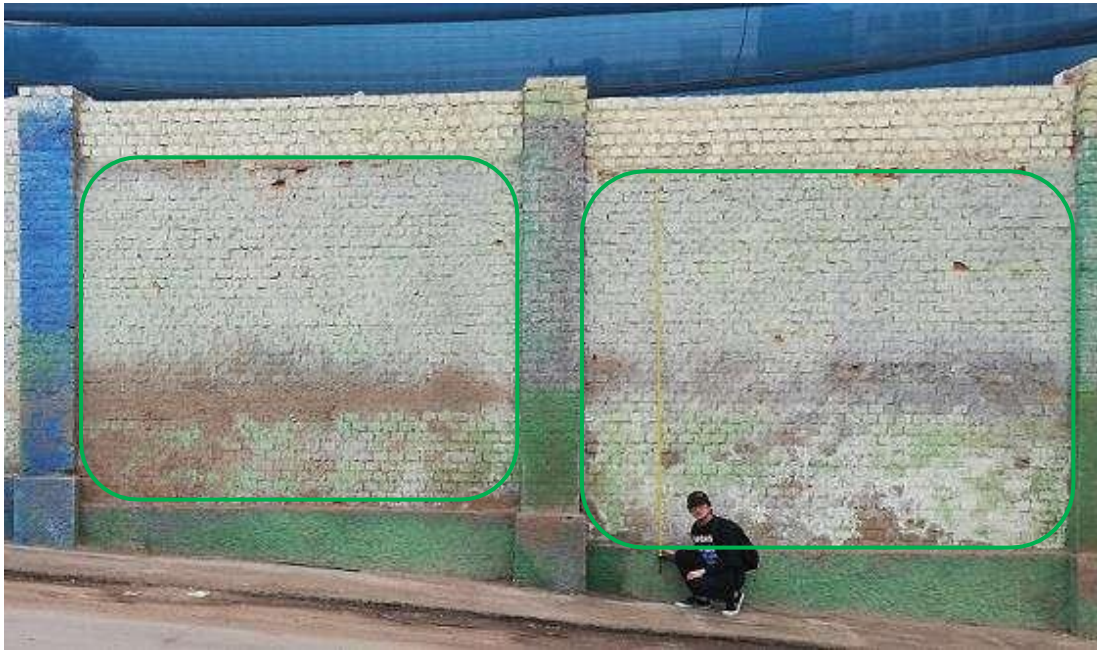
Fotografía 13: Muros de albañilería afectados por la patología eflorescencia en la unidad muestral 03.
