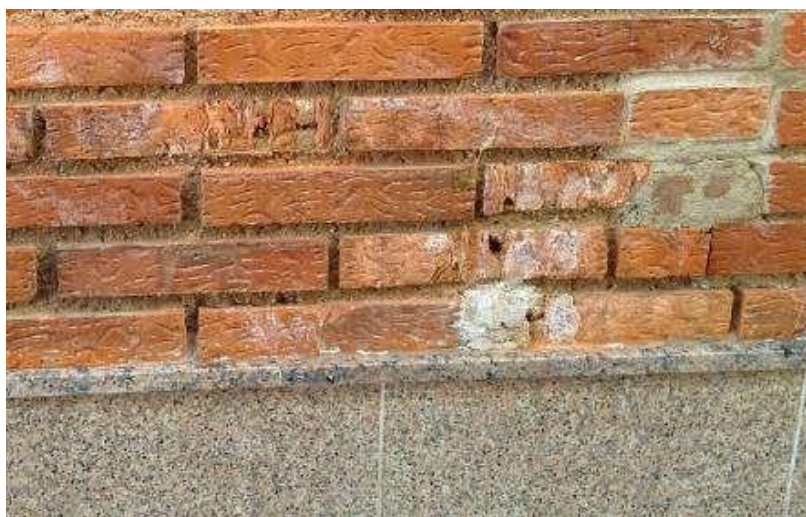
Gráfico 18: Patología erosión física en muros de albañilería.
