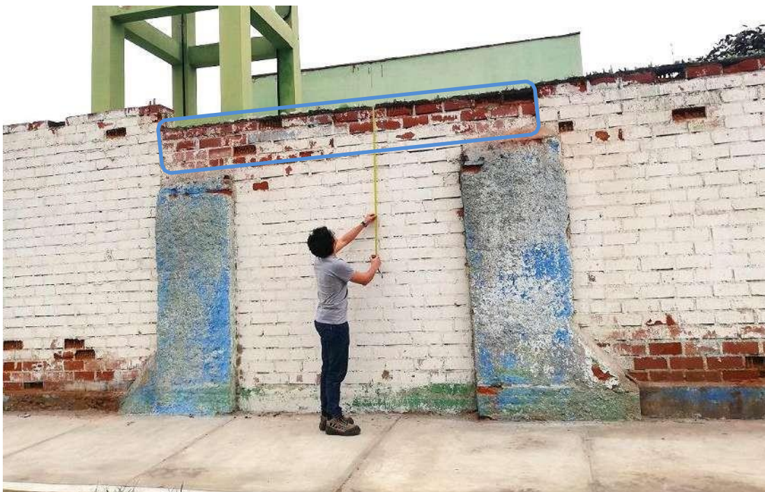
Fotografía 5: Muro de albañilería afectado por la patología erosión física en la unidad muestral 24.
