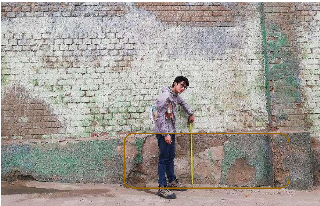
Fotografía 10: Sobrecimiento afectado por la patología desprendimiento encontrada en la unidad muestral 04.
