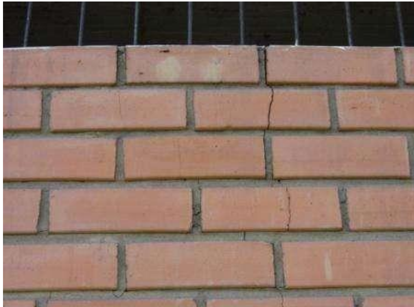
Gráfico 21: Patología grietas en muro de albañilería.
