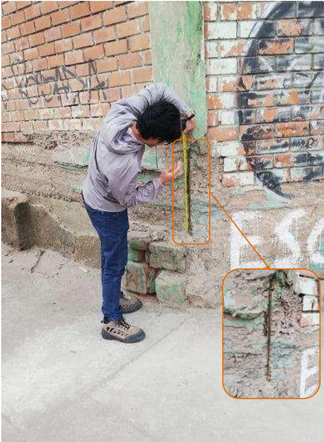
Fotografía 12: Columna afectada por la patología corrosión en la unidad muestral 07.
