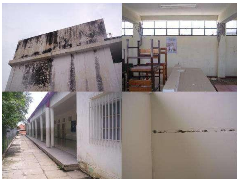
Gráfico 16: Patologías en las edificaciones.
