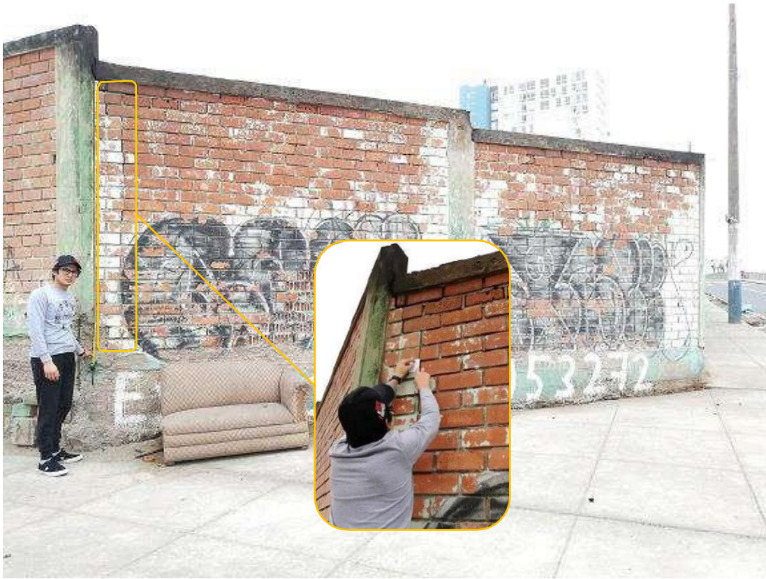
Fotografía 6: Viga y muro de albañilería afectado por la patología grietas en la unidad muestral 08.
