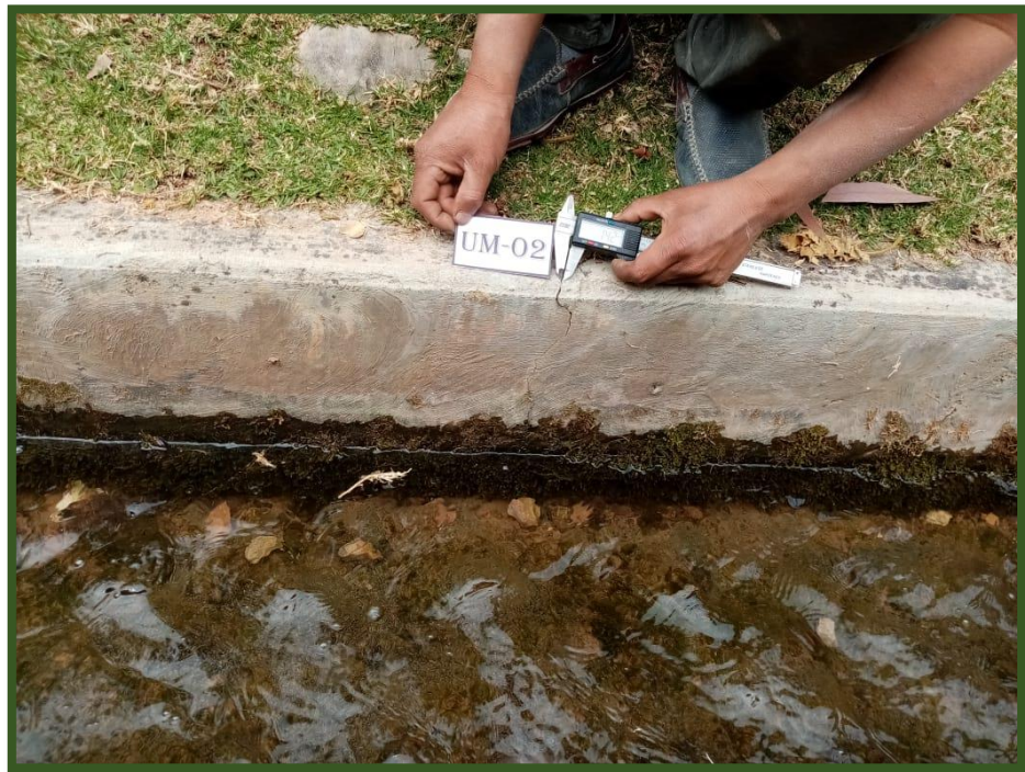
Gráfico 12: Fisuras en el canal de regadillo.
