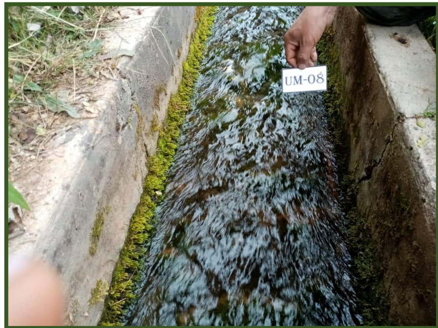
Gráfico 15: Moho en el canal de regadillo.
