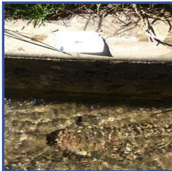
Gráfico 13: Erosión en el canal de regadillo.
