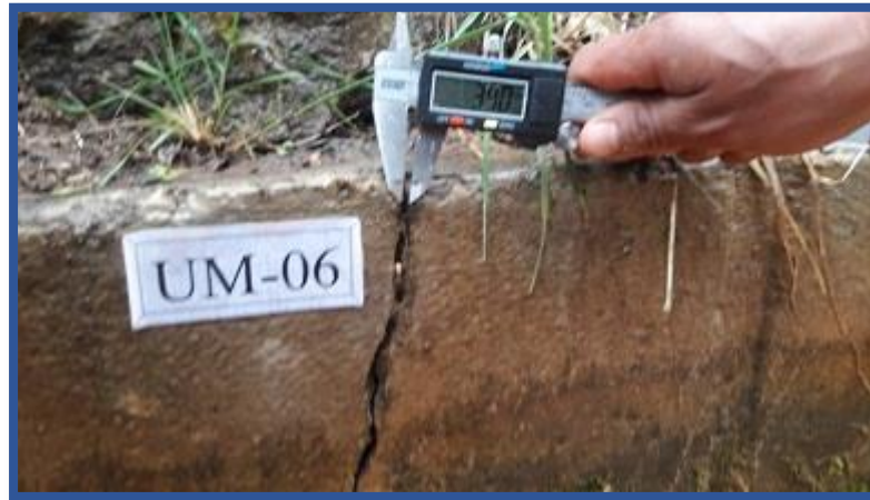
Gráfico 11: Grietas en el canal de regadillo.
