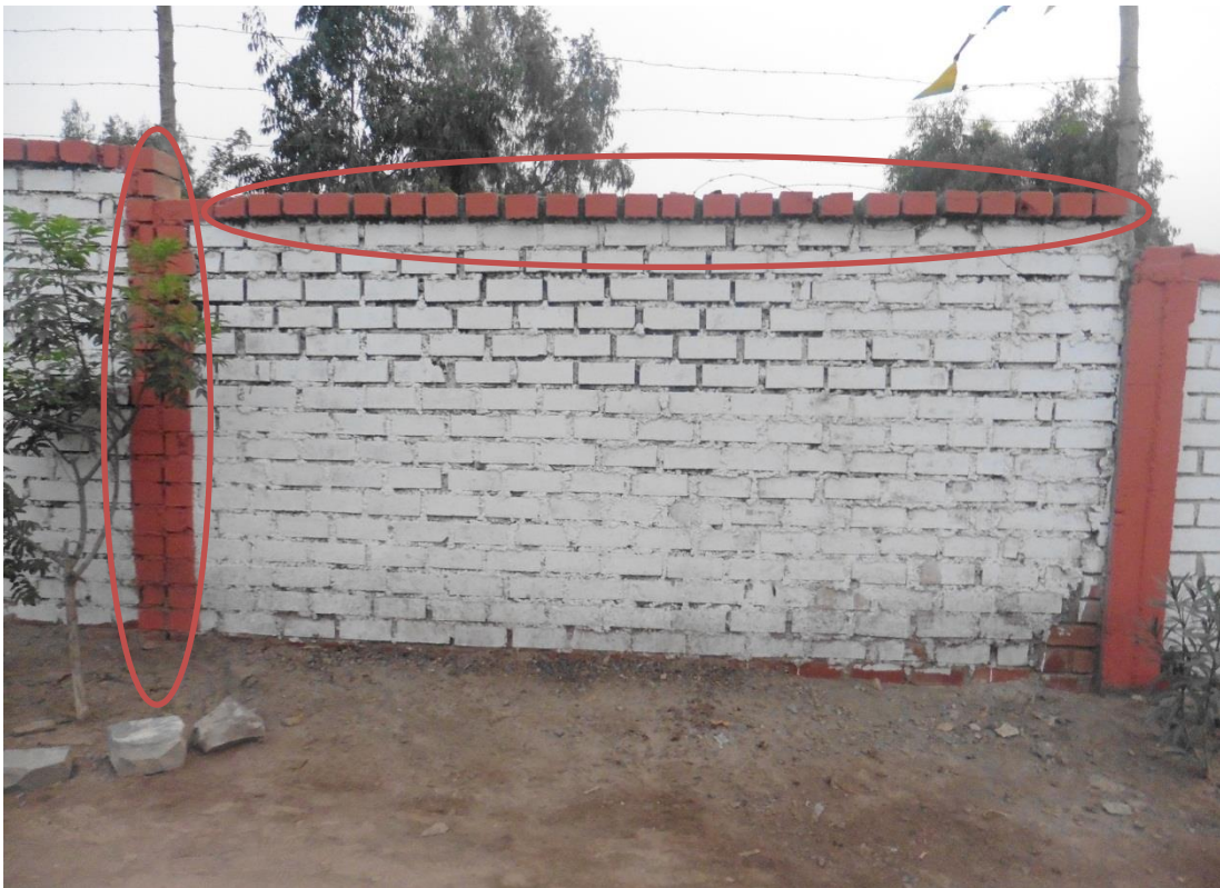
Fotografía 08: Deficiencia en el proceso Constructivo. (No se consideró columnas ni viga).
