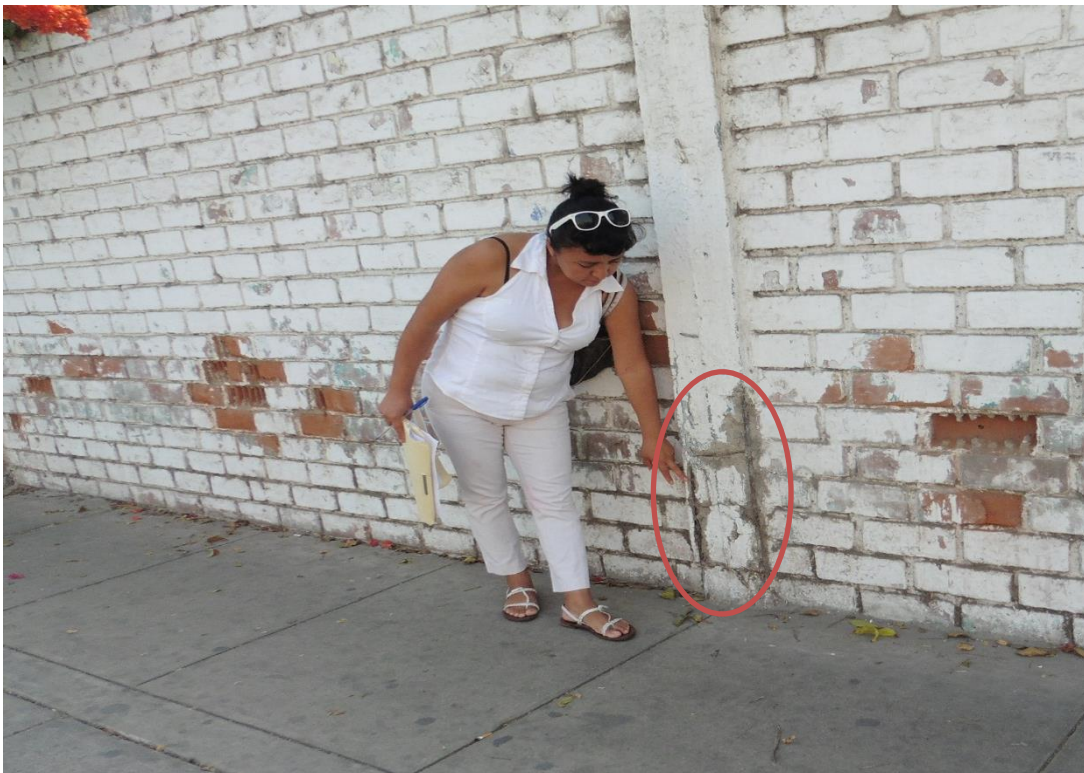
Fotografía 09: Patología Oxidación en la columna.
