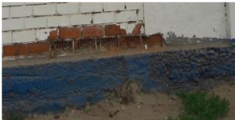
Imagen 1. Muro y sobrecimiento de albañilería afectada por la patología tipo erosión.
