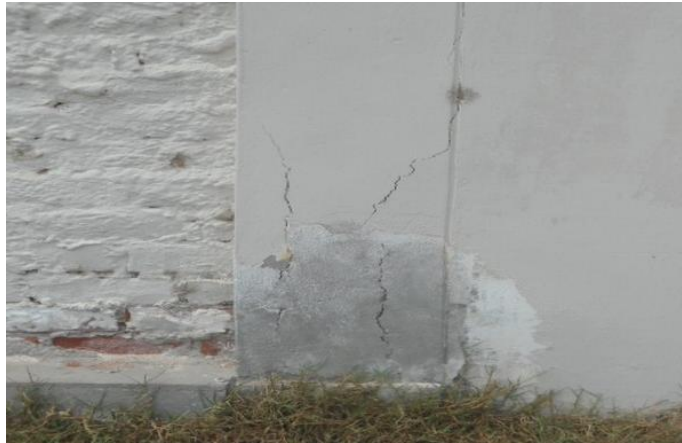
Imagen 5. Fisura en columna.
