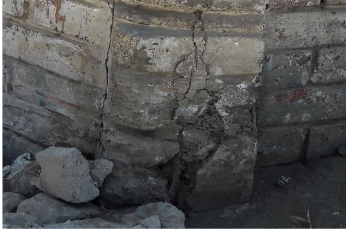
Imagen 3. Columna de albañilería afectada por la patología tipo Corrosión.
