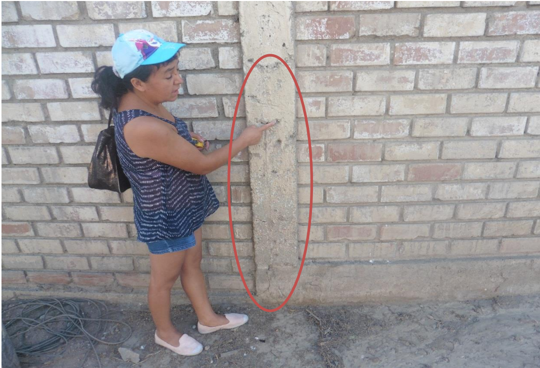
Fotografía 07: Evaluación de patología Erosión en columnas.
