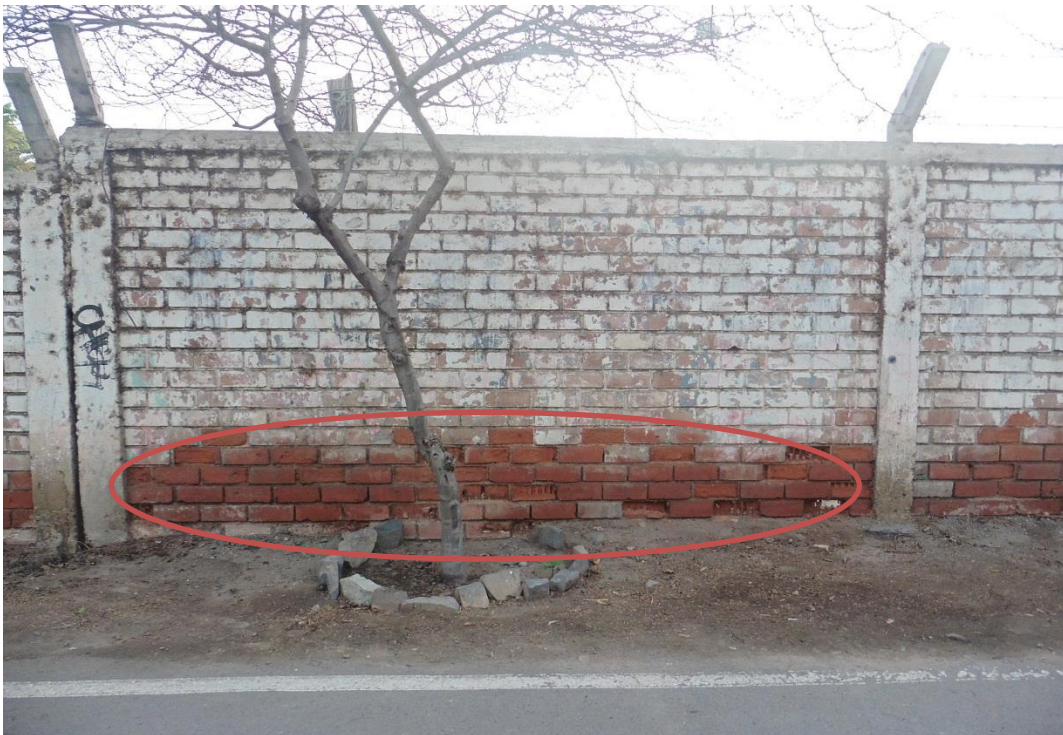
Fotografía 06: Patología Erosión en muros de albañilería.
