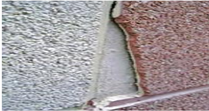
Imagen 7. Desprendimiento de muro.
