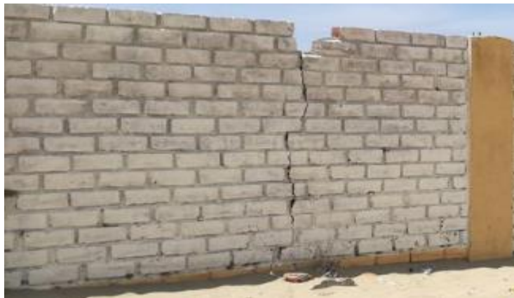
Imagen 4. Agrietamiento vertical en muro de albañilería. Nota. Fuente: Suarez, E. (2016)
