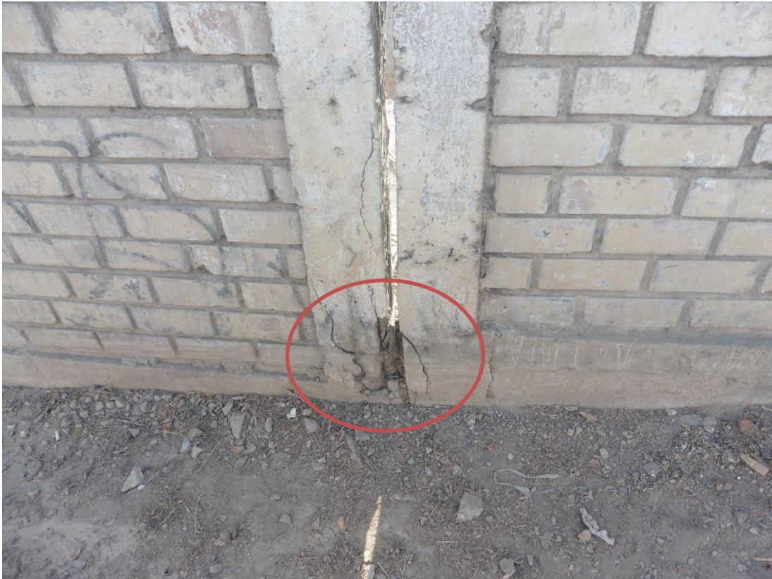
Fotografía 09: Patología grieta en la columna.
