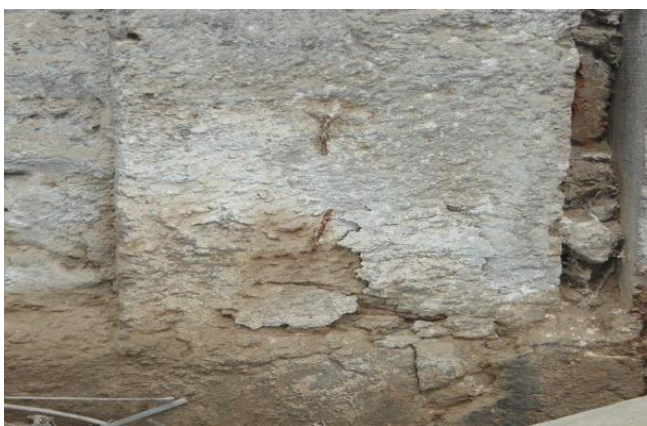
Imagen 2. Oxidación en los estribos de la columna.
