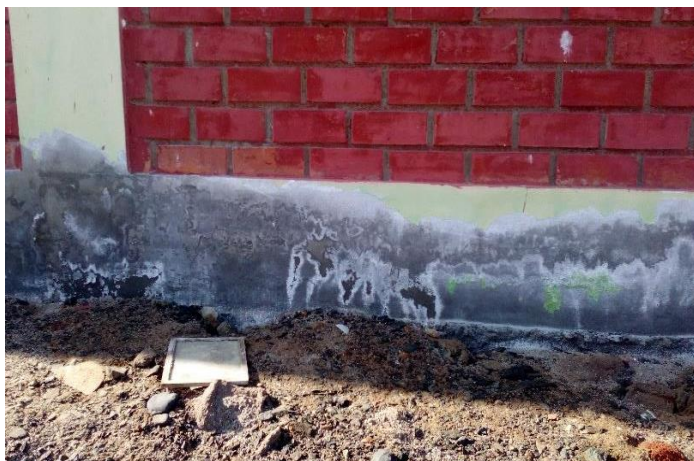
Imagen 6. Sobrecimiento de muro afectado por la eflorescencia.
