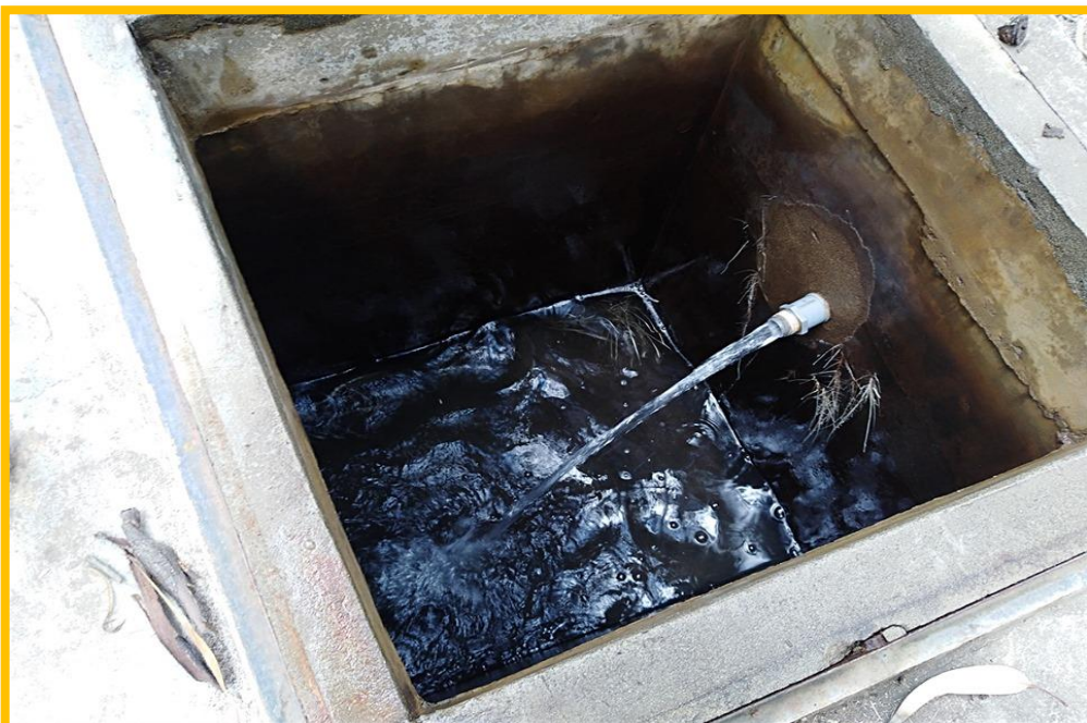
Imagen N° 14: Se puede apreciar en la cámara rompe presión 1 existente tipo 7, ya deteriorada por el tiempo de vida de la estructura y a la vez se observa la falta de accesorios en dicha estructura.
