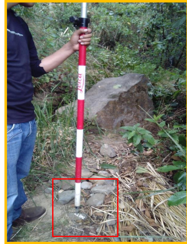
Imagen N° 04: Se presenta el BM 2 en la Captación propuesto.
