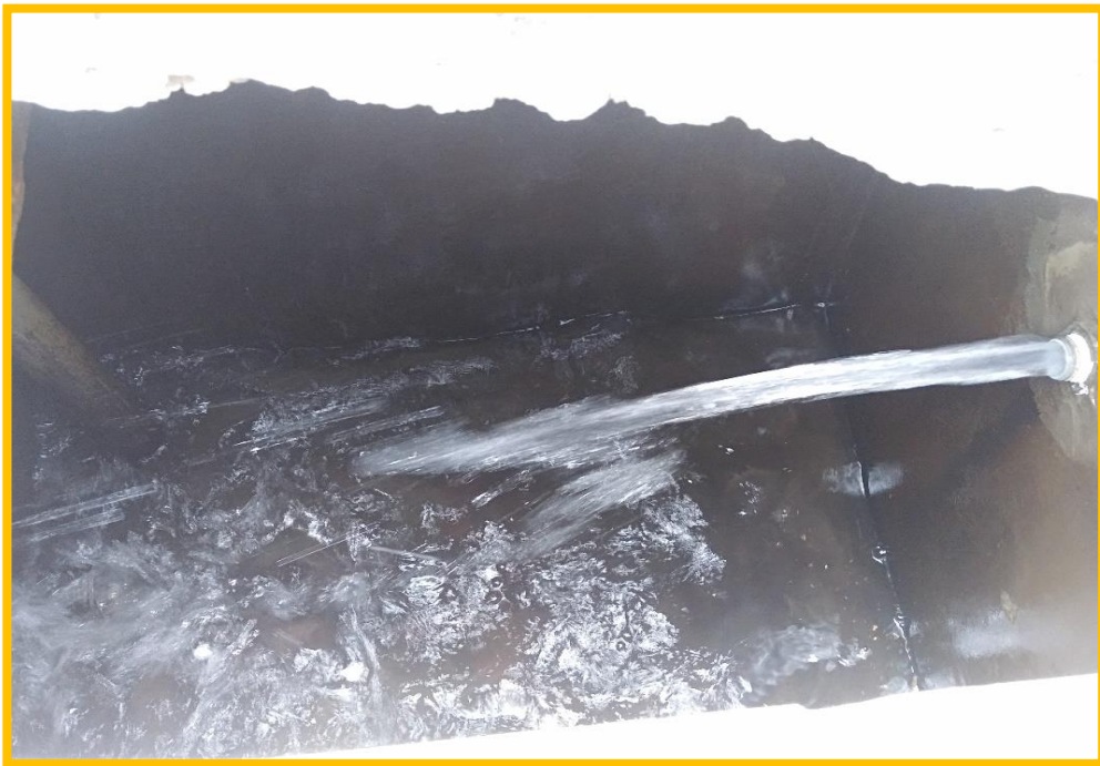
Imagen N° 12: Se puede apreciar la cámara rompe presión 2 existente tipo 7. En estado malo ya que se puede ver la suciedad de la CRP y así mismo se observa la falta de accesorios en dicha estructura.
