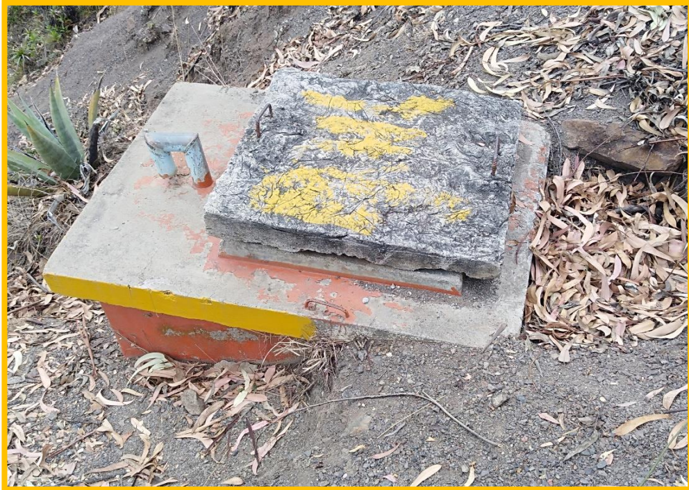
Imagen N° 11: Se aprecia la cámara rompe presión 2 existente tipo 7 en el sistema, esto se encuentra sin seguro y con tapa de concreto.
