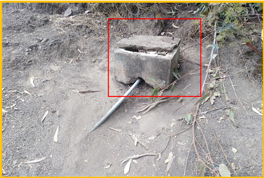
Imagen N° 15: Se aprecia la válvula de control en la red de distribución.
