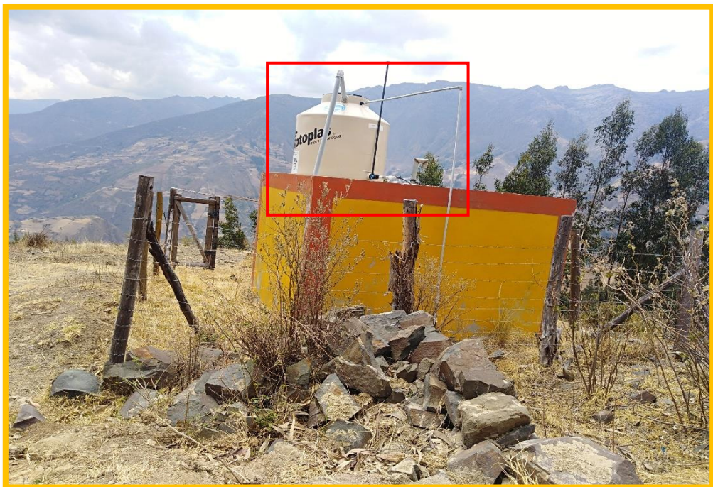
Imagen N° 10: Se observa el reservorio de almacenamiento de agua potable del caserío de Asay con su hipoclorador por goteo y así mismo su cerco perimétrico con alambre púa.
