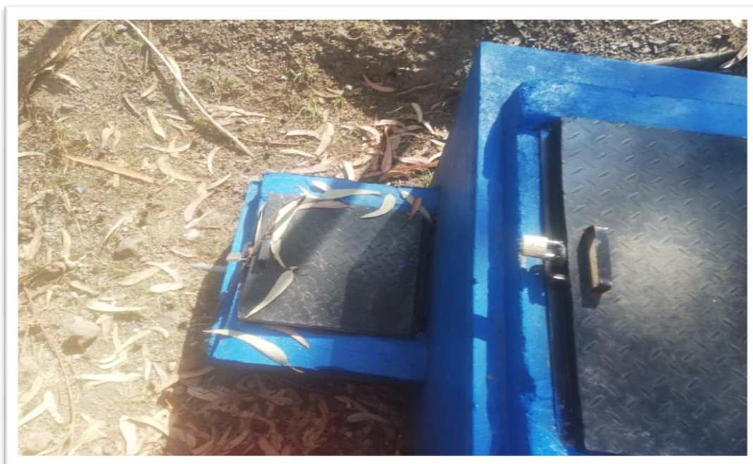
Imagen 6: Cámara rompe presión T-6, progresiva 2+740.0 km, antes del reservorio en la línea de conducción
