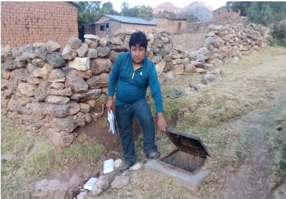
Fotografía N° 12: Válvula de control con deterioradas con tapas oxidadas operativas Fuente: Registro propio (Insitu)
