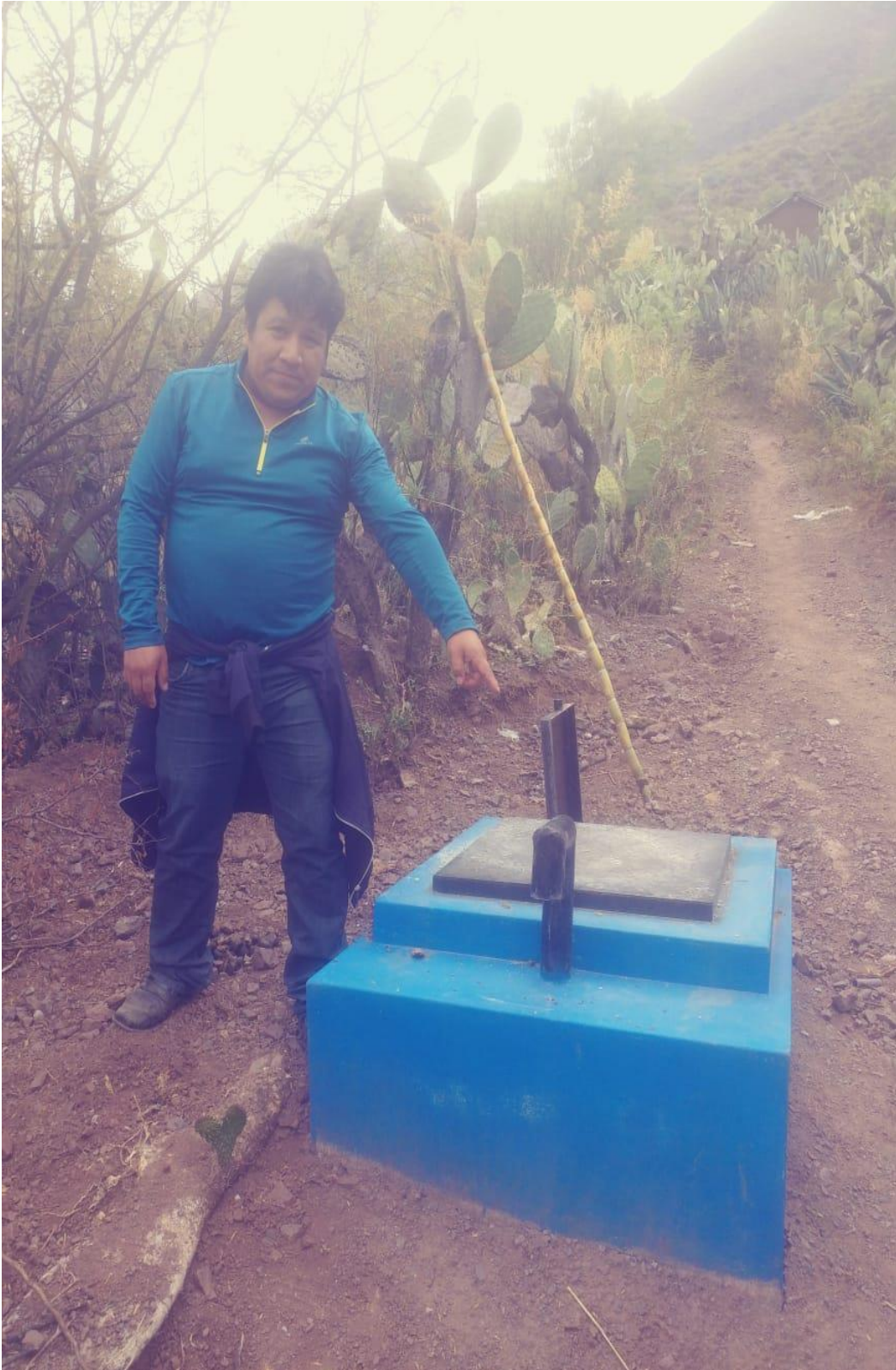
Fotografía N° 13: Cámara de rompe presión Fuente: Registro propio (Insitu)
