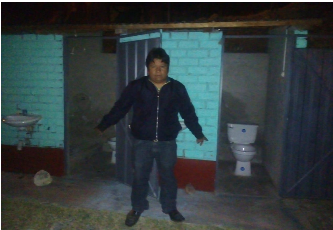
Fotografía N° 08: Servicios higiénicos operativos de la I.E. Patallaccta Fuente: Registro propio (Insitu)
