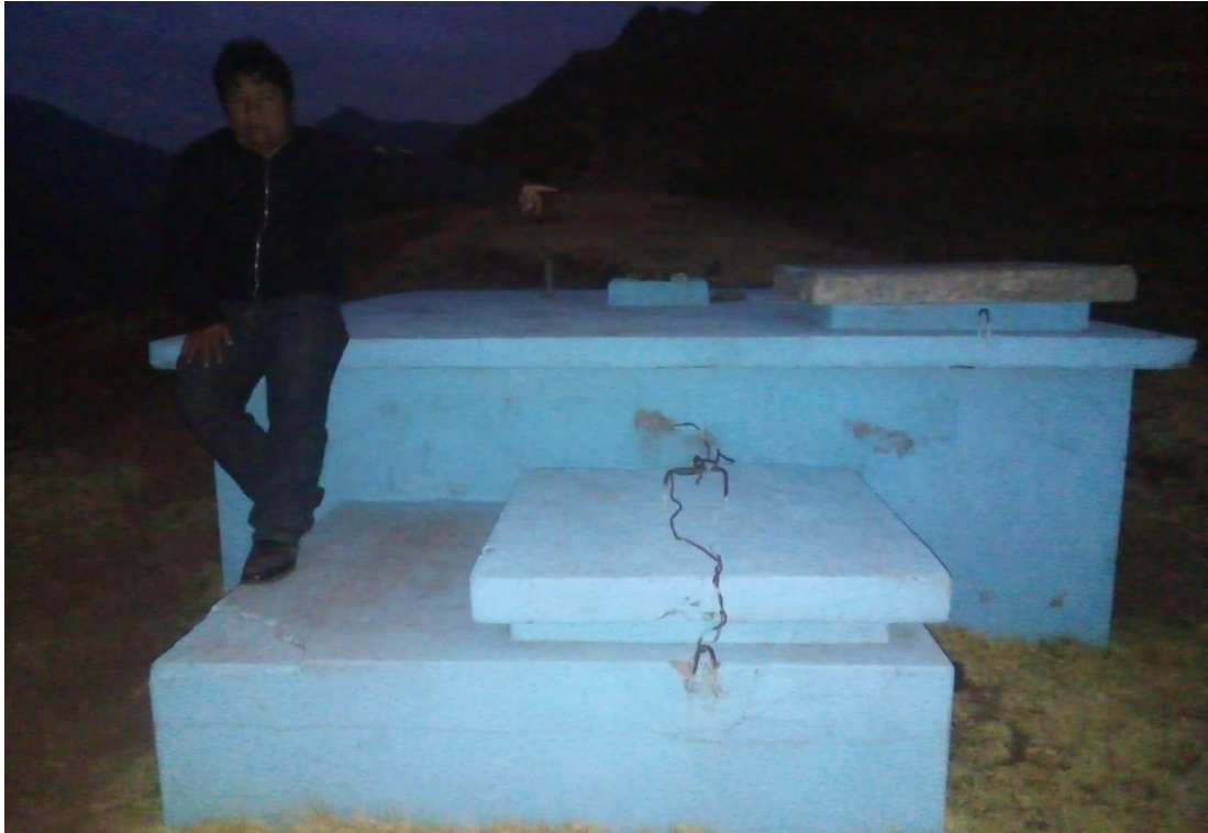
Fotografía N° 07: Reservorio en funcionamiento con ausencia cerco perimétrico y presencia de fisuras Fuente: Registro propio (Insitu)
