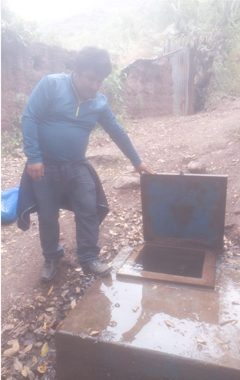
Fotografía N° 14: Cámara de rompe colapsada Fuente: Registro propio (Insitu)
