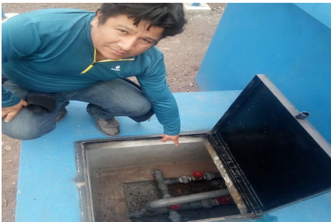
Fotografía N° 05: Caseta de válvulas operativas Fuente: Registro propio (Insitu)
