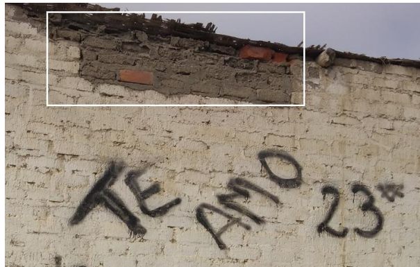
Figura 14. Desperfecto físico por causa de lluvias.
