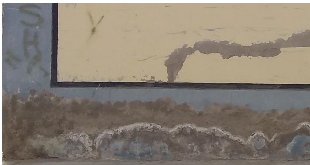
Figura 20. Existencia de eflorescencia en sobrecimiento.
