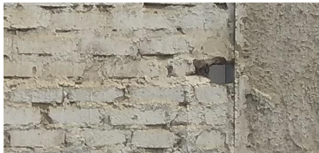
Figura 19. Muro con presencia de hueco ocasionado por golpes o impactos.
