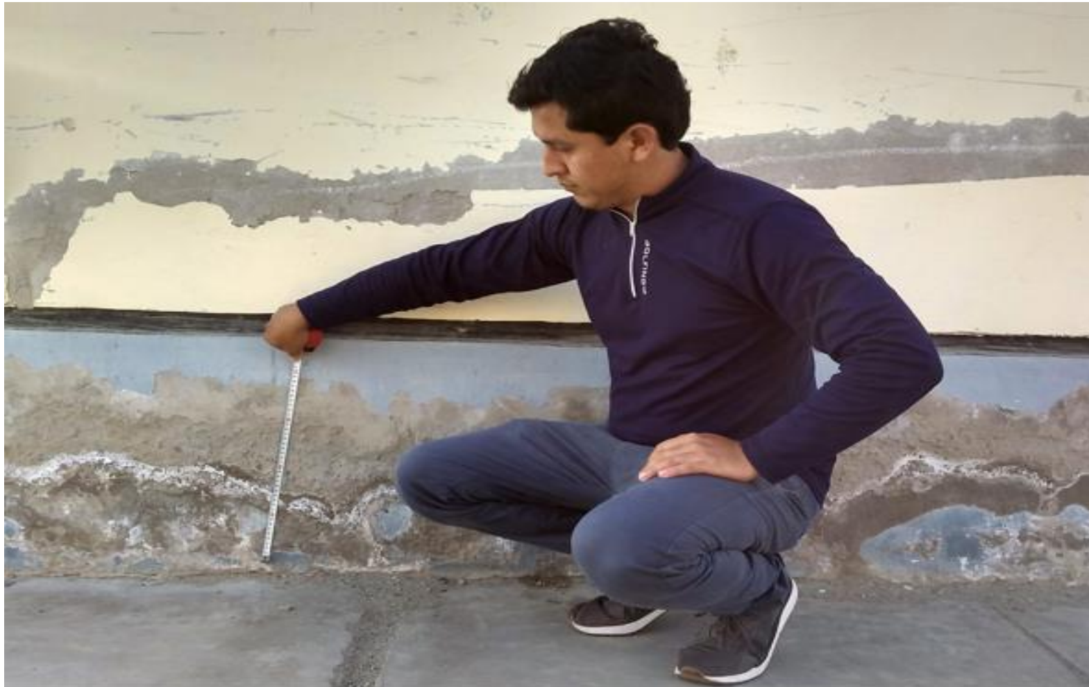
Fotografía 13: Sobrecimiento y muro de albañilería afectado por eflorescencia (velo grueso) en la unidad muestral 06 con un porcentaje de área afectada por esta patología de 11.43%. El nivel de severidad de esta área en específica es alto.
