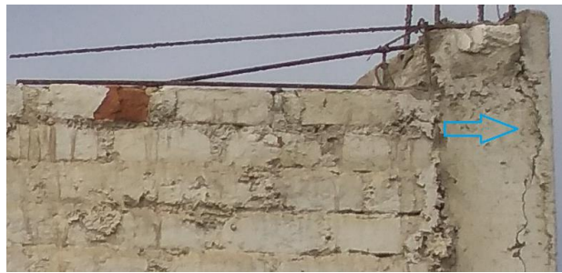
Figura 17. Grieta en columna de concreto armado ocasionada por esfuerzo de compresión.
