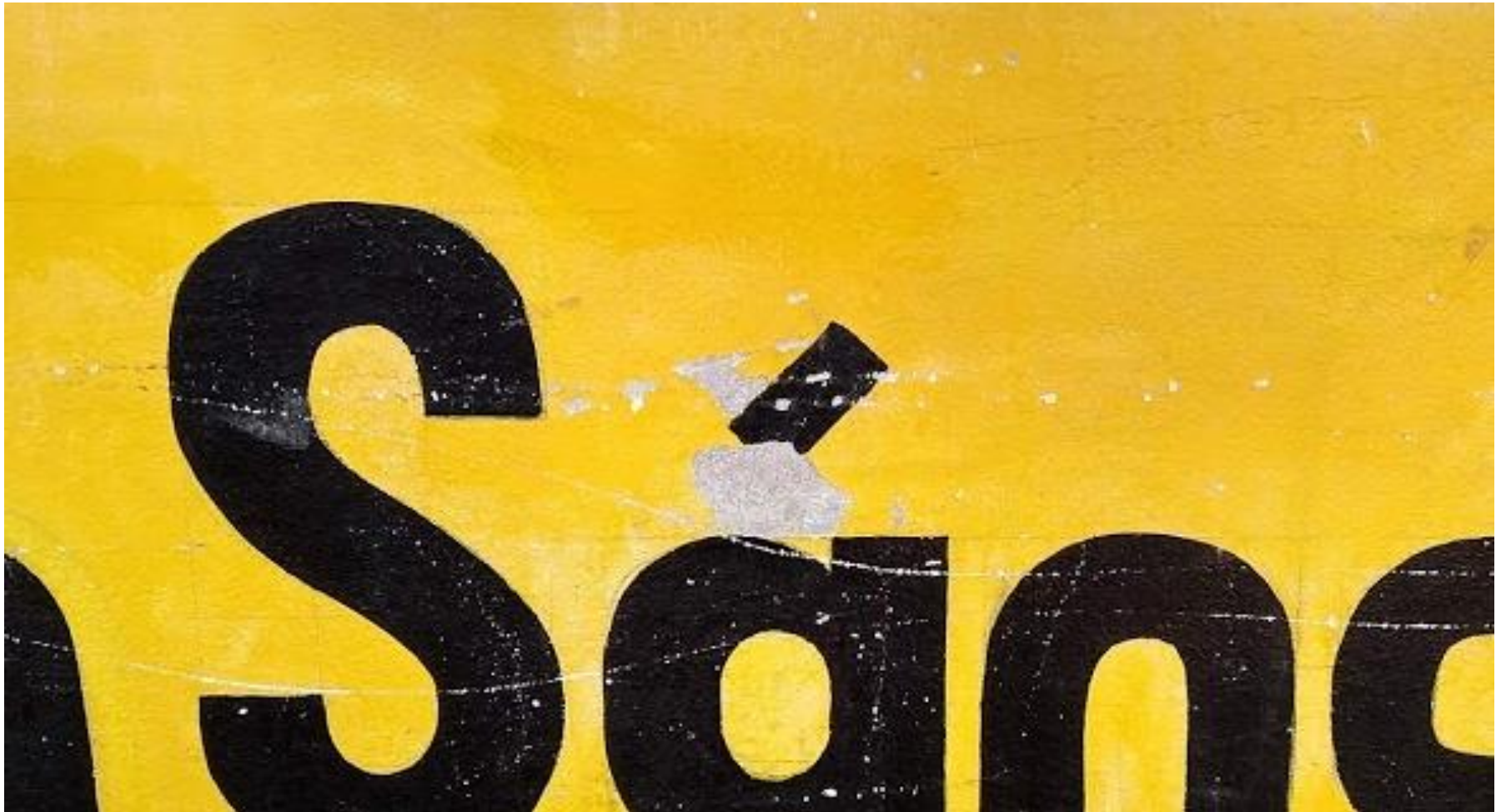
Fotografía 10: Muro de albañilería afectado por descascamiento en la unidad muestral 06 con un porcentaje de área afectada por esta patología de 0.07%. El nivel de severidad de esta área en específica es leve.
