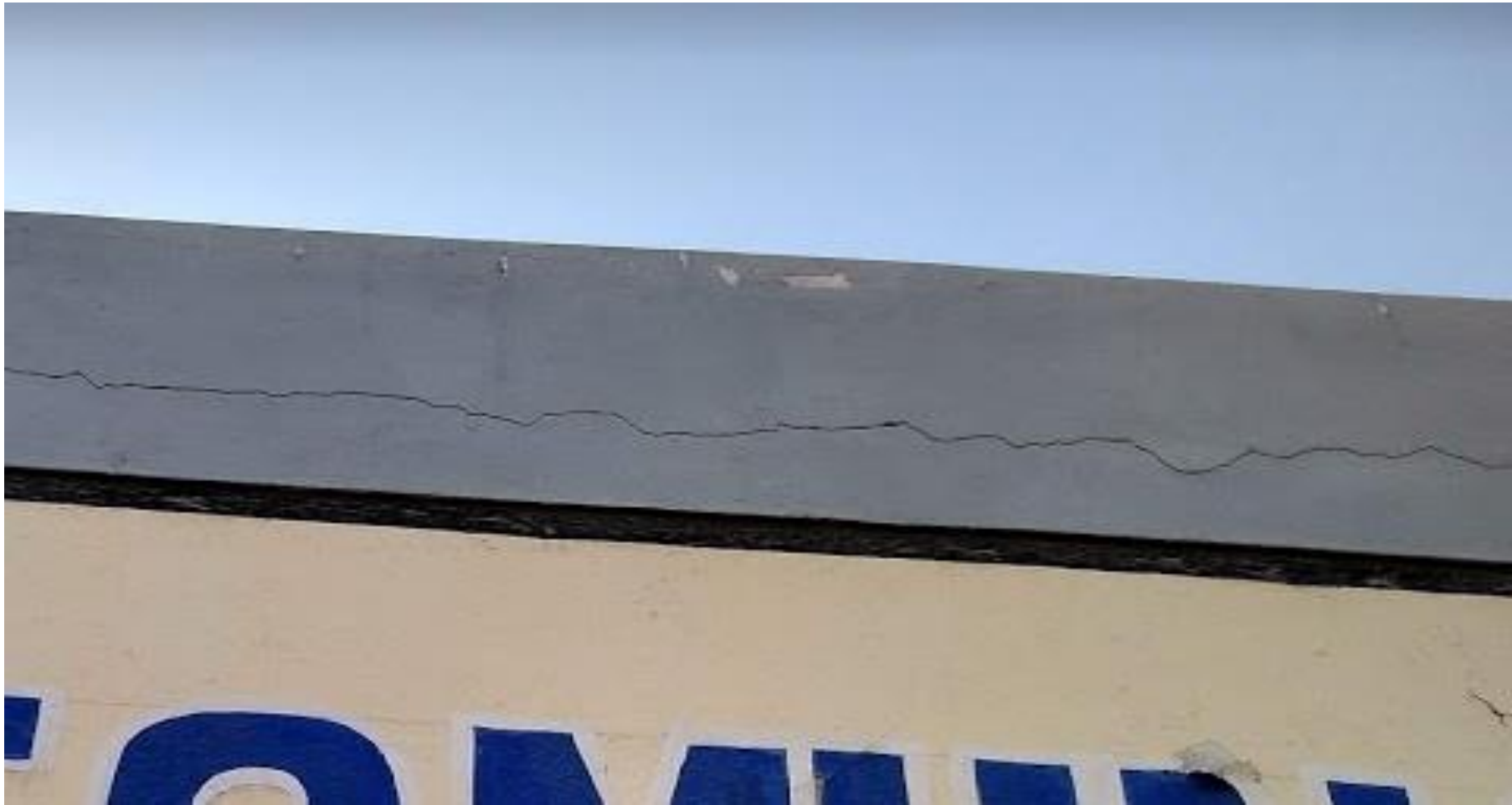
Fotografía 08: Muro de albañilería afectado por fisura en la unidad muestral 06 con un porcentaje de área afectada por esta patología de 2.58%. El nivel de severidad de esta área en específica es moderado.
