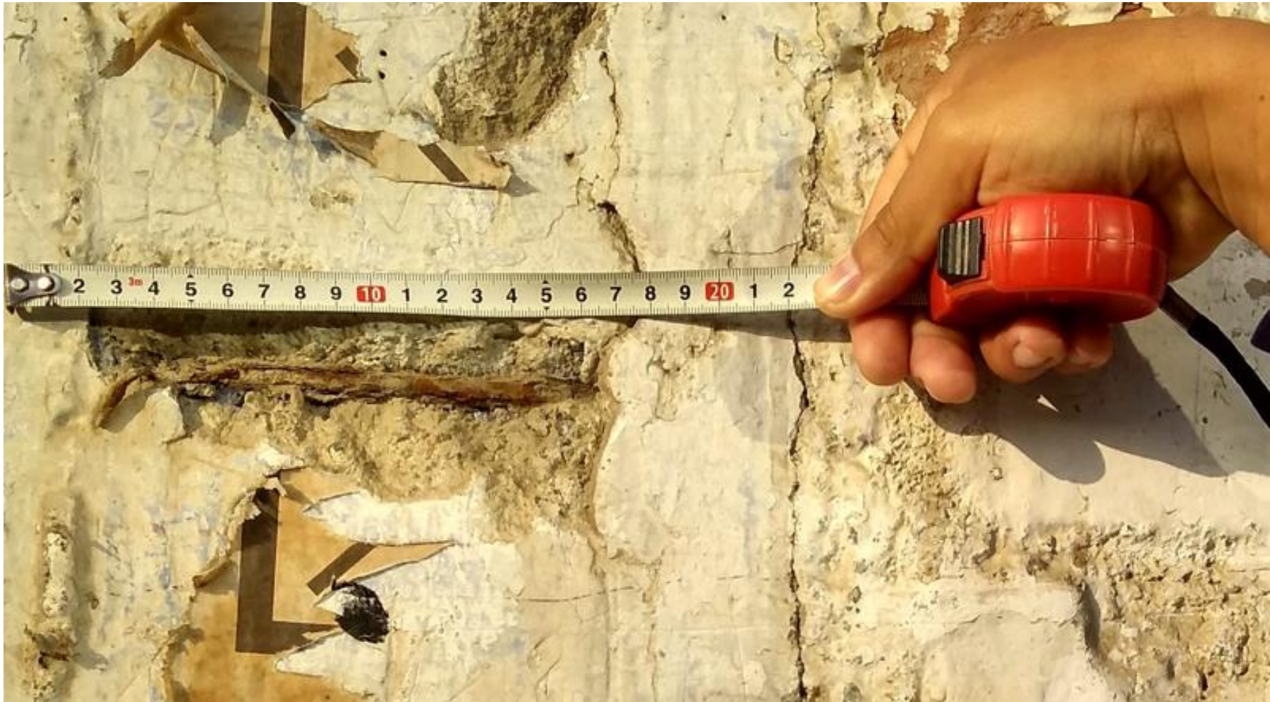
Fotografía 11: Columna afectada por corrosión en la unidad muestral 04 con un porcentaje de área afectada por esta patología de 0.17%. El nivel de severidad de esta área en específica es alto.
