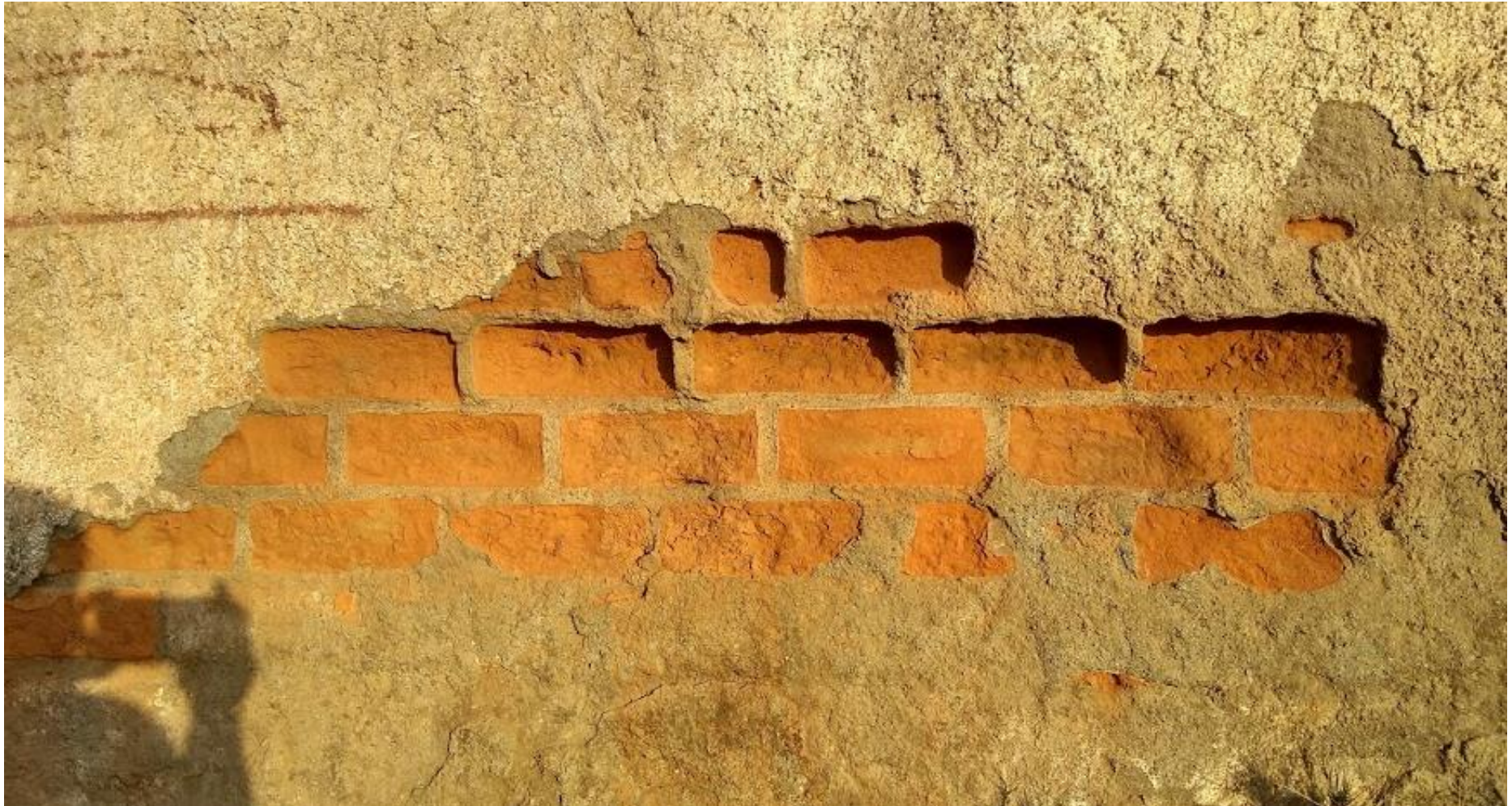
Fotografía 06: Muro afectado por erosión química en la unidad muestral 15 con un porcentaje de área afectada por esta patología de 17.97%. El nivel de severidad de esta área en específica es alto.
