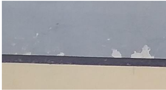
Figura 15. Desprendimiento de la pintura en la parte alta de un muro.
