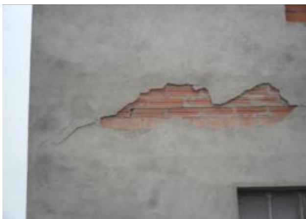
Figura 18. Desprendimiento de acabado de un muro.
