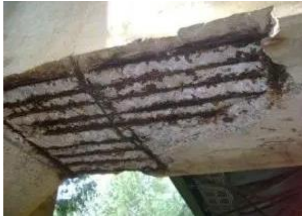
Figura 22. Corrosión en viga provocada por reducido recubrimiento. Nota. Fuente: RB Conspro. (2014).
