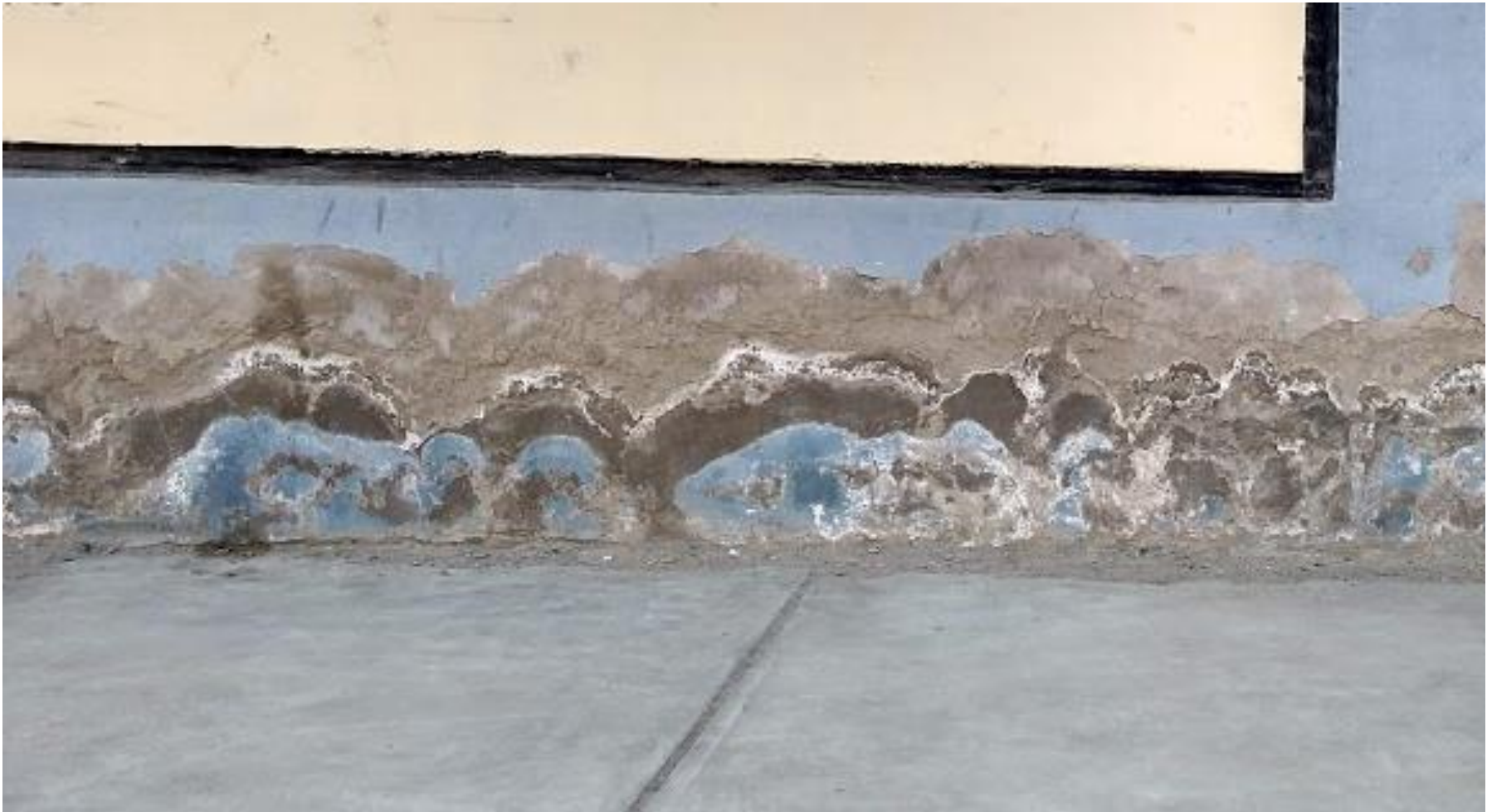
Fotografía 07: Sobrecimiento y muro de albañilería afectado por eflorescencia (velo grueso) en la unidad muestral 05 con un porcentaje de área afectada por esta patología de 12.30%. El nivel de severidad de esta área en específica es alto.
