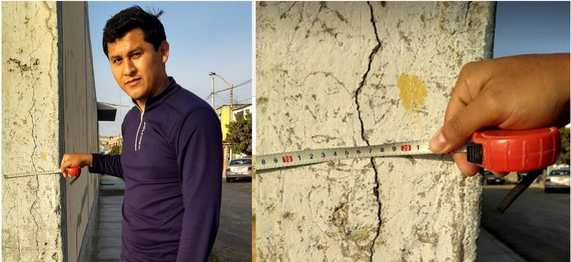
Fotografía 09: Columna afectada por grieta en la unidad muestral 04 con un porcentaje de área afectada por esta patología de 2.40%. El nivel de severidad de esta área en específica es moderado.
