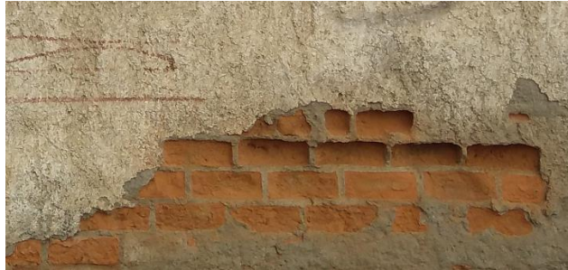
Figura 21. Erosión química en muro por consecuencia de la humedad.
