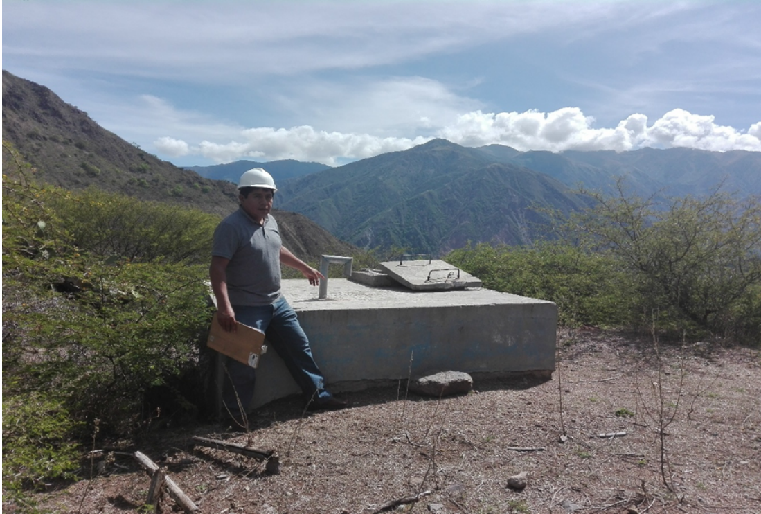
Figura 2.6: Cámara de cloración que es usada a la vez como reservorio.
