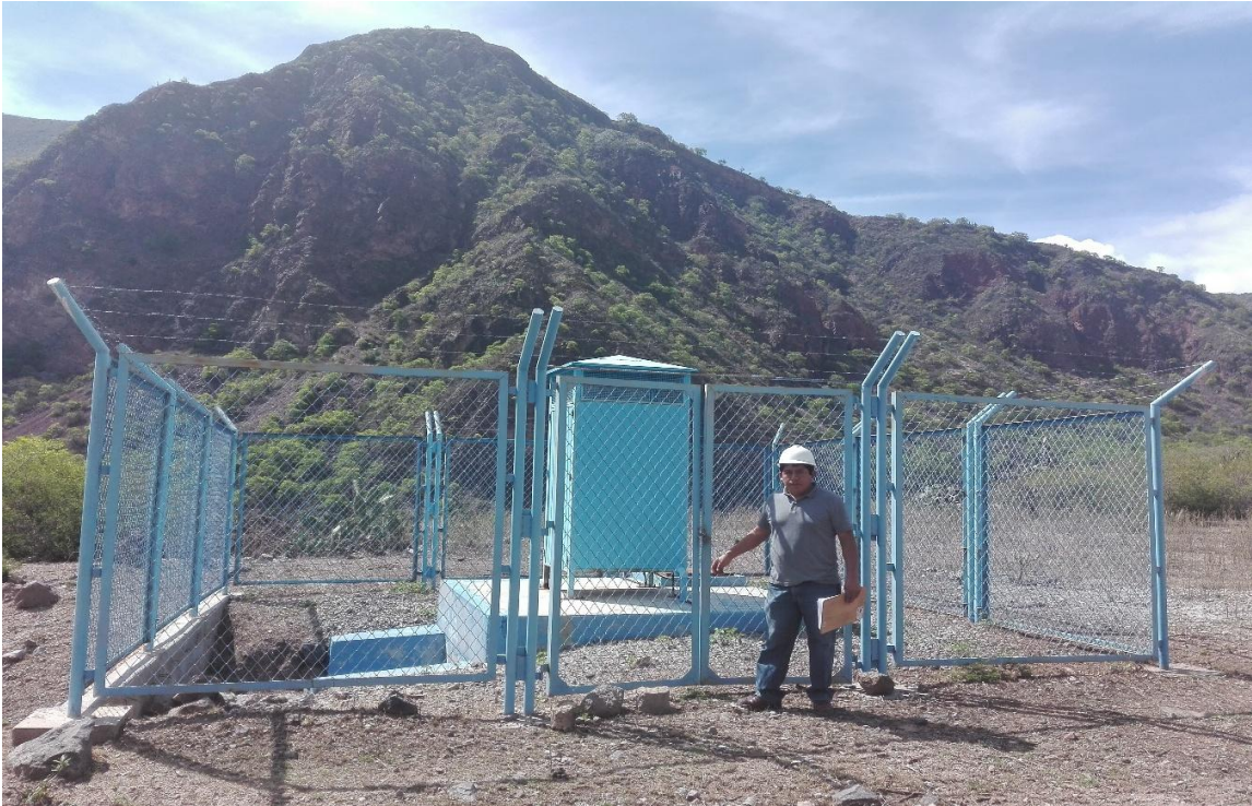
Fotografía 15: Caseta de válvulas del reservorio.
