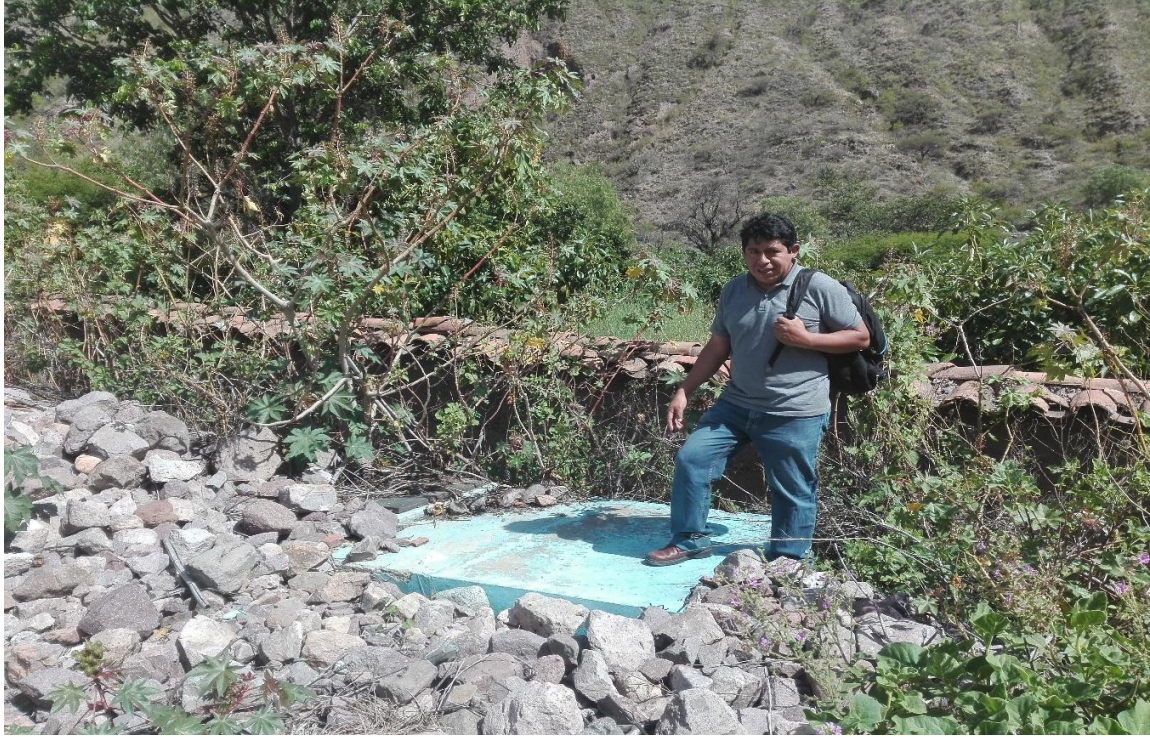
Fotografía 09: Captación sin cerco perimétrico.
