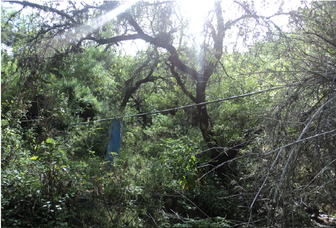
Figura 2.4: Línea aérea de aducción de agua potable.. Fuente: (Municipalidad Distrital de Ocros, 2019).
