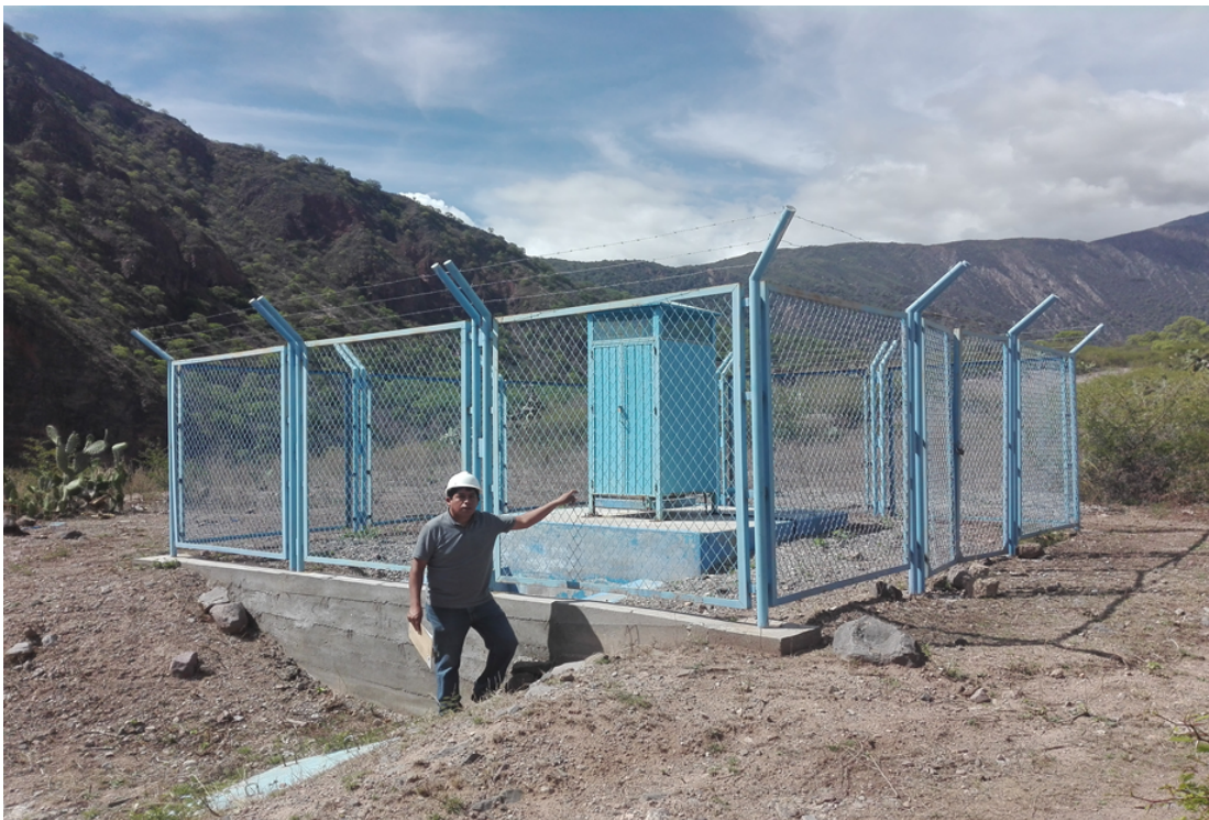
Figura 2.9: Caseta de válvulas del reservorio..
