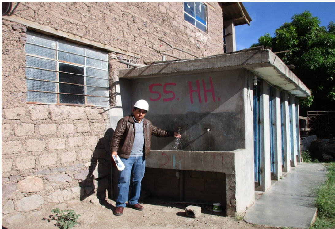
Figura 2.1: UBS en buen estado de conservación y uso.
