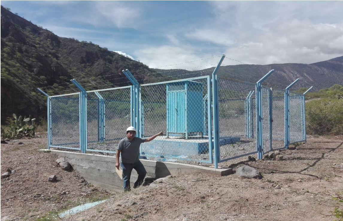
Fotografía 14: Vista lateral de la cámara de cloración.
