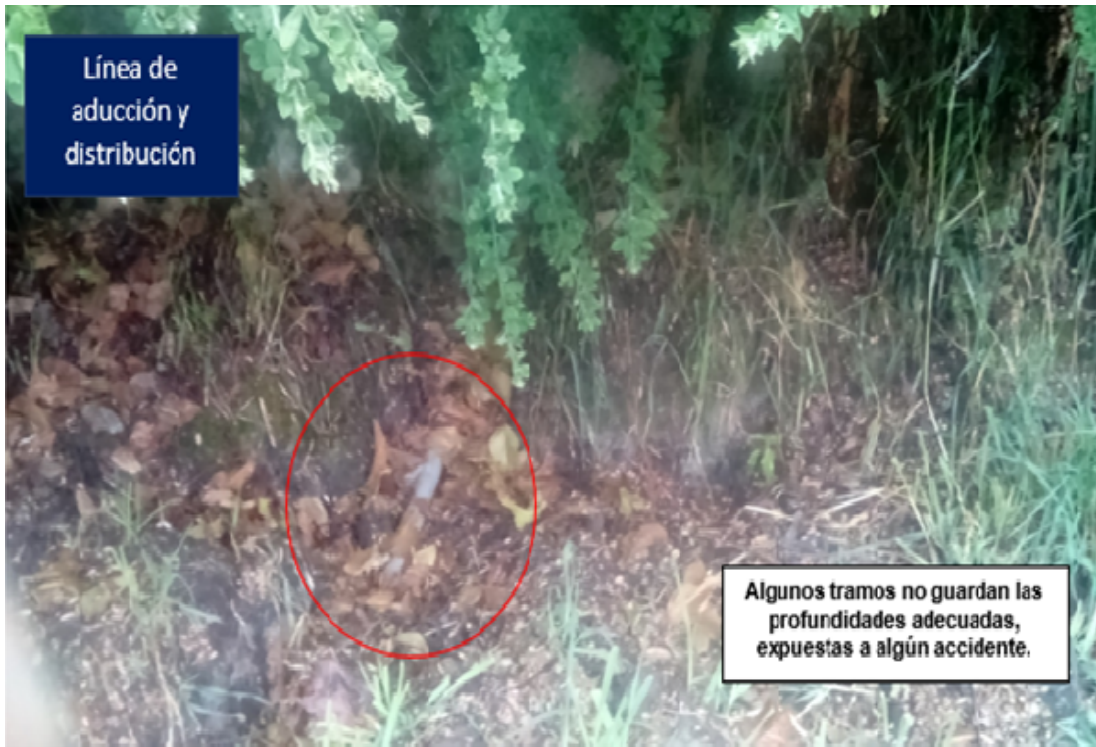
Figura 5.10: Válvula de control deteriorado y tubería expuesta. Fuente: Municipalidad distrital de Anco, 2017.
