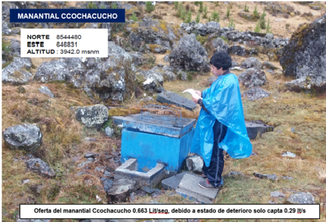
Figura 5.1: Vista de la captación manantial actual. Fuente: Municipalidad distrital de Anco, 2017.
