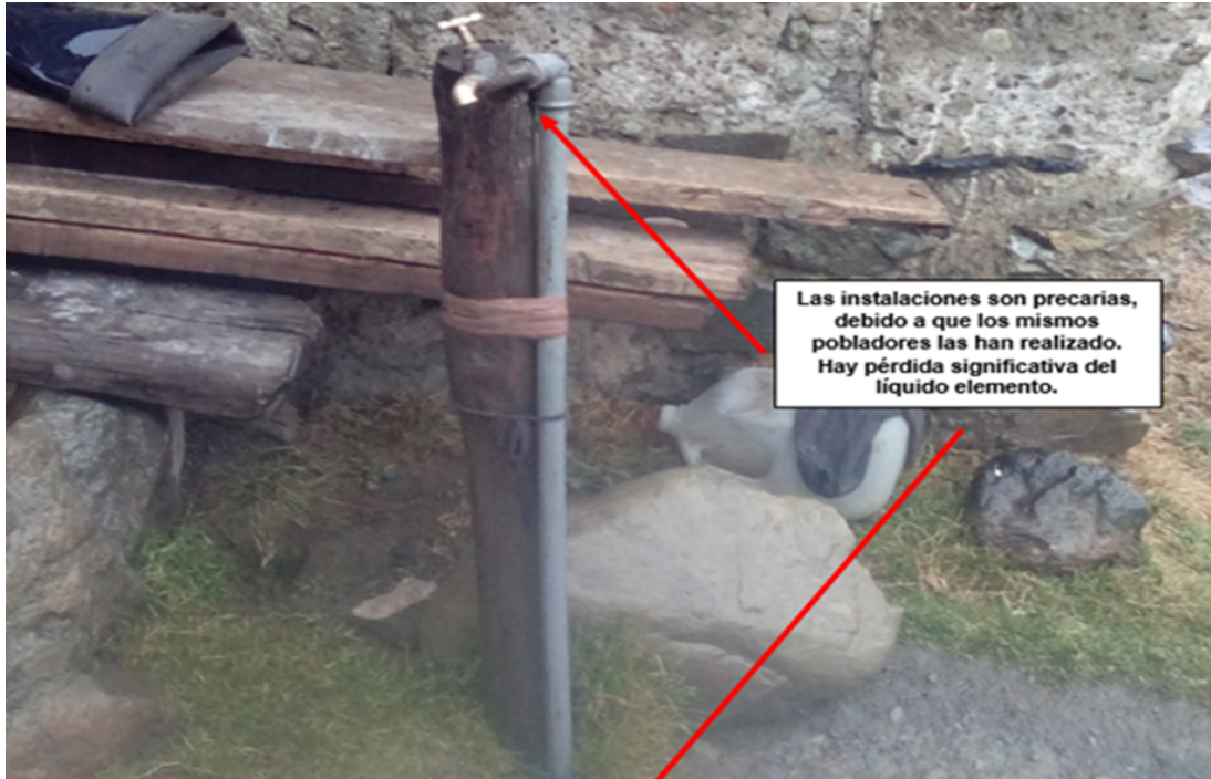
Figura 2.12: Instalación en estado alarmante de abandono y deterioro.
