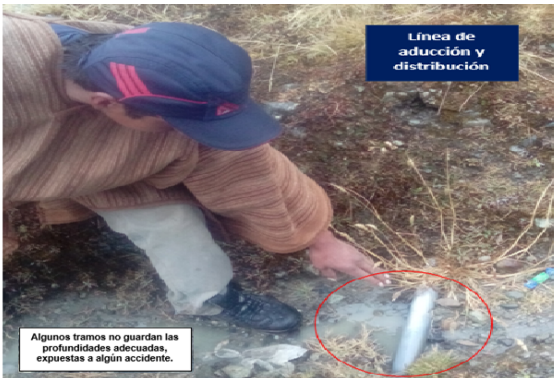
Figura 5.11: Tubería expuesta. Fuente: Municipalidad distrital de Anco, 2017.
