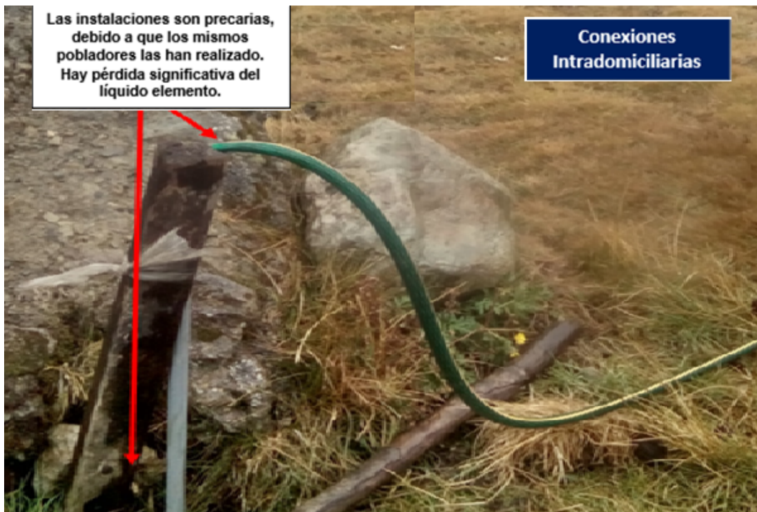
Figura 5.20: Situación actual de las conexiones domiciliarias. Fuente: Municipalidad distrital de Anco, 2017.
