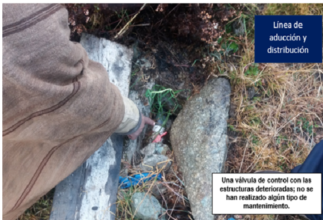
Figura 5.9: Válvula de control deteriorado y tubería expuesta. Fuente: Municipalidad distrital de Anco, 2017.
