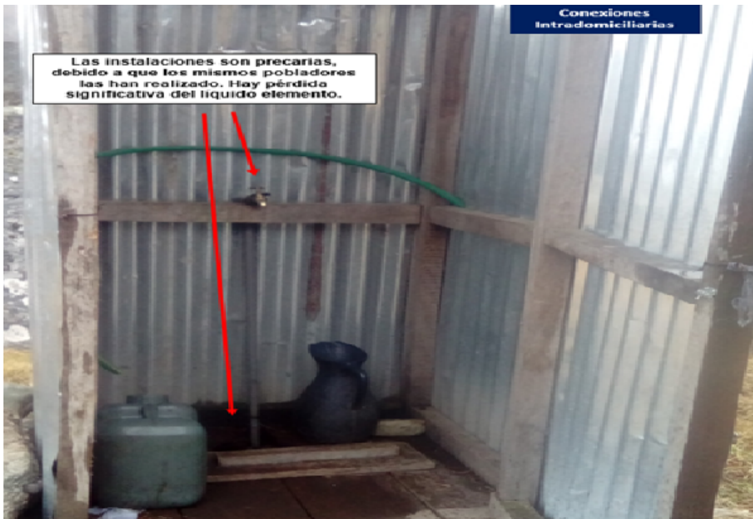
Figura 5.22: Situación actual de las conexiones domiciliarias. Fuente: Municipalidad distrital de Anco, 2017.
