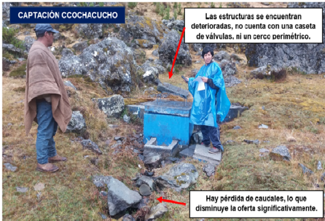
Figura 5.2: Vista de la captación manantial actual. Fuente: Municipalidad distrital de Anco, 2017.
