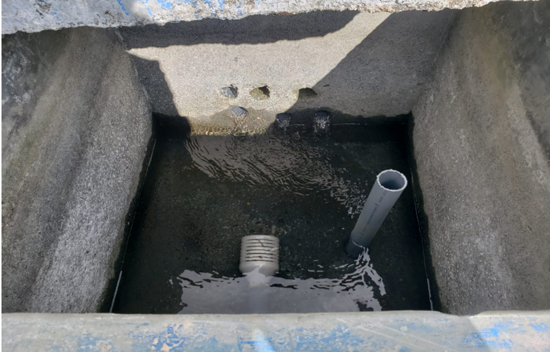
Figura 2.3: Vista interna de una captación.
