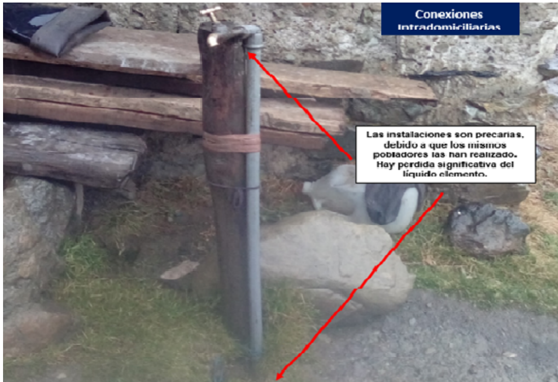
Figura 5.19: Situación actual de las conexiones domiciliarias. Fuente: Municipalidad distrital de Anco, 2017.
