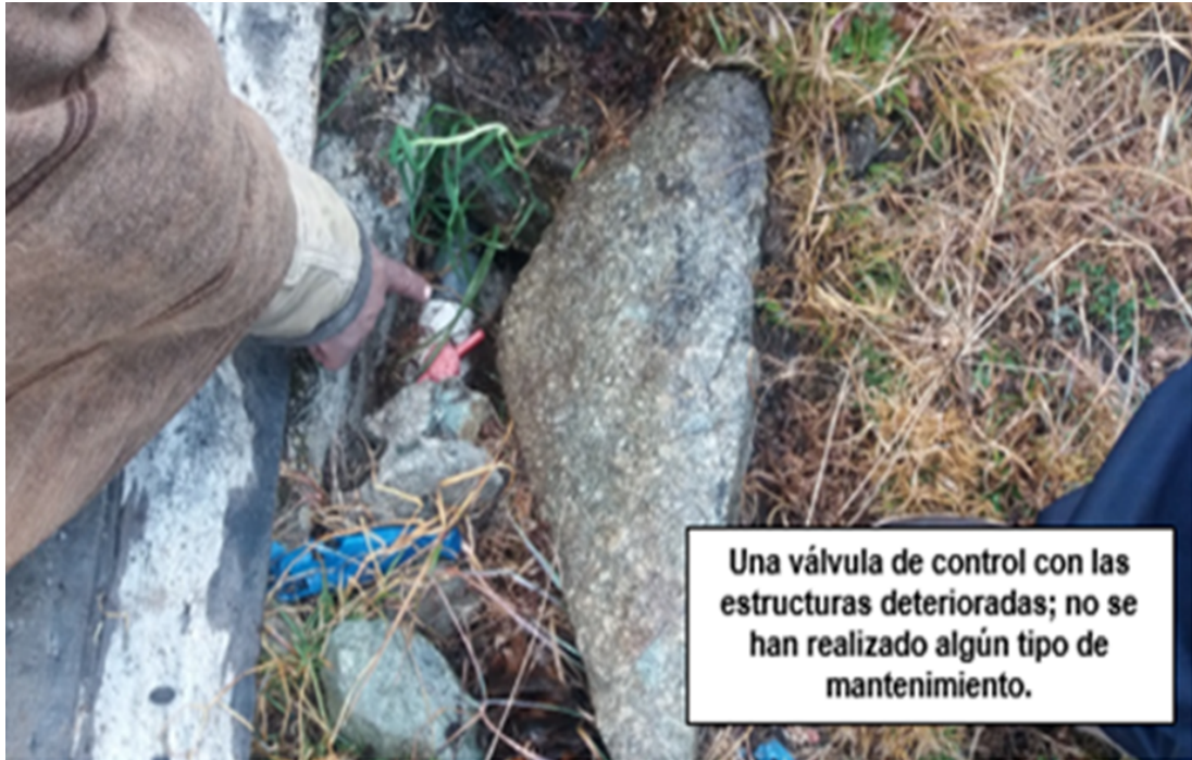
Figura 2.9: Válvula de control en estado de abandono y deterioro.
