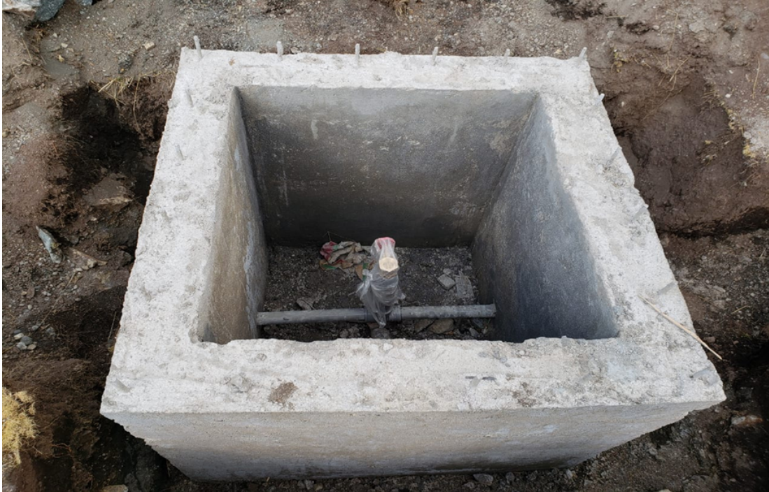
Figura 2.5: Vista interna de una válvula de la línea de aducción.
