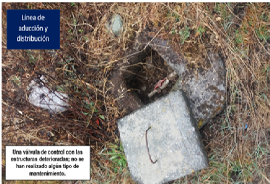
Figura 5.8: Válvula de control deteriorado. Fuente: Municipalidad distrital de Anco, 2017.
