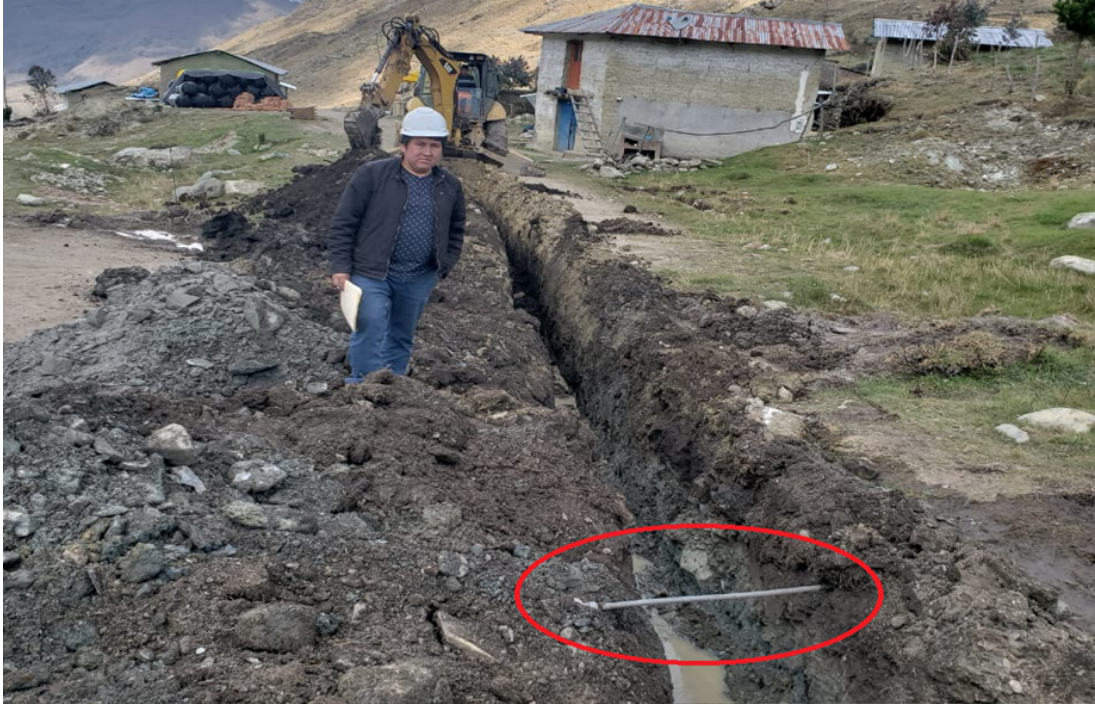
Figura 2.11: Conexión domiciliaria con tubería expuesta.
