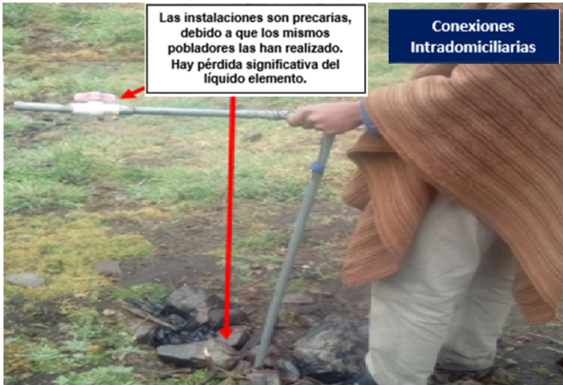
Figura 5.21: Situación actual de las conexiones domiciliarias. Fuente: Municipalidad distrital de Anco, 2017.
