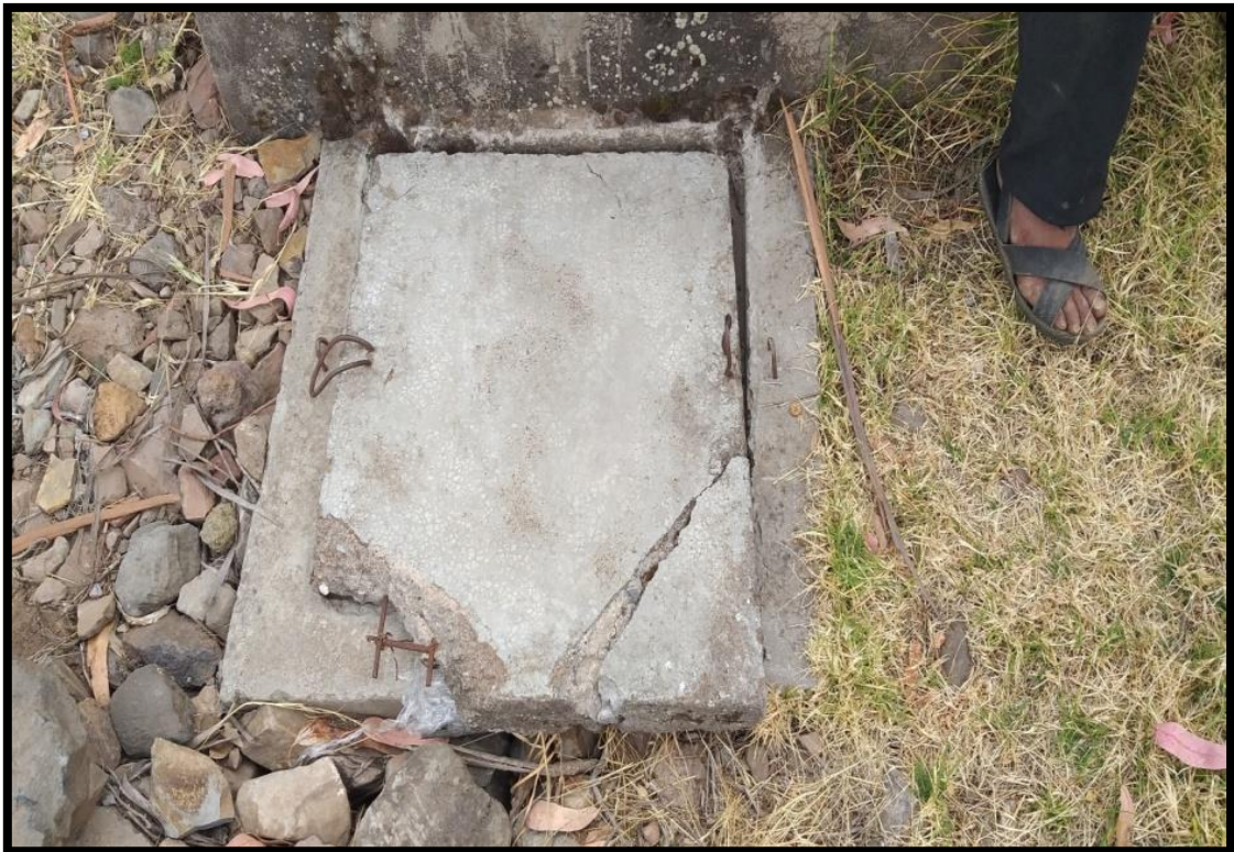
Foto 3: caja de válvulas de la captación en mal estado
