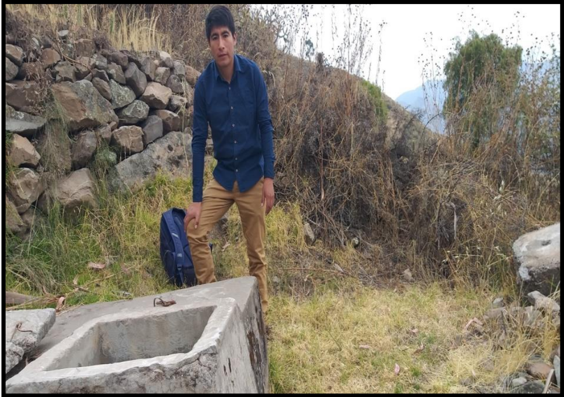
Foto 1: Vista donde se aprecia la Estructura deteriorada de la captación
