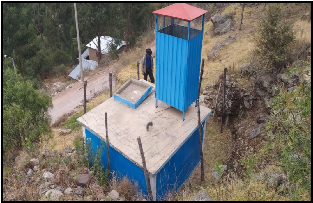
Foto 6: vista del hipoclorador del reservorio
