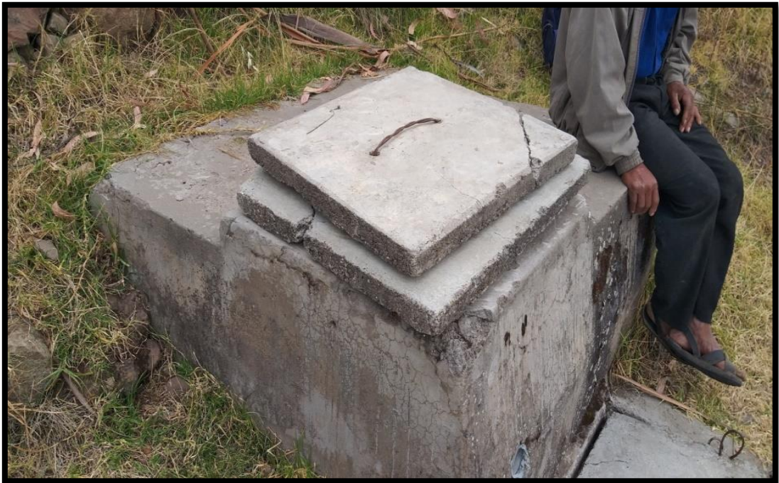
Foto 2: tapa sanitaria de la captación en mal estado
