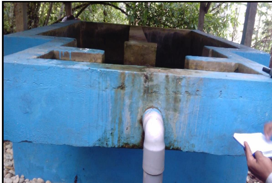
Figura 13: la planta de tratamiento de agua se encuentra deteriorado, por ello se plantea construir una planta de tratamiento de agua junto a la captación
