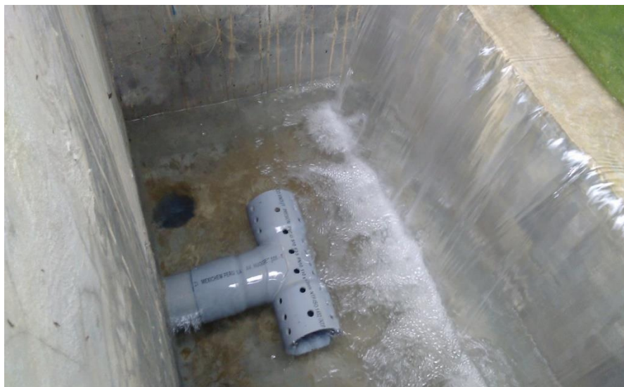
Figura 11: Captación Vista alegre, el agua ingresa al reservorio sin tratamiento, eso a su vez ingresa a la línea de distribución.
