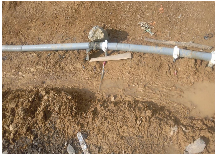
Figura 15: Las tuberías de la red de distribución se encuentran expuestas al aire libre propenso a rupturas
