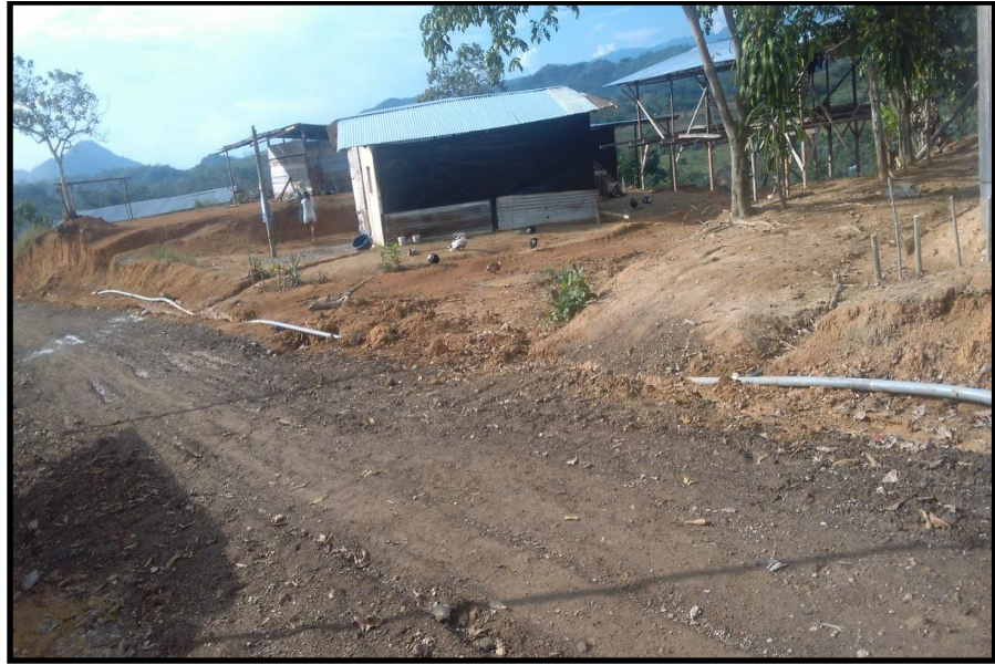
Figura 14: Línea de distribución se encuentran expuestas colocados sin criterio técnico, la población que se ubica cerca de ello se conecta
