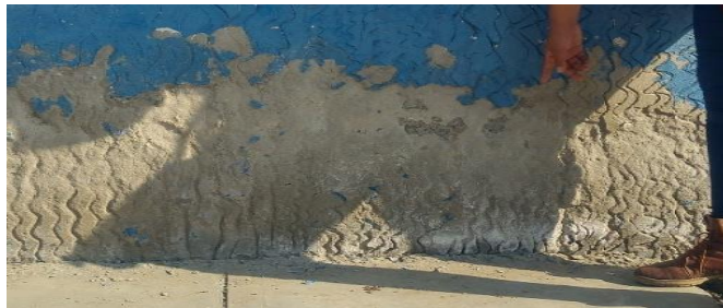
Gráfico 20: Figura de la patología eflorescencia en los muros de albañilería Fuente: Elaboración Propia. (2019).
