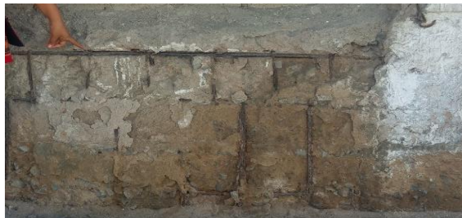
Gráfico 23: Figura de la patología corrosión en el acero de los sobre cimientos Fuente: Elaboración Propia. (2019).
