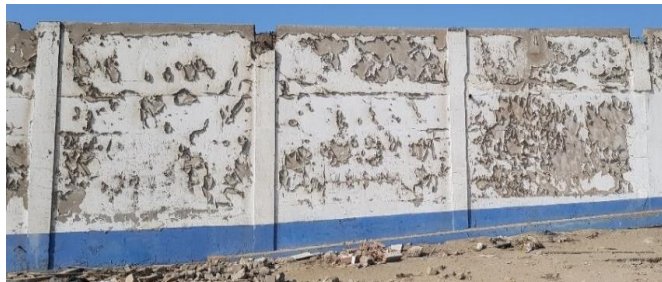
Gráfico 15: Figura de la patología desconchamiento en los muros de albañilería
