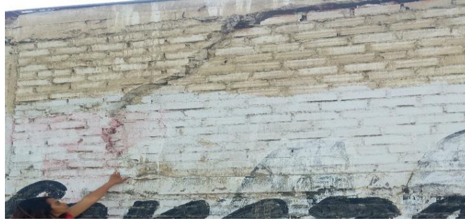
Gráfico 18: Figura de la patología grieta en los muros de albañilería Fuente: Elaboración Propia. (2019).
