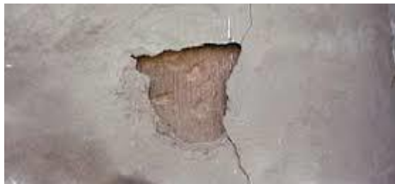
Gráfico 16: Fotografía de la patología desprendimiento en los muros de albañilería
