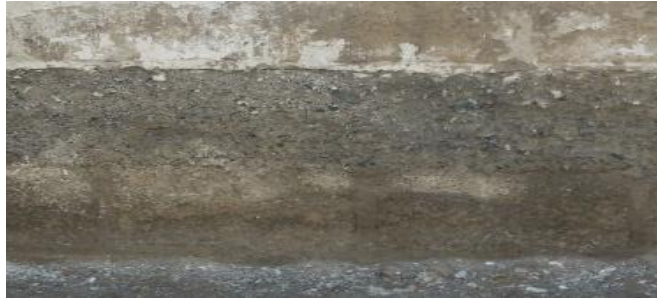
Gráfico 22: Figura de la patología disgregación en los muros de albañilería Fuente: Elaboración Propia. (2019).
