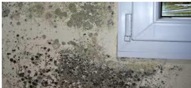
Gráfico 21: Figura de la patología moho en los muros de albañilería Fuente: Ramos X. Estudio de patologías como medida para una construcción sostenible (2013).
