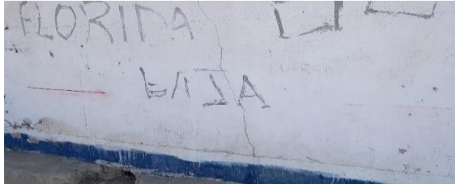
Gráfico 17: Figura de la patología fisura en los muros de albañilería Fuente: Elaboración Propia. (2019).
