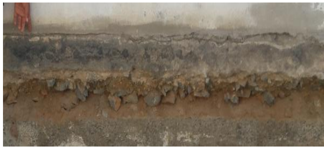
Gráfico 19: Figura de la patología desintegración en los muros de albañilería Fuente: Elaboración Propia. (2019).
