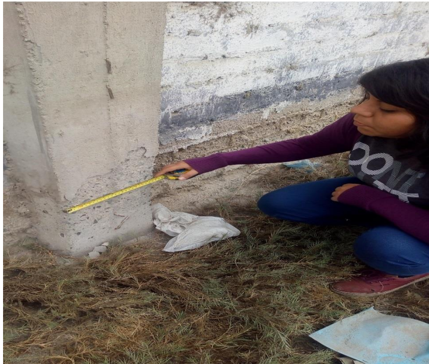
Fotografía 10: Desprendimiento hallado en la unidad de muestra N° 10.
