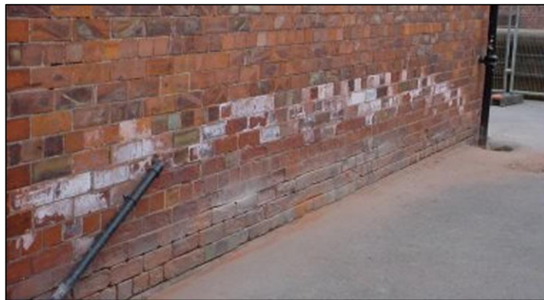
Gráfico 14: Eflorescencia en el muro.
