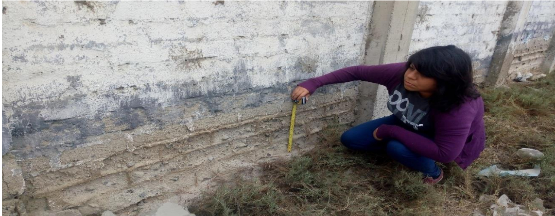
Fotografía 8: Evaluación de la patología erosión en el muro del paño de la unidad de la muestra N° 11.
