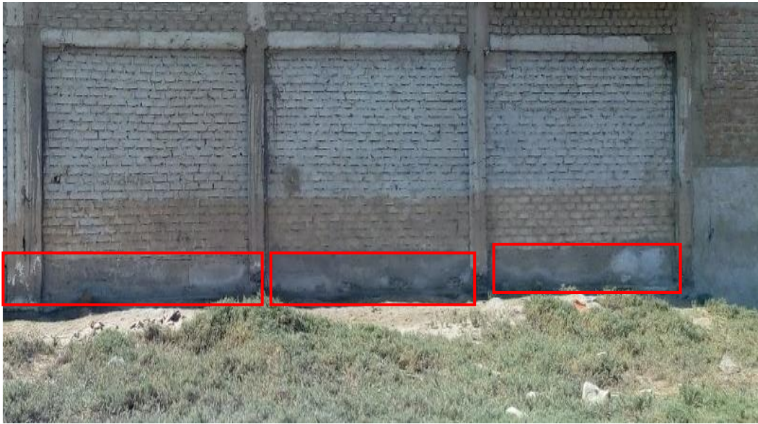
Fotografía 14: Eflorescencia hallada en la unidad de muestra N° 19.
