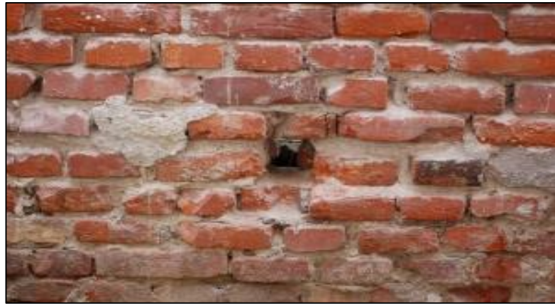
Gráfico 13: Desprendimiento de trozos de ladrillo.
