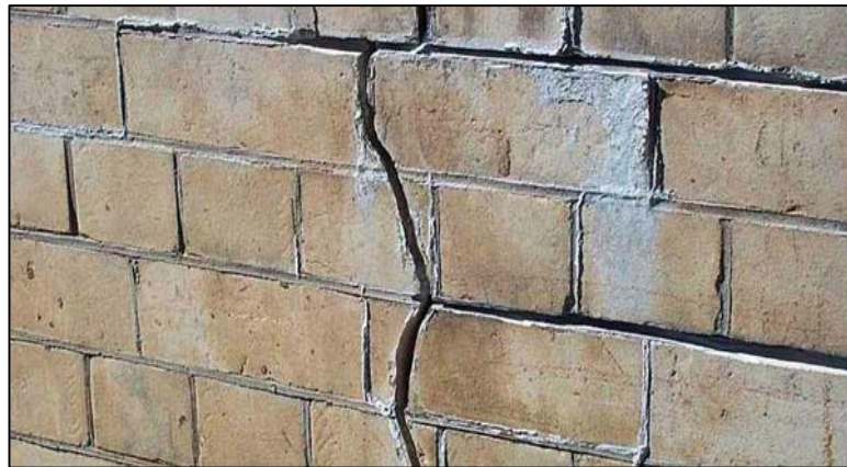
Gráfico 12: Grieta en muro.
