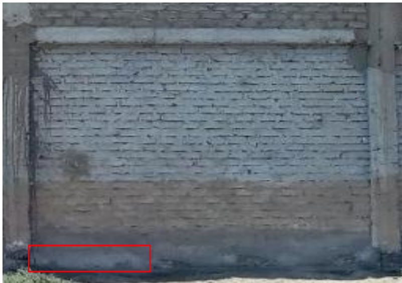
Fotografía 15: Eflorescencia hallada en el paño de la unidad de muestra N° 18.
