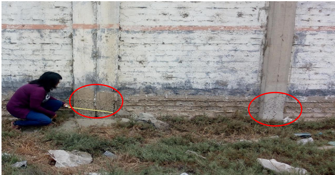
Fotografía 11: Desprendimiento hallado en la unidad de muestra N° 11.
