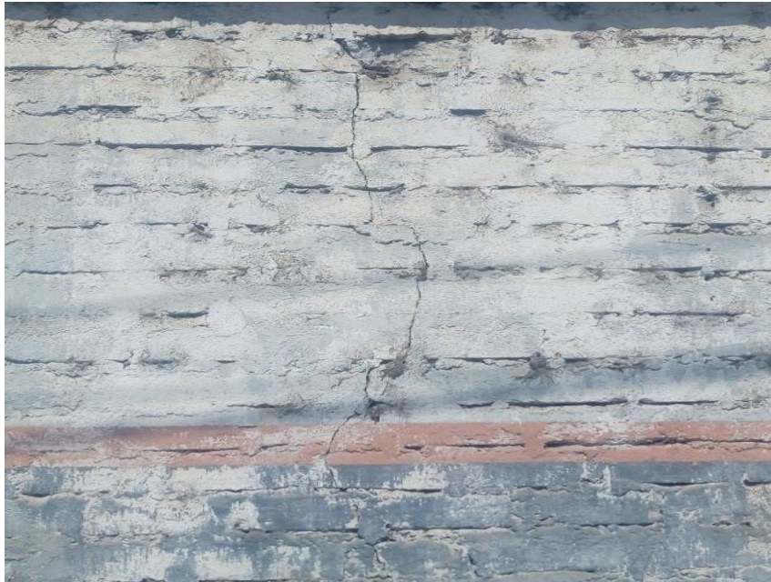
Fotografía 5: Muro de albañilería afectada por la patología tipo grieta en el paño de la unidad de muestra N° 08.
