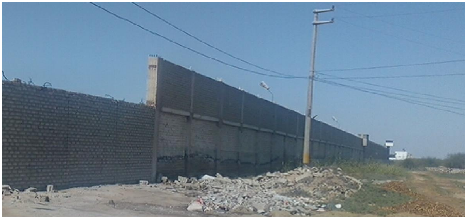
Fotografía 3: Foto panorámica lado posterior del cerco del almacén ubicado en la urbanización Industrial Gran Trapecio, kilómetro 430, carretera Panamericana Norte, distrito de Chimbote, provincia del Santa, región Ancash.
