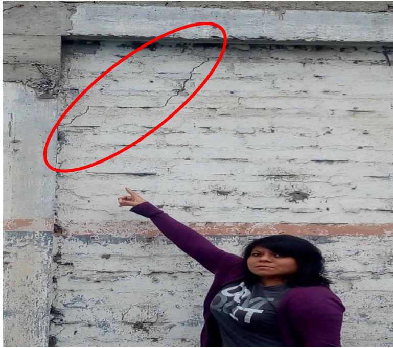
Fotografía 4: Muro de albañilería afectada por la patología tipo grieta en el paño de la unidad de muestra N° 13.
