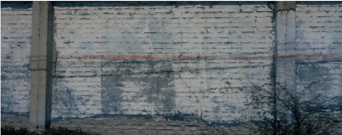
Fotografía 7: Muro de albañilería afectada por la patología tipo fisura en el paño de la unidad de muestra N° 15.
