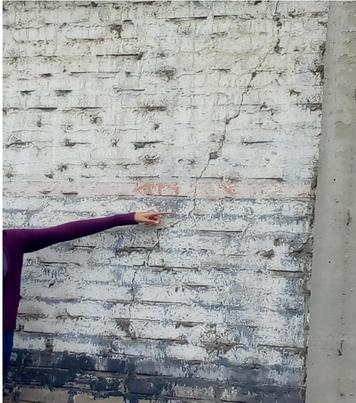
Fotografía 6: Muro de albañilería afectada por la patología tipo fisura en el paño de la unidad de muestra N° 12.
