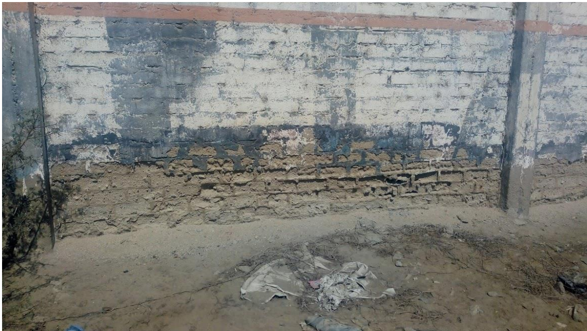
Fotografía 9: Evaluación de la patología erosión en el muro del paño de la unidad de la muestra N° 14.
