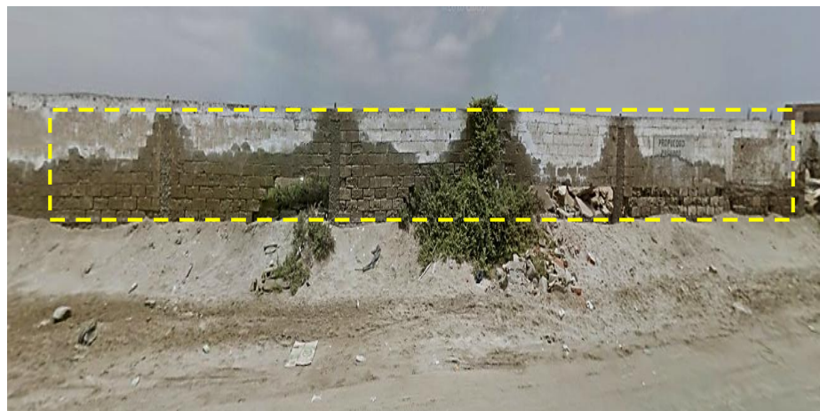
Figura 27: Detalle de muros de albañilería afectadas con patologías de tipo eflorescencia, erosión y desintegración en el cerco del almacén de embarcación de harina y aceite de pescado de la Pesquera TASA – Chimbote.
