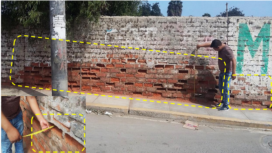
Fotografía 04: Muro de albañilería afectado por la erosión en la Unidad Muestral 01.
