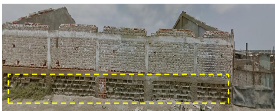
Figura 38: Cerco perimétrico afectado por la humedad excesiva del terreno salitroso (capilaridad) a los muros de albañilería confinada en la parte inferior (erosión química).
