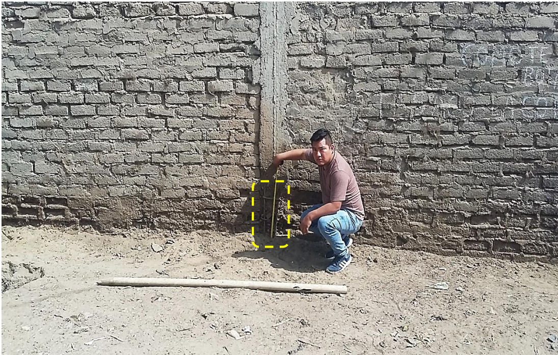
Fotografía 13: Columna de confinamiento afectado en la parte inferior por la corrosión del acero de refuerzo en la Unidad Muestral 21.
