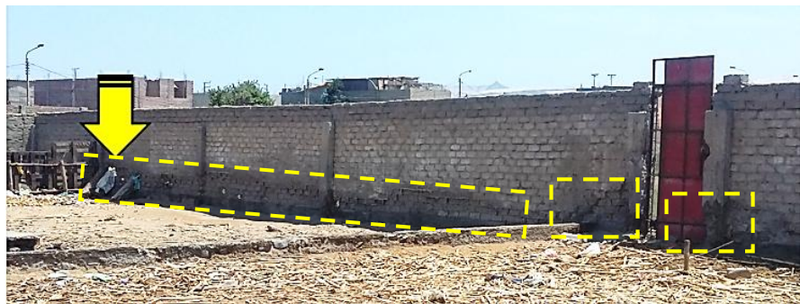
Figura 34: Detalle del cerco perimétrico de albañilería de una parcela afectada por el rozamiento de materiales diversos (erosión mecánica).
