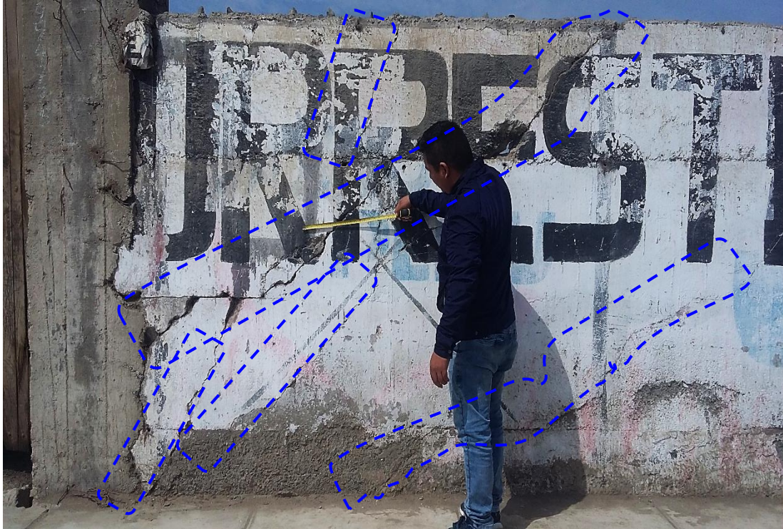
Fotografía 08: Muro de concreto afectado por la grieta en la Unidad Muestral 08.
