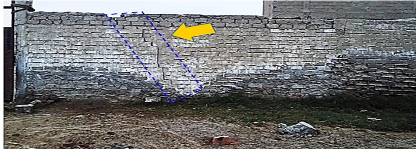
Figura 32: Detalle del cerco perimétrico de albañilería del depósito de chatarra del P.J. San Juan del distrito de Chimbote afectada por la grieta transversal.
