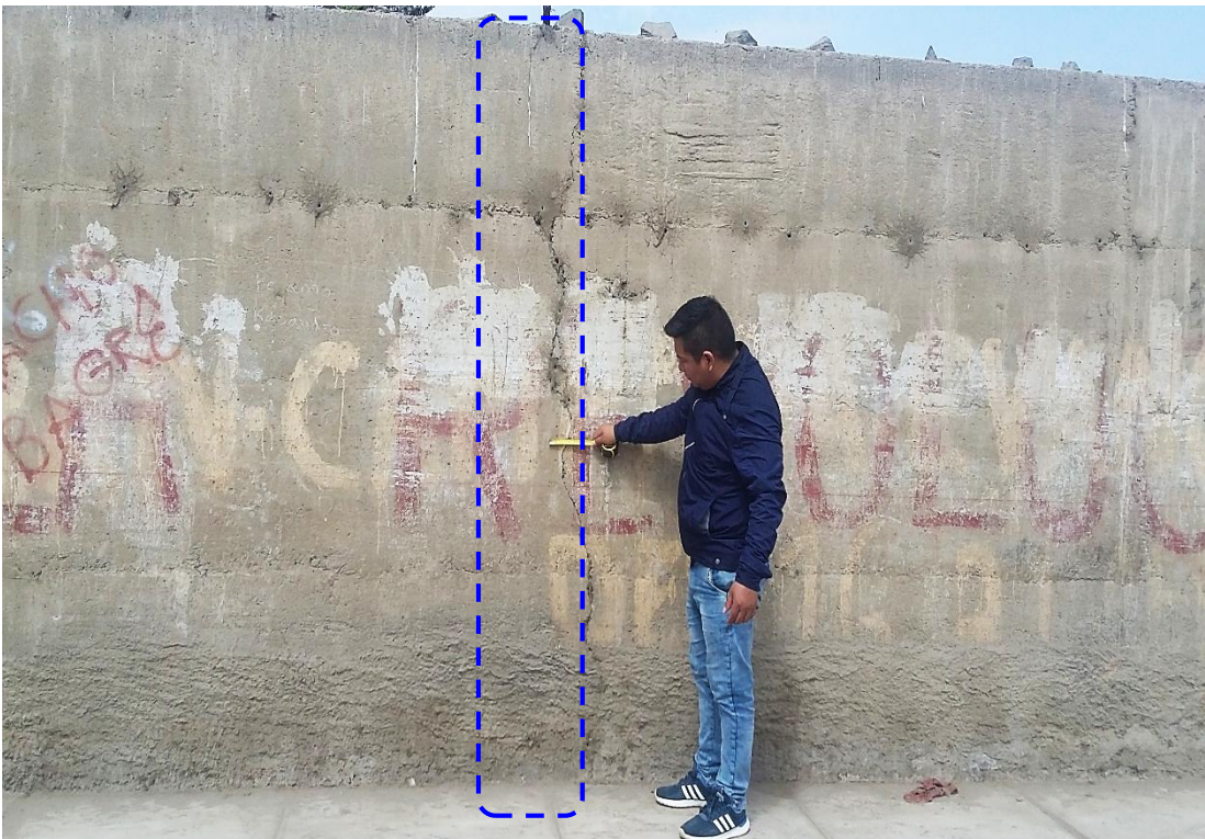
Fotografía 09: Muro de concreto afectado por la grieta en la Unidad Muestral 13.
