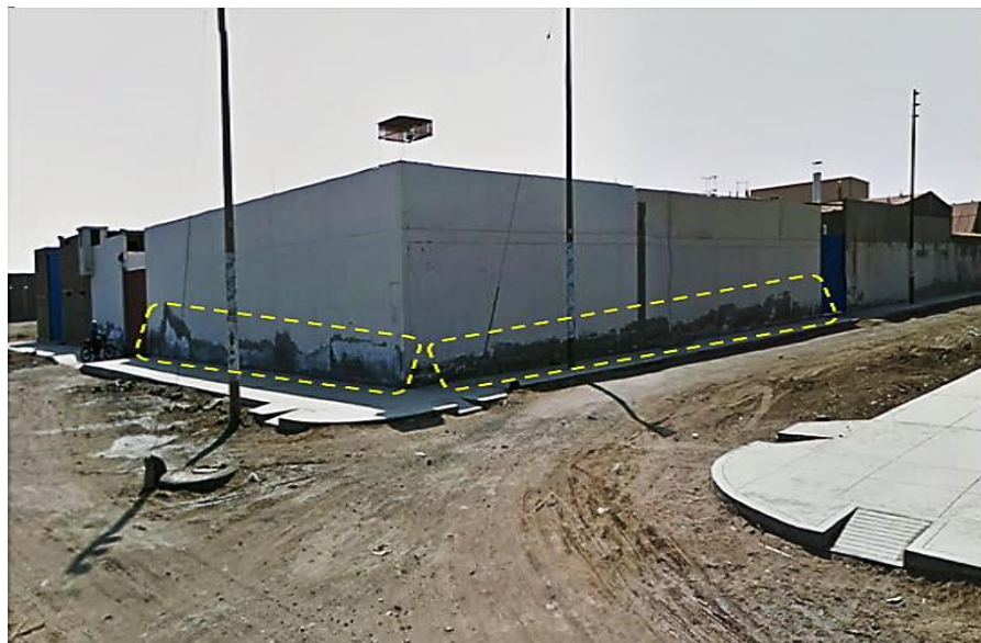
Figura 36: Detalle del cerco perimétrico de albañilería confinada del segundo almacén de Harina de Pescado de la Planta de Procesamiento Pesquero Artesanal Julio Arroyo Castillo afectada con eflorescencias en la parte inferior del muro.
