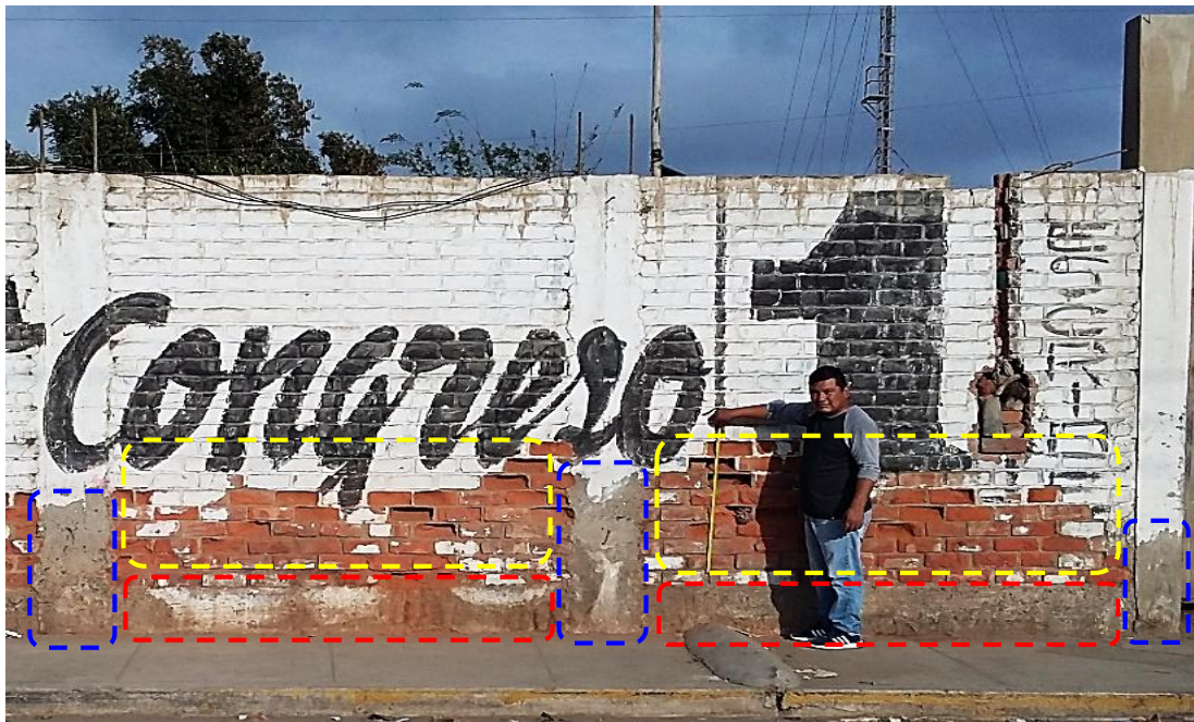
Fotografía 05: Muros de albañilería, columnas de confinamiento y sobrecimientos afectados por la erosión en la Unidad Muestral 04.
