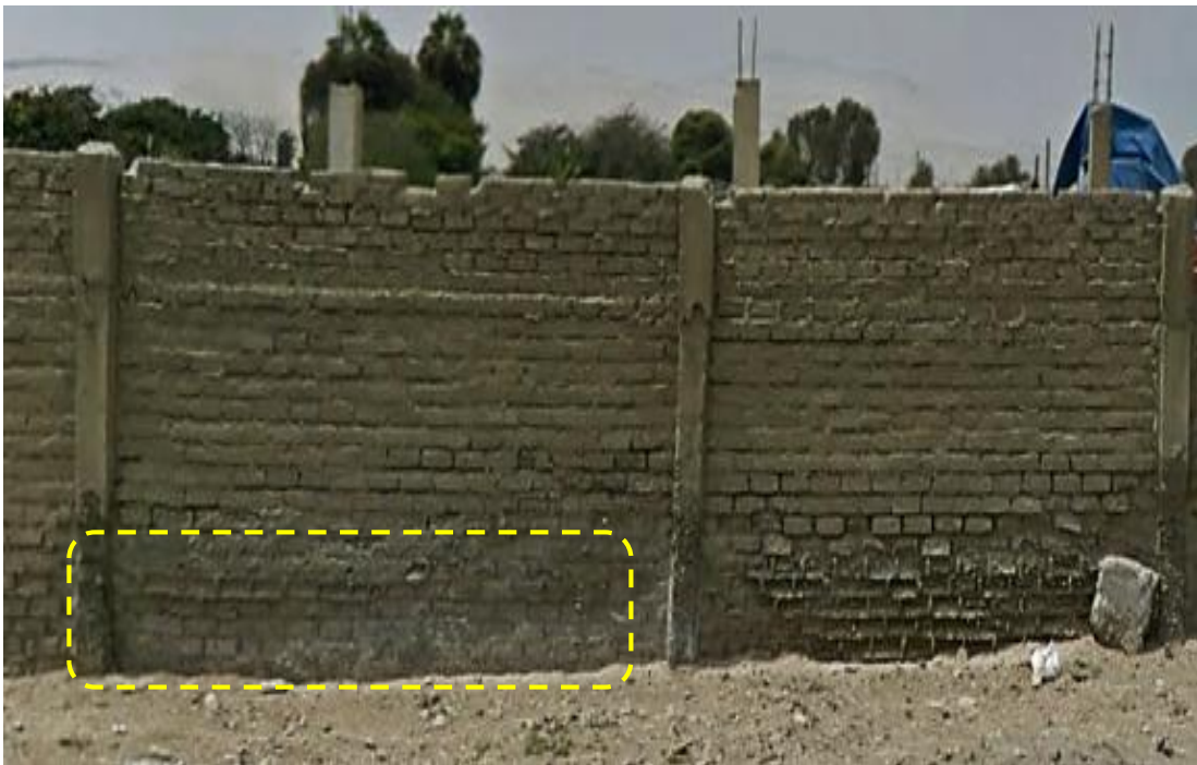
Fotografía 11: Muro de albañilería afectado por la eflorescencia en la Unidad Muestral 20. Presencia de capa fina de manchas blanquecinas con cierta transparencia en la parte inferior del muro.
