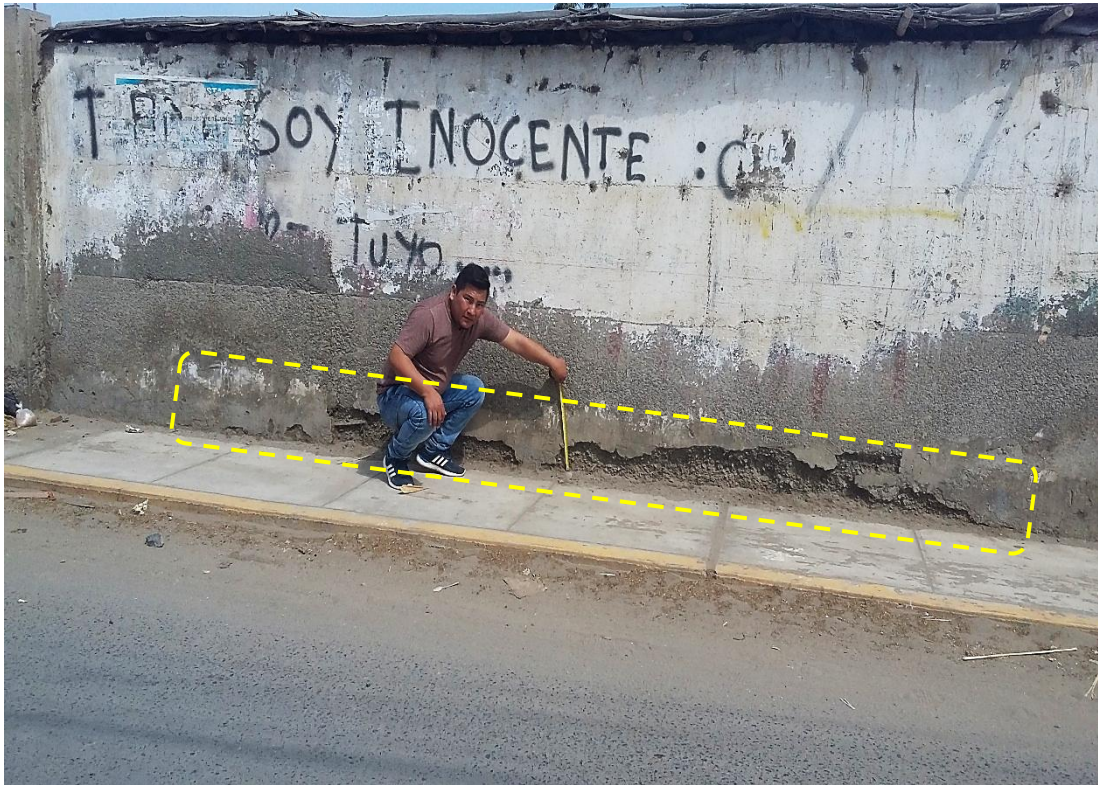
Fotografía 06: Muro de concreto afectado en la parte inferior por el desprendimiento del recubrimiento de concreto en la Unidad Muestral 05.
