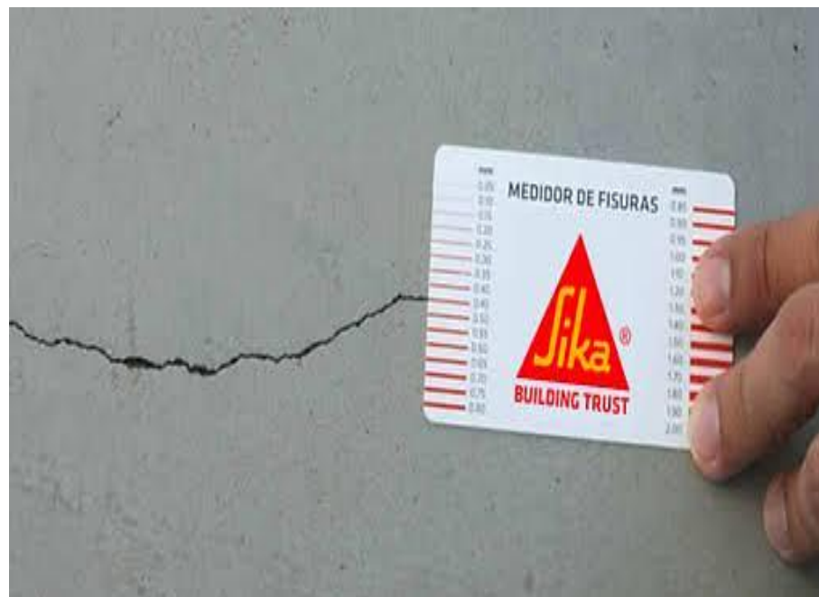
Figura 35: Detalle del acabado del muro de albañilería afectado por la fisura.
