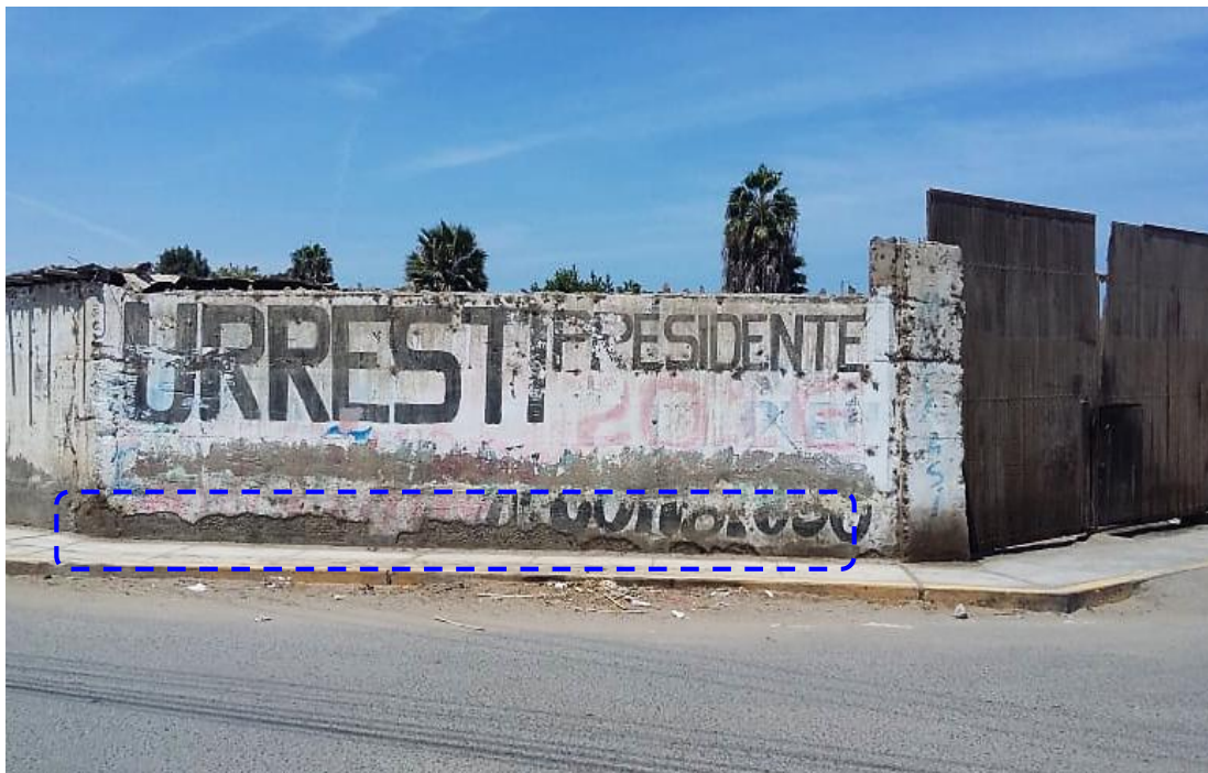
Fotografía 07: Muro de concreto afectado en la parte inferior por el desprendimiento del recubrimiento de concreto en la Unidad Muestral 06.
