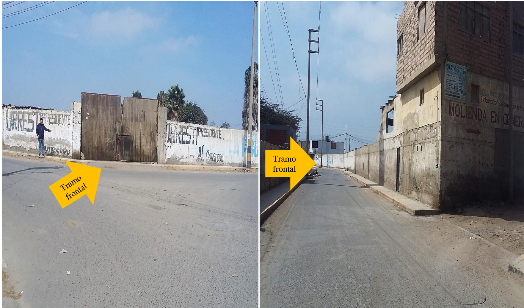
Fotografía 02: Tramo frontal evaluado del cerco del Molino Santo Domingo del Asentamiento Humano Santo Domingo, distrito de Chimbote, provincia del Santa, región Áncash.
