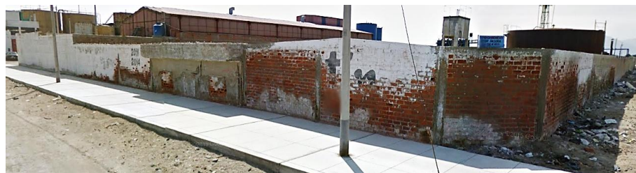
Figura 31: Tramo lateral y frontal del cerco perimétrico de la Empresa Inversiones Regal S.A.C. en Villa María – Nuevo Chimbote, afectado por el spray marino o brisa marina (erosión física).
