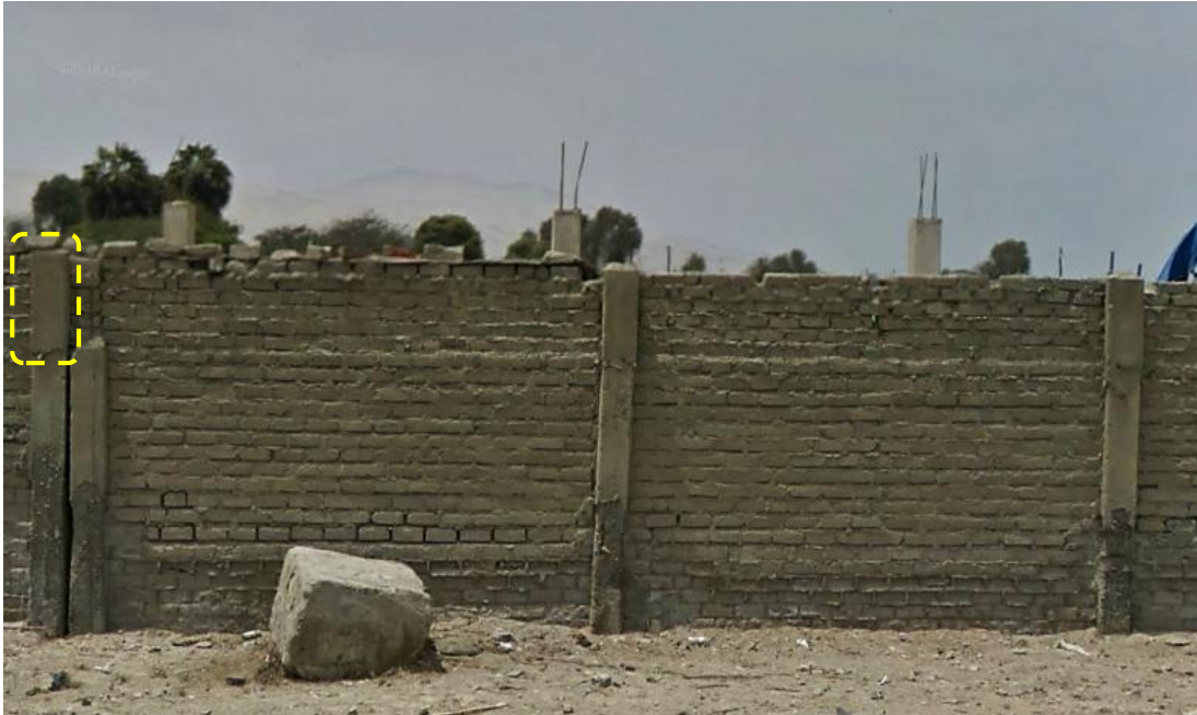
Fotografía 12: Columna de confinamiento afectado en la parte superior por la corrosión del acero de refuerzo en la Unidad Muestral 19.
