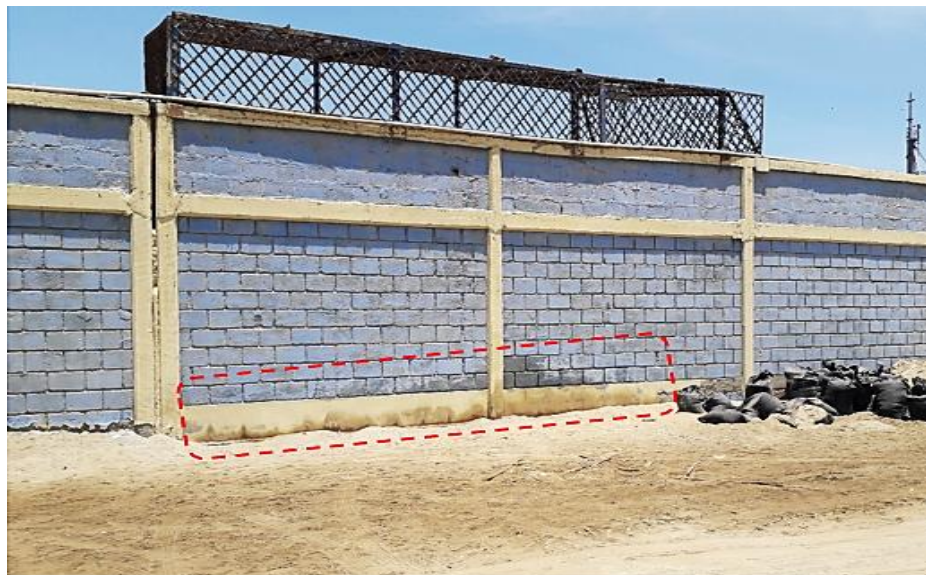
Figura 26: Detalle del inicio de la aparición de la eflorescencia producido por la humedad existente en el terreno natural del cerco perimétrico de la Empresa Sima Chimbote Astilleros del distrito de Chimbote.
