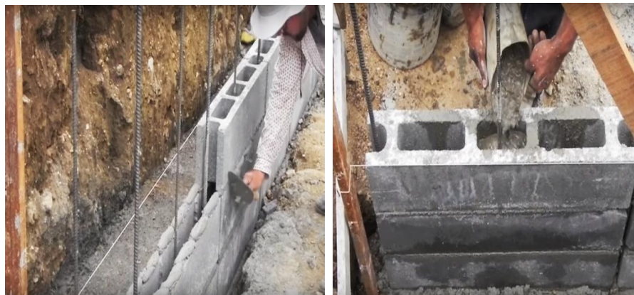
Figura 22: Detalle de refuerzos en los muros en la dirección vertical y horizontal tanto en bloques de concreto como en arcilla.
