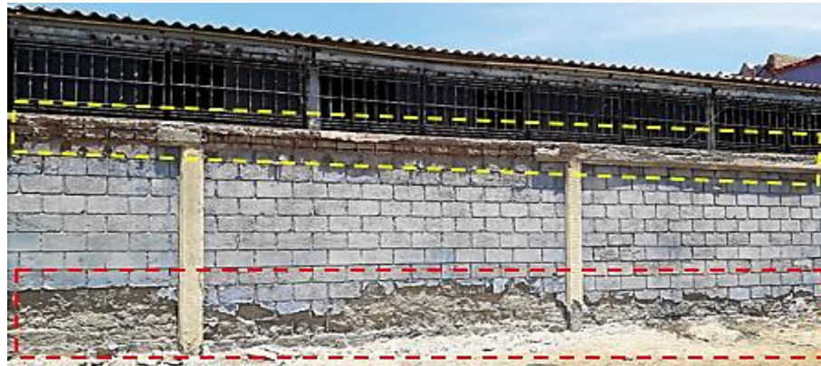
Figura 30: Detalle del cerco perimétrico de albañilería confinada mostrando carencia de seguridad, funcionalidad y estética de sus elementos de confinamiento y albañilería.
