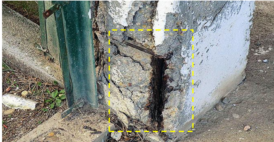
Figura 33: Detalle del desprendimiento del revestimiento del concreto de la columna por empuje del refuerzo oxidado.
