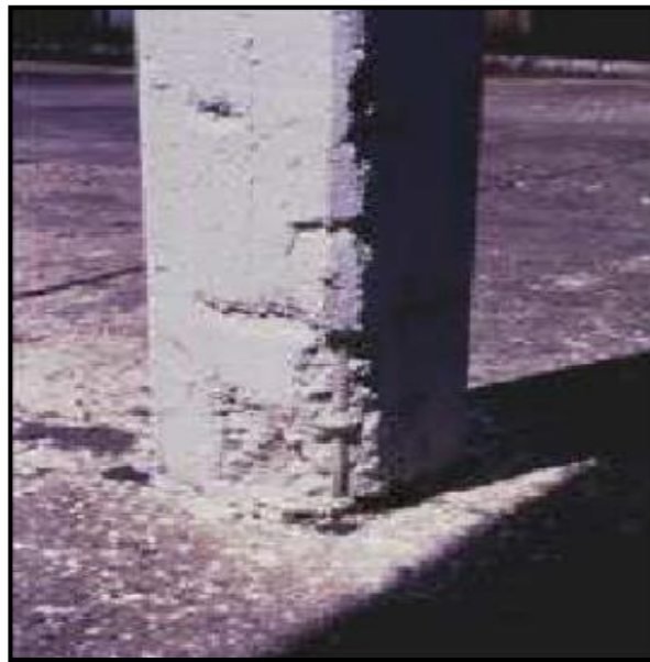
Gráfico 11. Corrosión en columnas.
