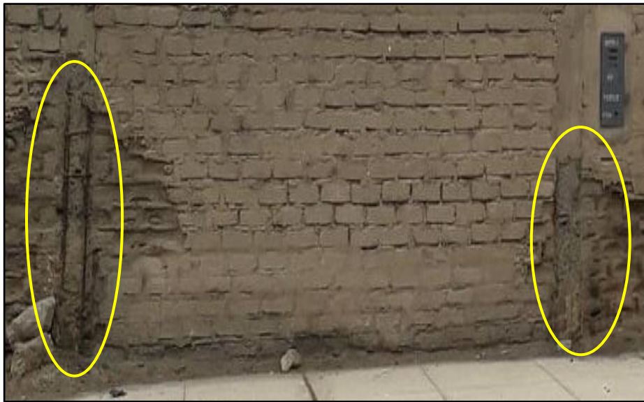
Imagen 05: Unidad muestral 01, presencia de corrosión en las columnas.
