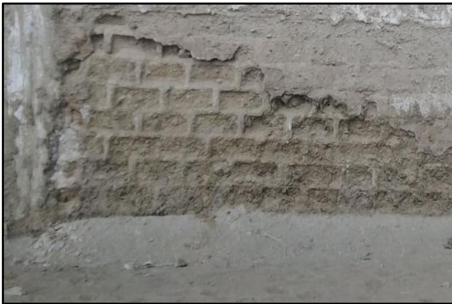
Imagen 08: Unidad muestral 12, presencia de desprendimiento en los muros.
