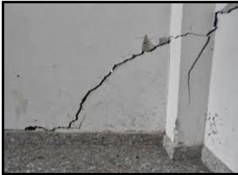
Gráfico 9. Grieta de tracción diagonal en muros.
