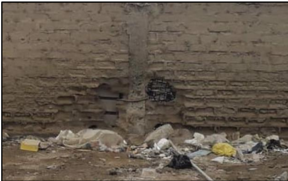
Imagen 12: Unidad muestral 21, presencia de erosión en la columna y muro.
