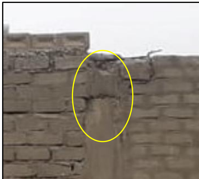
Imagen 16: Unidad muestral 05, presencia de grieta en la columna
