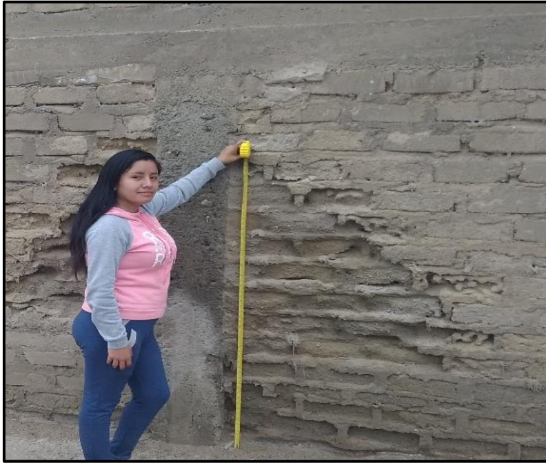
Imagen 07: Unidad muestral 04, presencia de desprendimiento en los muros.
