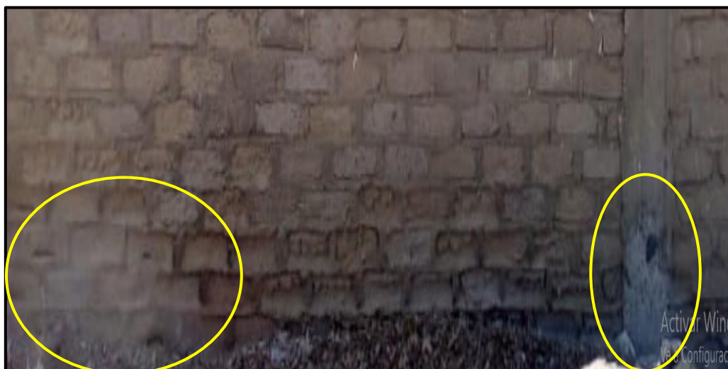
Imagen 10: Unidad muestral 07, presencia de eflorescencia en columna y muro.
