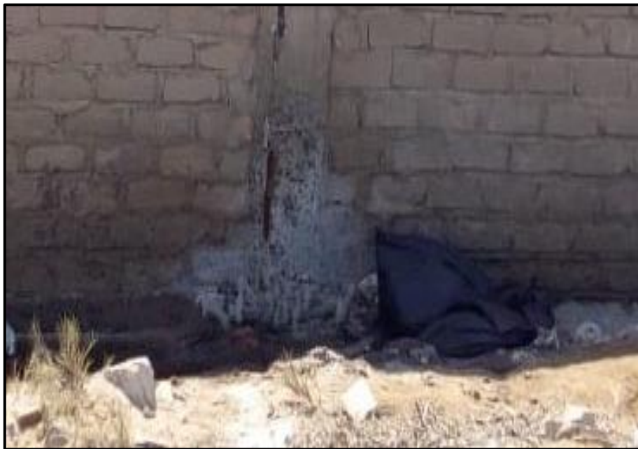
Imagen 09: Unidad muestral 06, presencia de eflorescencia en columna y muro.
