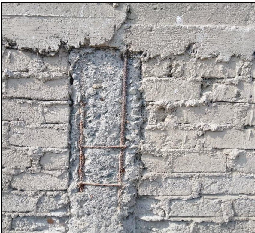
Imagen 06: Unidad muestral 05, presencia de corrosión en la columna.
