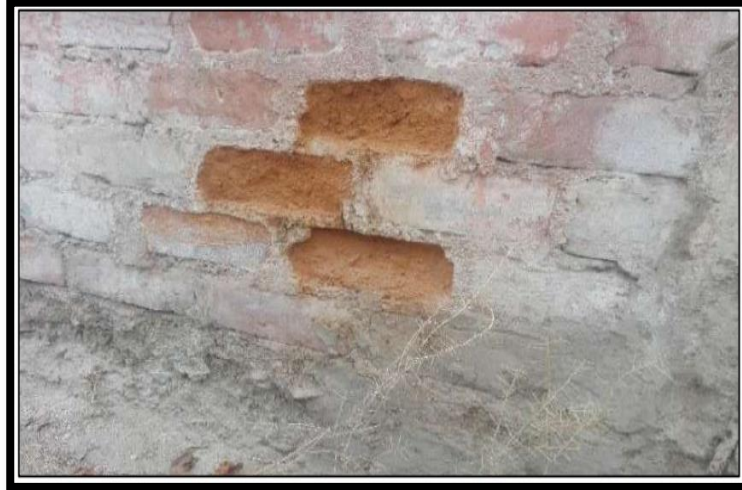
Gráfico 6. Muro con erosión de un cerco perimétrico.
