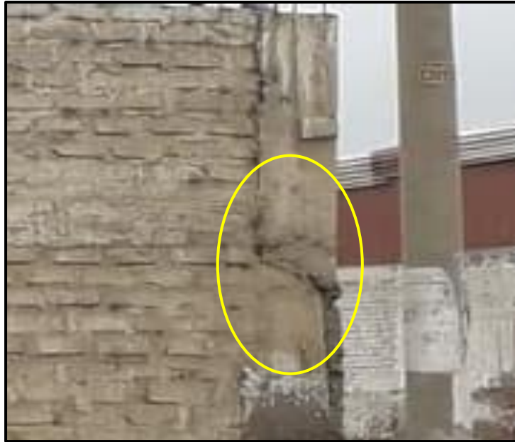
Imagen 15: Unidad muestraL 01, presencia de grieta en la columna
