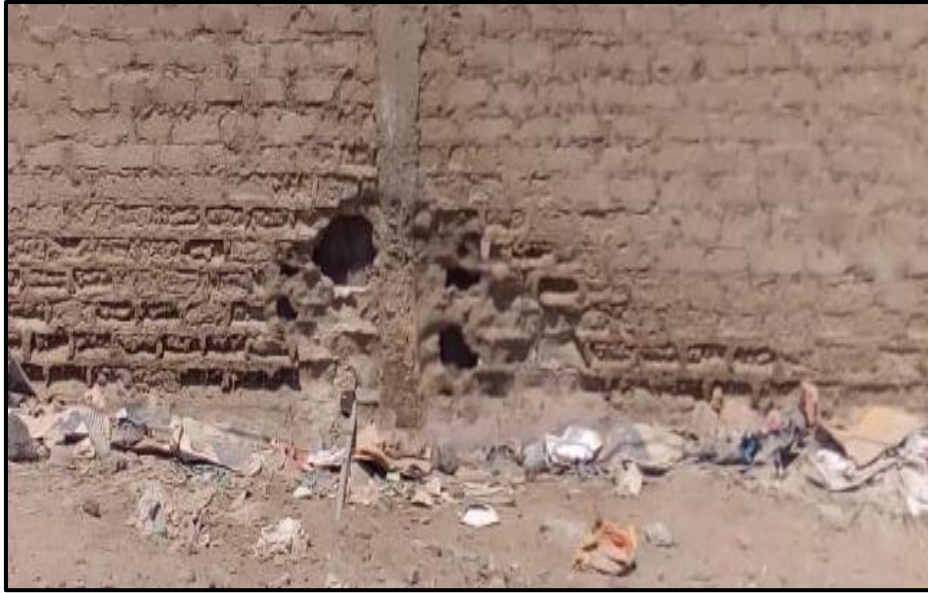
Imagen 11: Unidad muestral 11, presencia de erosión en la columna y muro.
