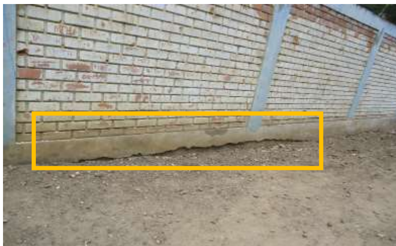
Gráfico 23: sobre cimiento afectada por desprendimiento
