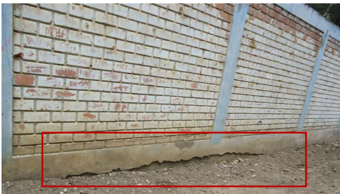
Gráfico 94: sobre cemento afectada por desprendimiento en la unidad de muestra 11.
