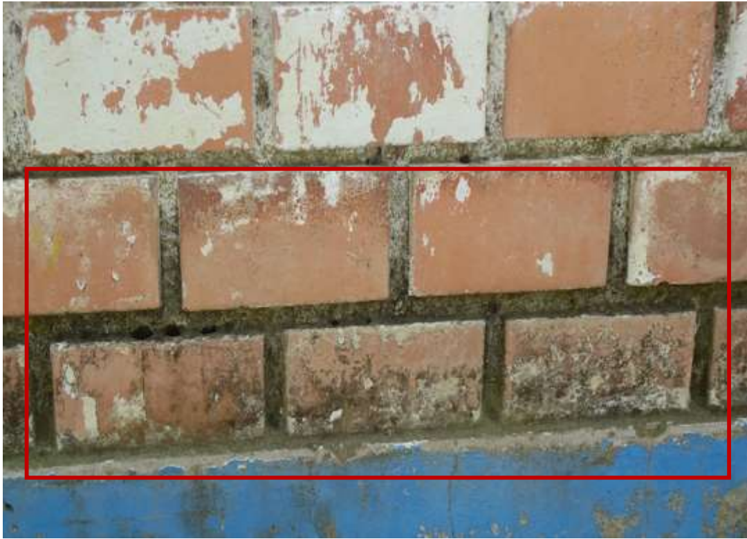
Gráfico 91: Muros afectadas por eflorescencia en la unidad de muestra 2.
