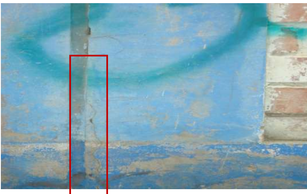
Gráfico 96: sobrecimiento afectadas por fisuras en la unidad de muestra 2.
