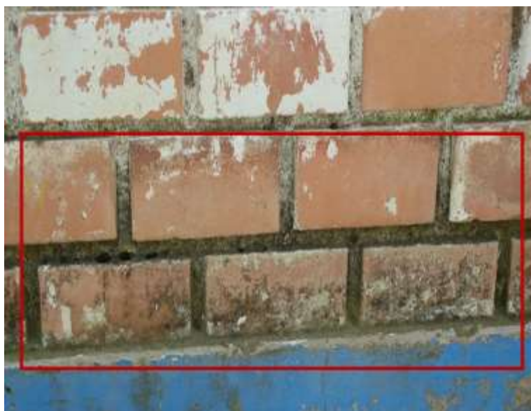
Gráfico 26: muro afectado por la eflorescencia.
