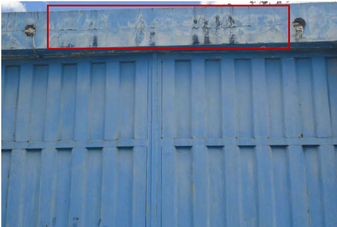
Gráfico 98: columnas afectadas por desconchamiento en la unidad de muestra 6.
