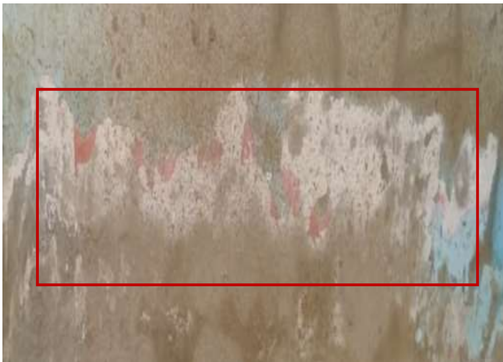
Gráfico 92: Sobrecimiento afectadas por eflorescencia en la unidad de muestra 6.
