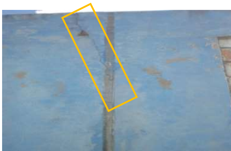
Gráfico 24: fisura en columnas.
