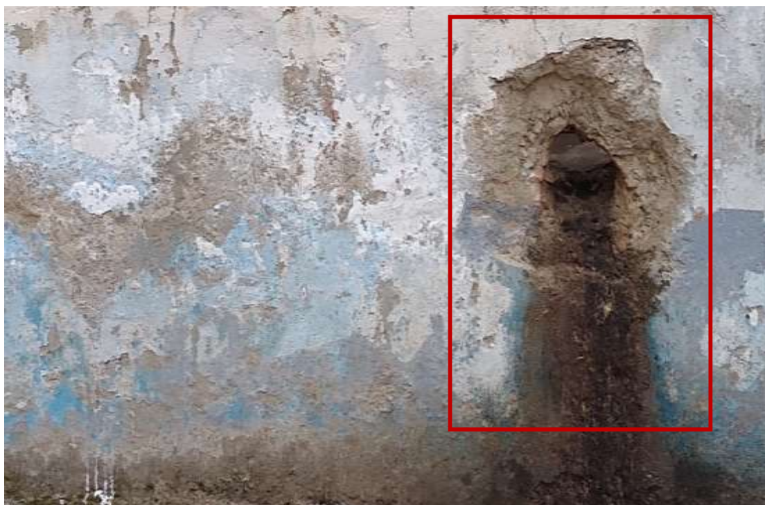
Gráfico 93: Sobrecimiento afectadas por desprendimiento en la unidad de muestra 12.
