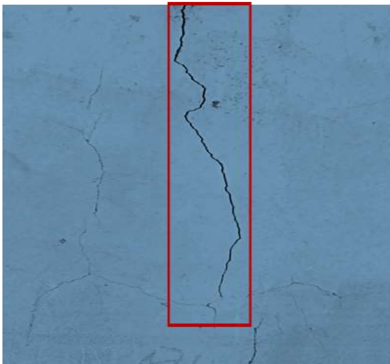
Gráfico 25: grietas en columnas.
