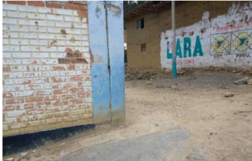
Gráfico 21: patologías en muros de albañilería
