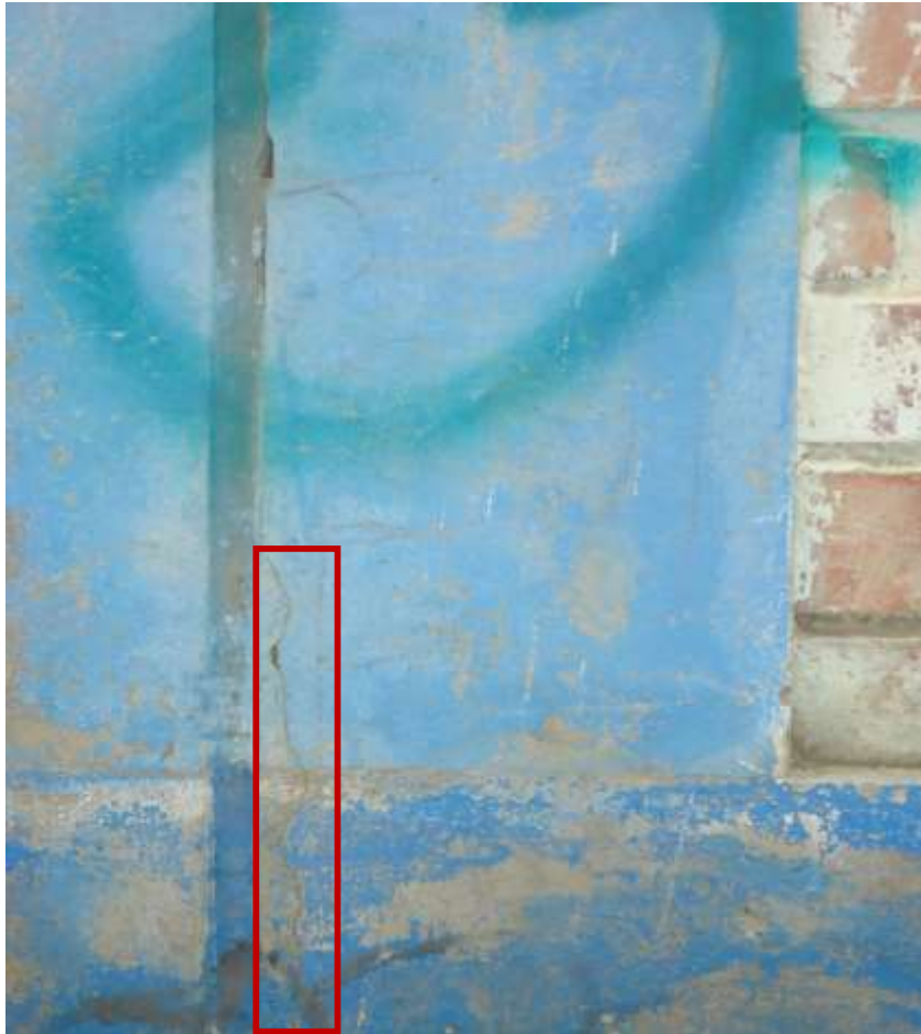
Gráfico 101: Fisura en columna.
