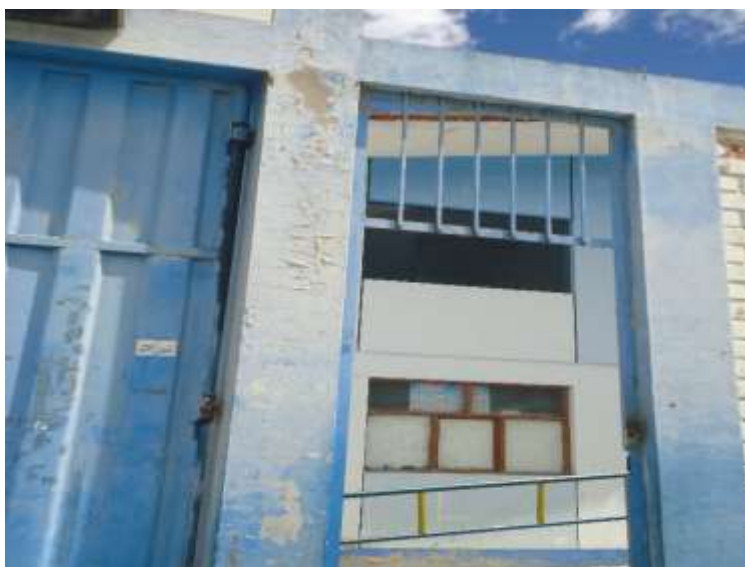
Gráfico 22: desconchamiento en muros de albañilería
