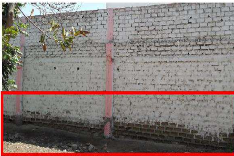
Gráfico 28: Muros afectados por erosión.
