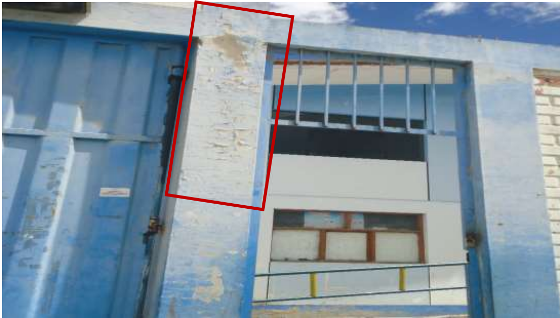
Gráfico 97: vigas y columnas afectadas por desconchamiento en la unidad de muestra 6.
