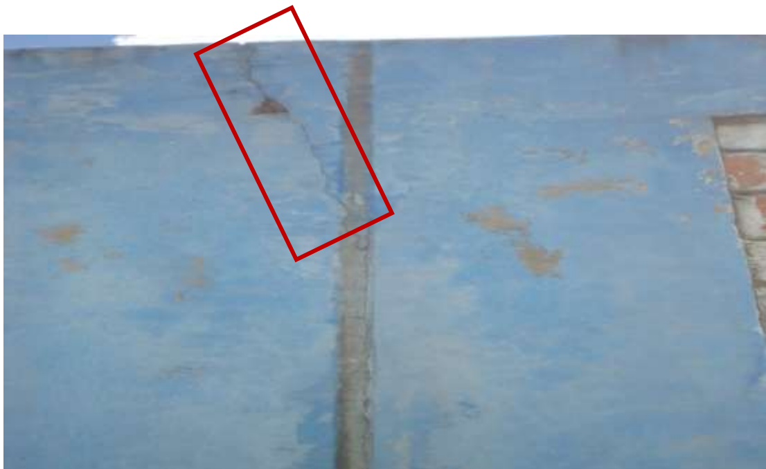
Gráfico 89: Columnas afectadas por Grietas en la unidad de muestra 2.
