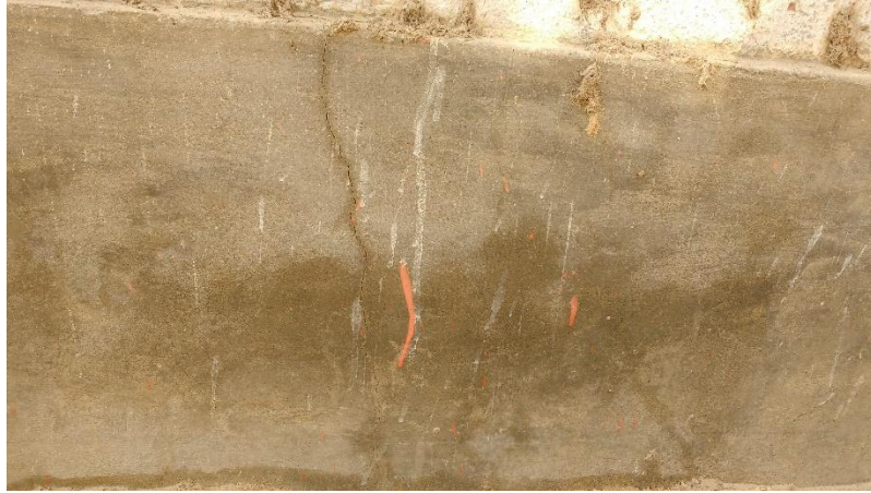
Figura 10. Imagen de fisuras en muros
