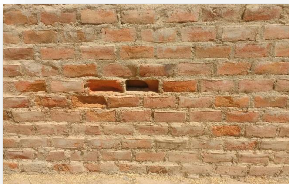
Figura 08. Imagen de erosión en los muros
