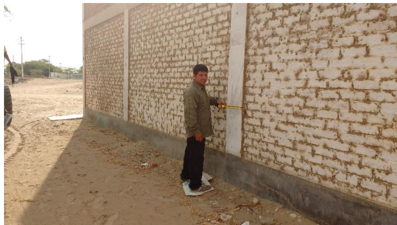
Figura 09. Imagen de suciedad en paredes
