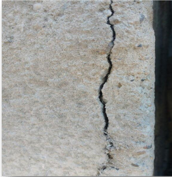
Figura 12. Imagen de grieta en muros
