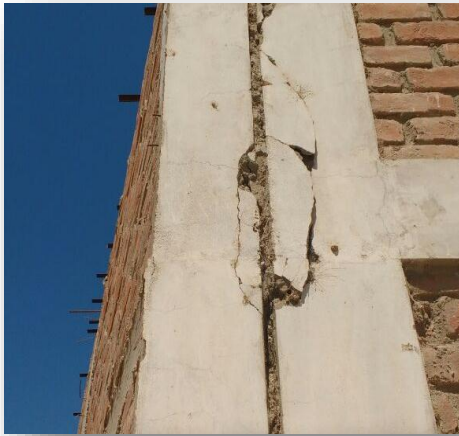
Figura 13. Imagen de Descascaramiento del concreto.
