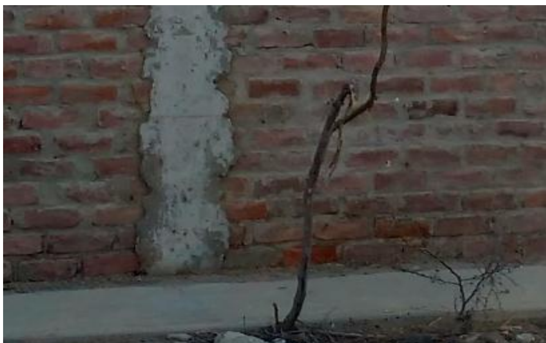
Fotografía 02: erosión en muro del cerco perimétrico del Centro de Acopio.
