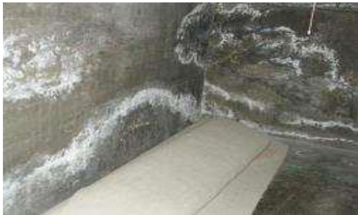
Figura 11. Imagen de eflorescencia en las paredes. Fuente: Google
