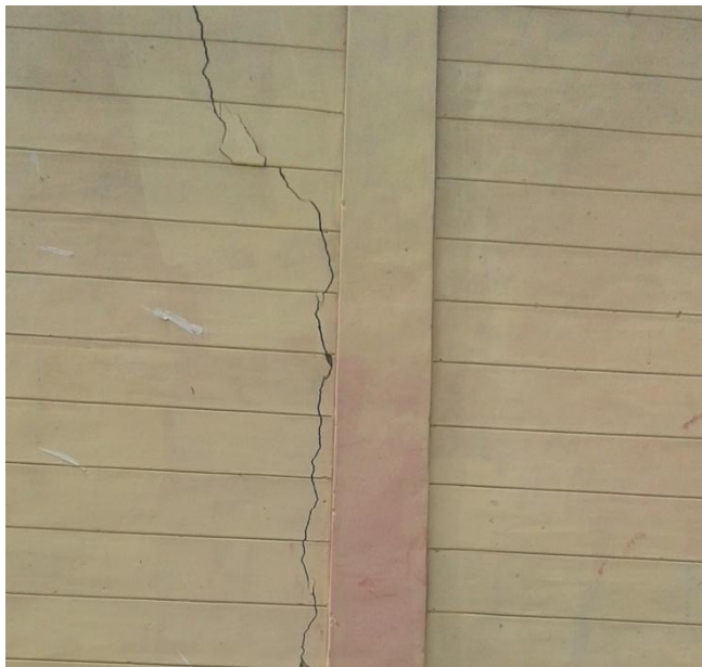
Figura 3: Grieta en muro. Fuente: Autor
