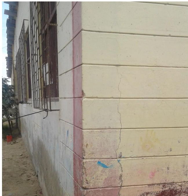
Figura 4: Fisura. Fuente: Autor
