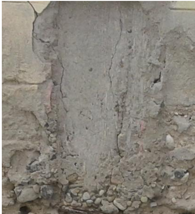
Figura 5: Desprendimiento de tarrajeo en columna. Fuente: Autor
