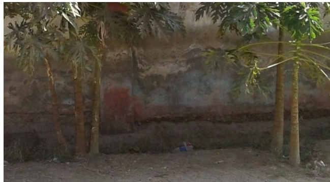
Figura 7: Eflorescencias. Fuente: Autor
