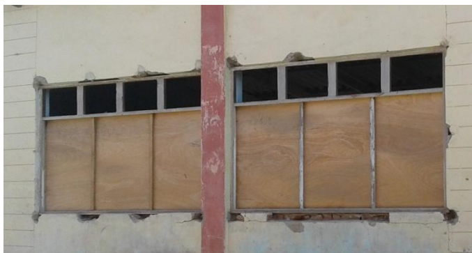
Figura 6: Erosión mecánica por golpe. Fuente: Autor
