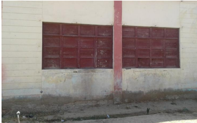
Figura 1: Humedad por capilaridad. Fuente: Autor
