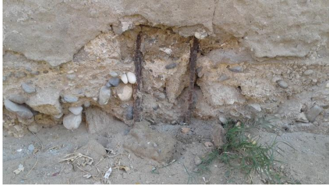
Figura 8: Corrosión en columna. Fuente: Autor
