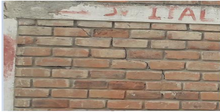
Gráfico 12: Muro de albañilería afectado por las grietas. Fuente: Tafur.
