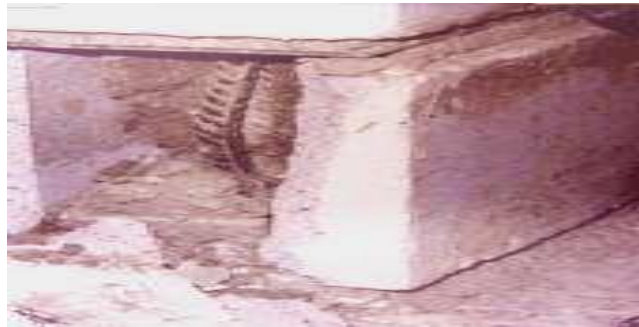
Gráfico 16: Corrosión en acero.
