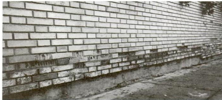
1.5. Graves daños en un muro ocasionados por la eflorescencia. Las unidades tenían un elevado contenido de sales y la construcción de albañilería estaba en contacto con la humedad. Nótese que la destrucción ha ocurrido en la zona baja húmeda.
