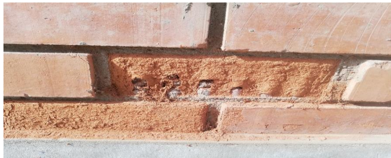
Gráfico 13: Desprendimiento en el ladrillo.
