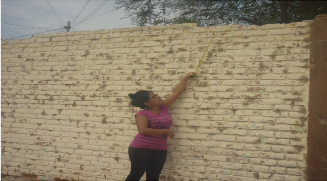
Gráfico 101: Patología Desintegración en muro.
