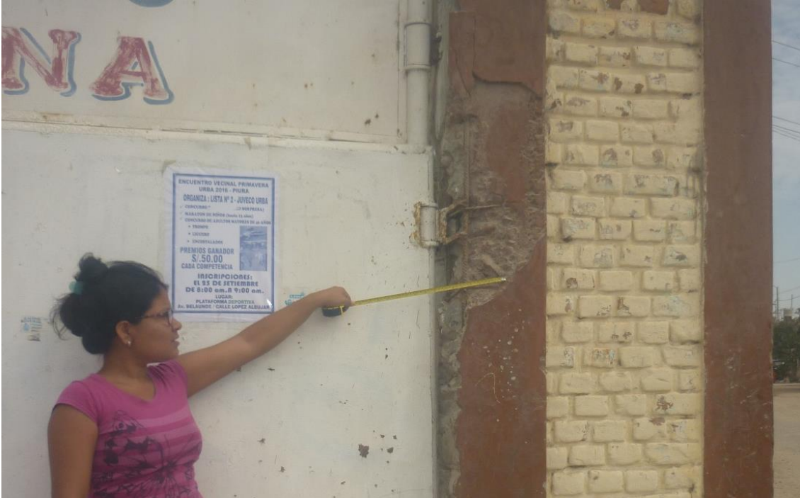
Gráfico 102: Patología Oxidación y Corrosión en columna.
