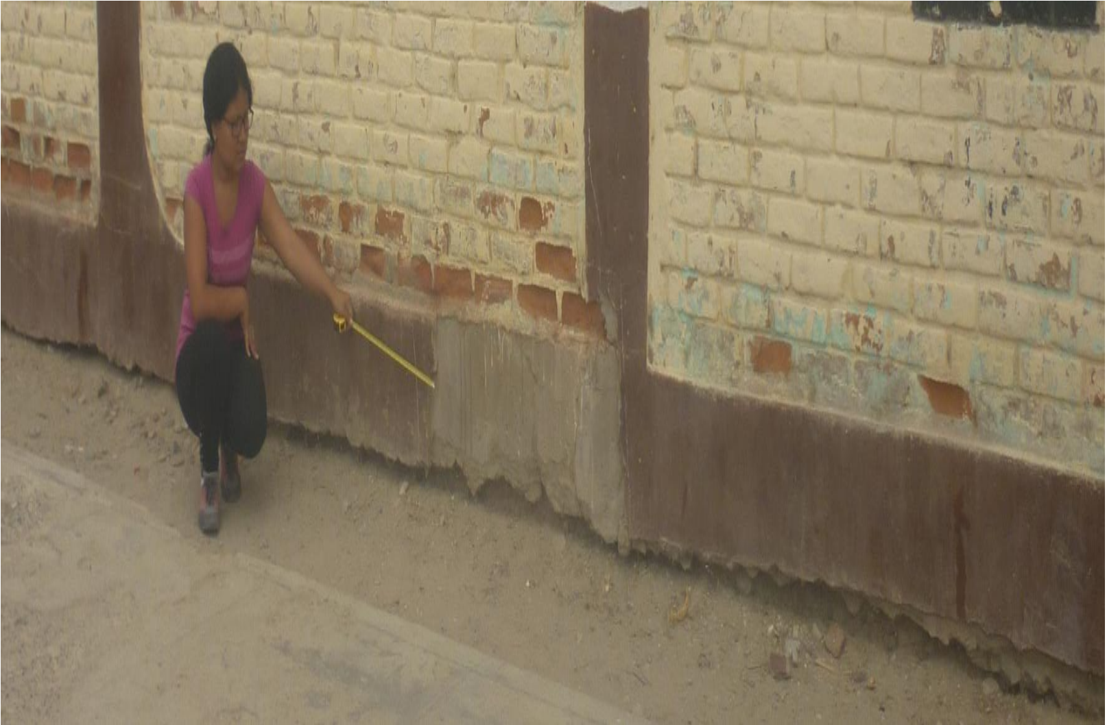
Gráfico 98: Patología Desprendimiento en sobrecimiento.
