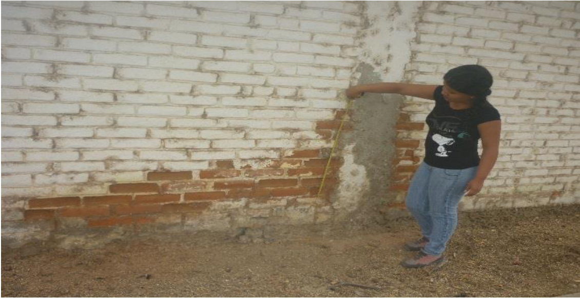
Gráfico 99: Patología Eflorescencia en columna y Erosión Física en muro.
