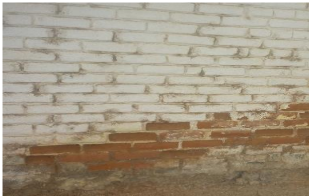
Gráfico 11: Patología en albañilería confinada.- Fuente:
