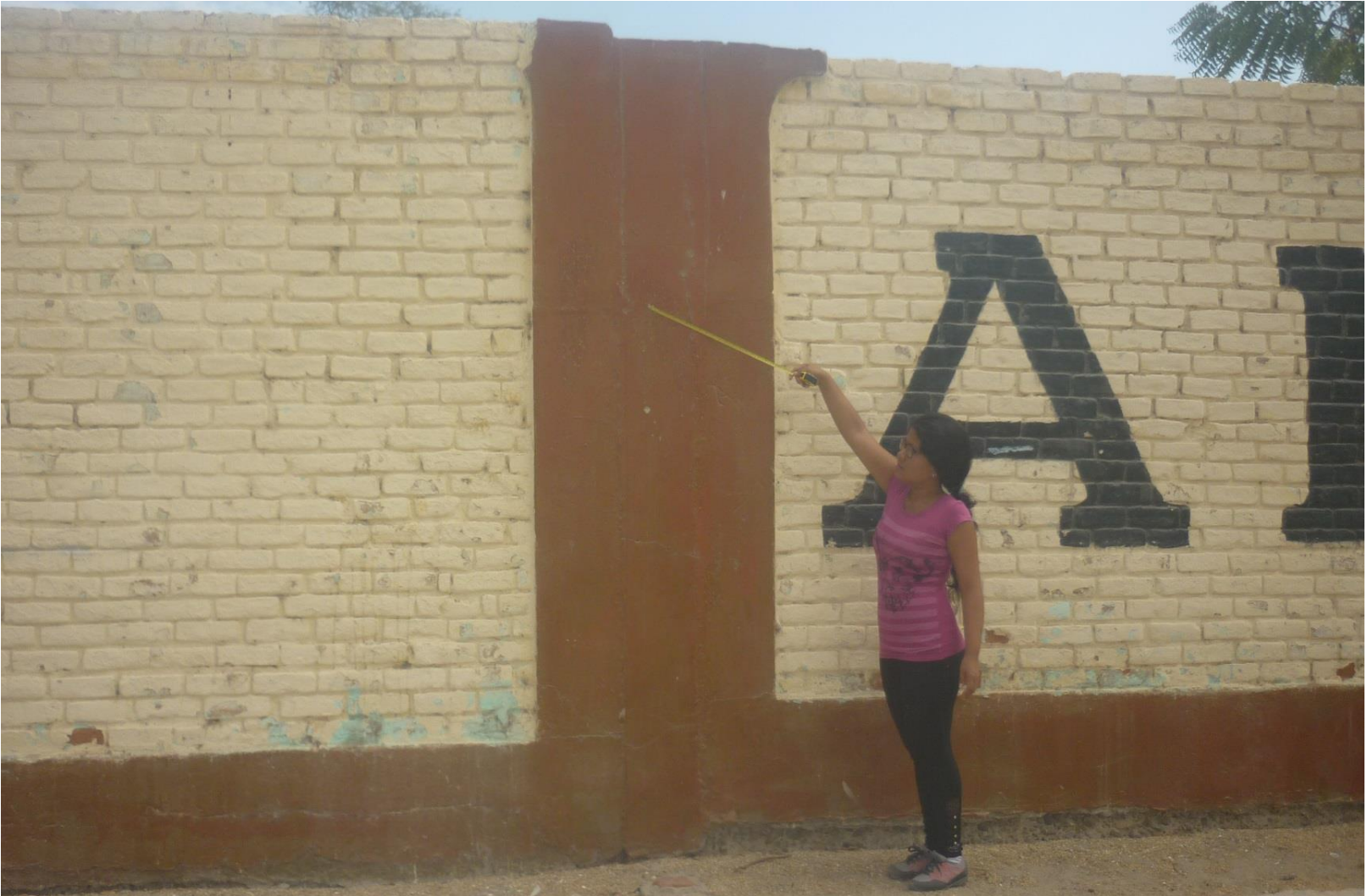
Gráfico 97: Patología Grieta en columna y en sobrecimiento.
