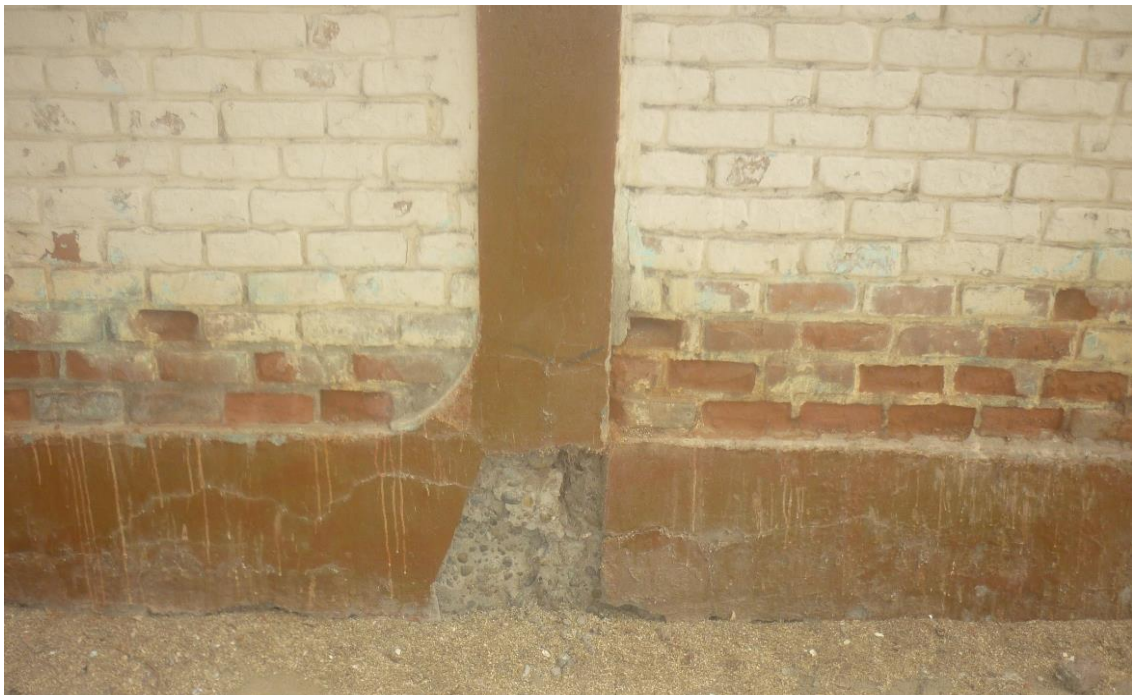
Gráfico 104: Patología Desprendimiento en columna, Erosión Física en muro y Grietas en sobrecimiento
