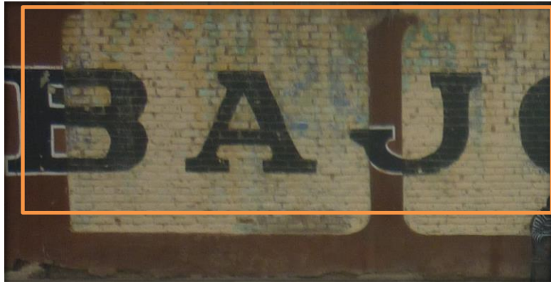
Gráfico 21: Presencia de Eflorescencia.- Fuente:
