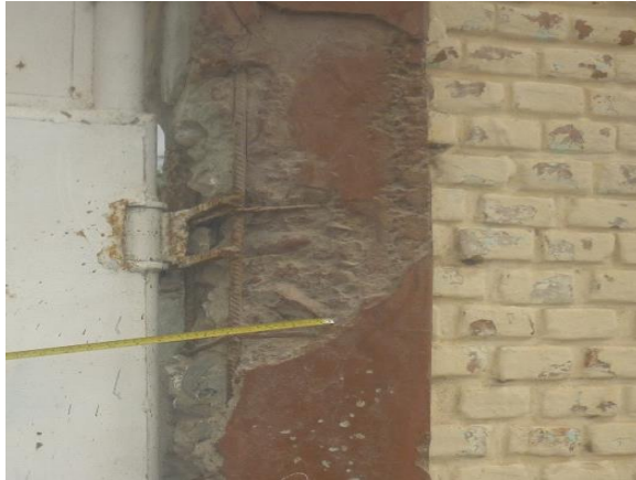
Gráfico 110: Patología Oxidación y Corrosión
