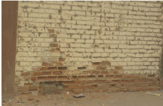
Gráfico 106: Patología Erosión Física
