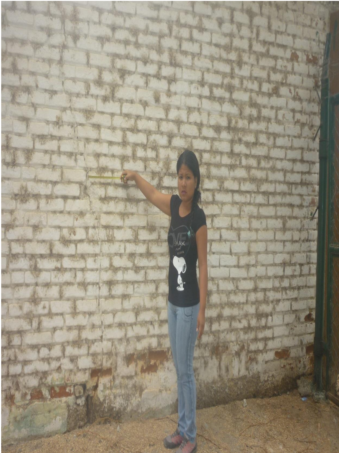
Gráfico 105: Patología Grieta en muro.
