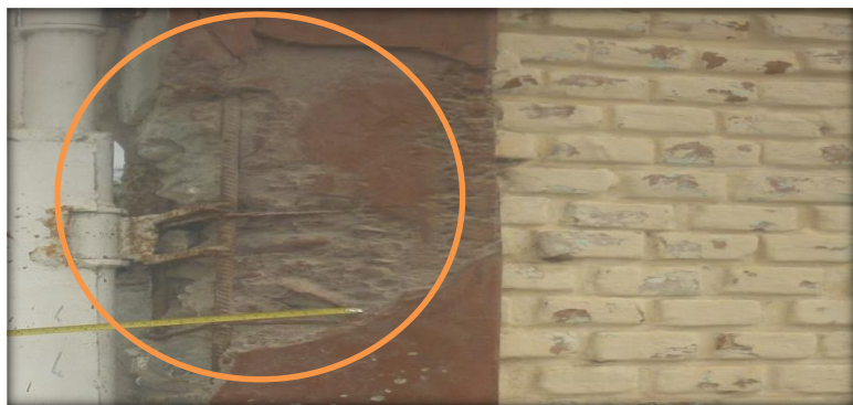
Gráfico 22: Presencia de Oxidación y Corrosión.- Fuente:
