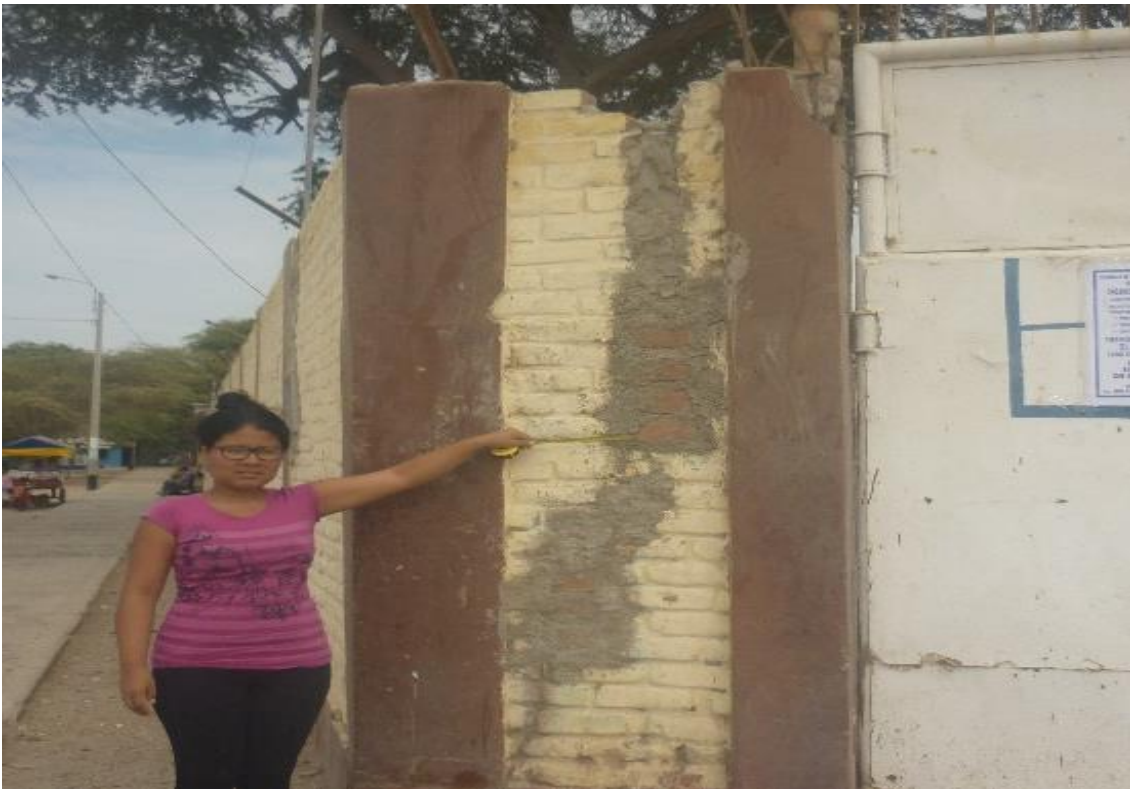
Gráfico 100: Patología Eflorescencia en muro.
