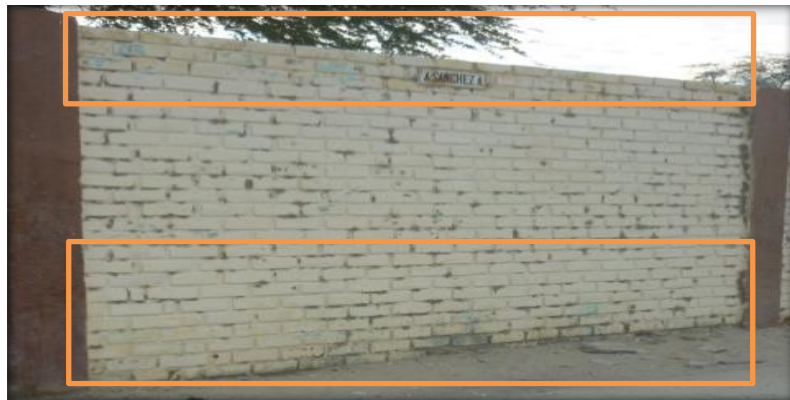
Gráfico 12: Presencia de Humedad.- Fuente: Elaboración propia
