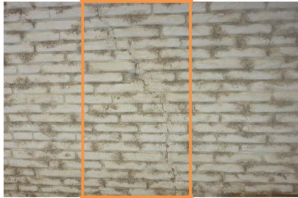
Gráfico 16: Presencia de Grieta.- Fuente: Elaboración propia (2016)
