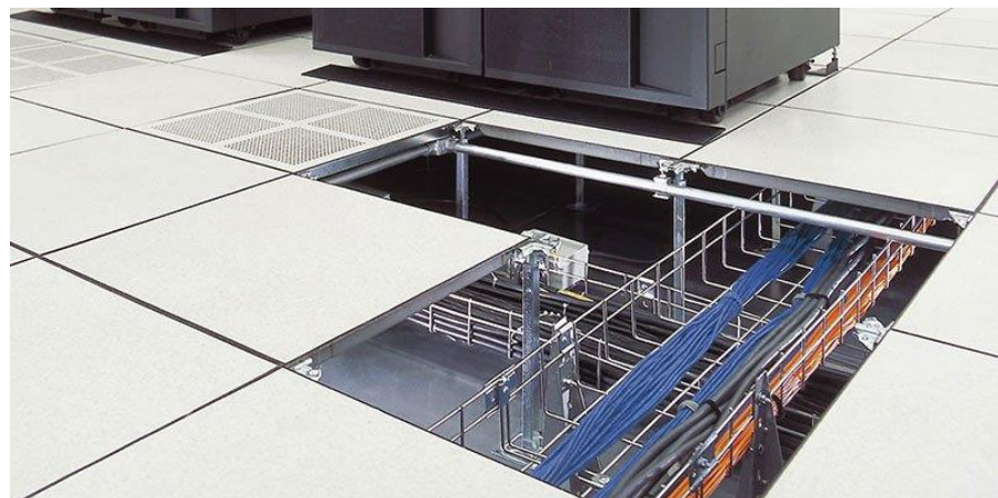
Gráfico Nro. 4: Piso técnico de un Data Center
