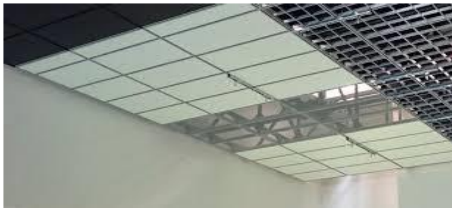
Gráfico Nro. 5: Cielo raso para Data Center
