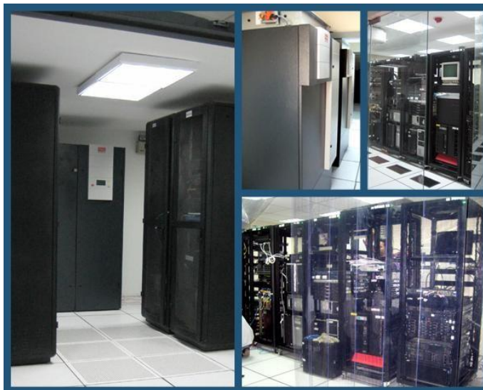
Gráfico Nro. 7: Sala de equipos
