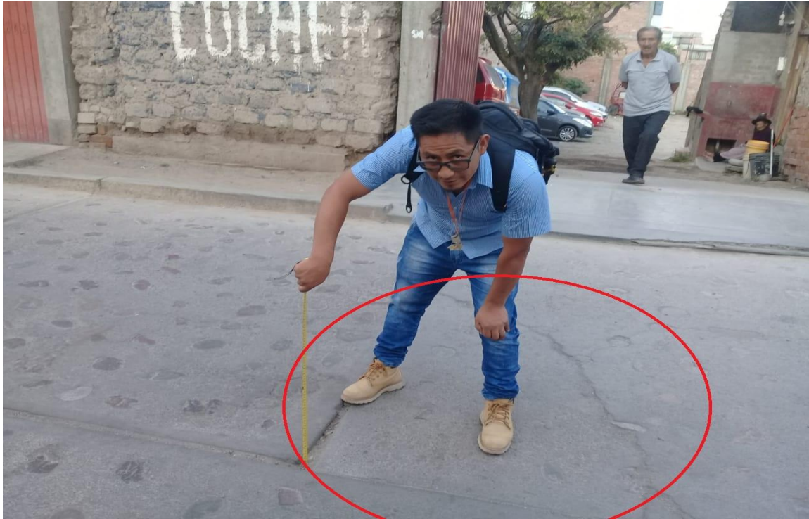
Figura 05: Jr. Sucre muestra n° 05 tipo de falla descascamiento de junta.
