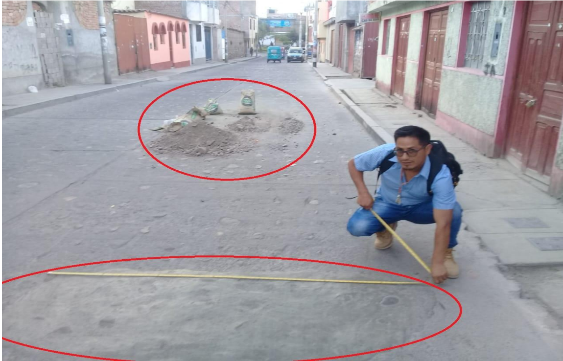
Figura 03: Jr. Sucre muestra n° 03 tipo de falla Parcheo grande.
