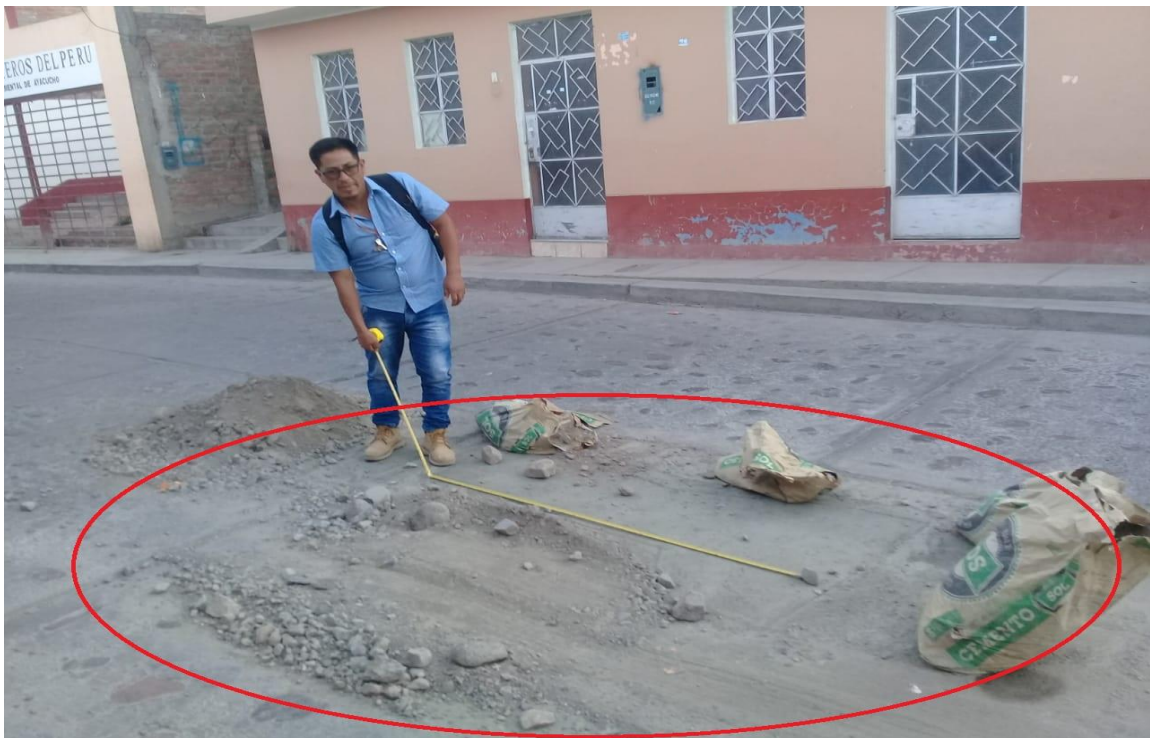
Figura 06: Jr. Sucre muestra n° 05 tipo de falla Parcheo grande.
