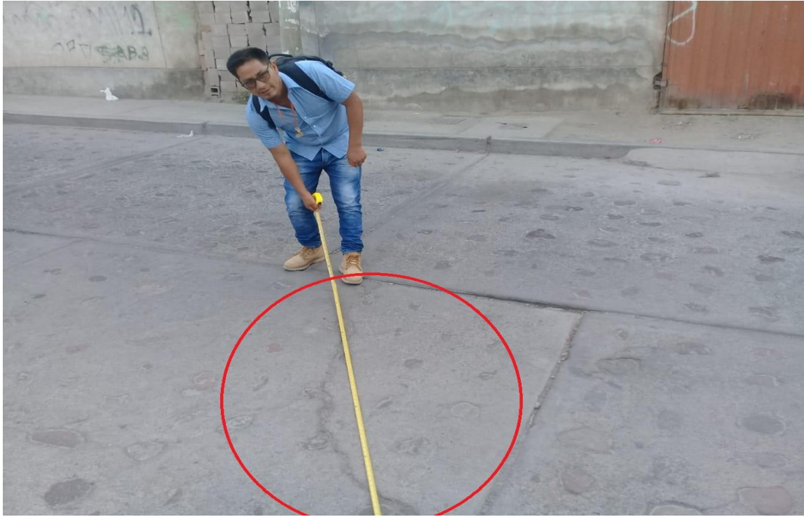
Figura 01: Jr. Sucre muestra n° 01 tipo de falla Grieta de esquina.
