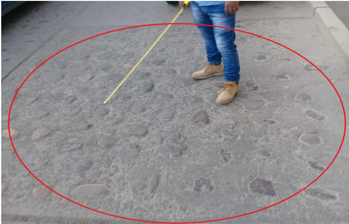
Figura 02: Jr. Sucre muestra n° 02 tipo de falla Pulimento de agregado.
