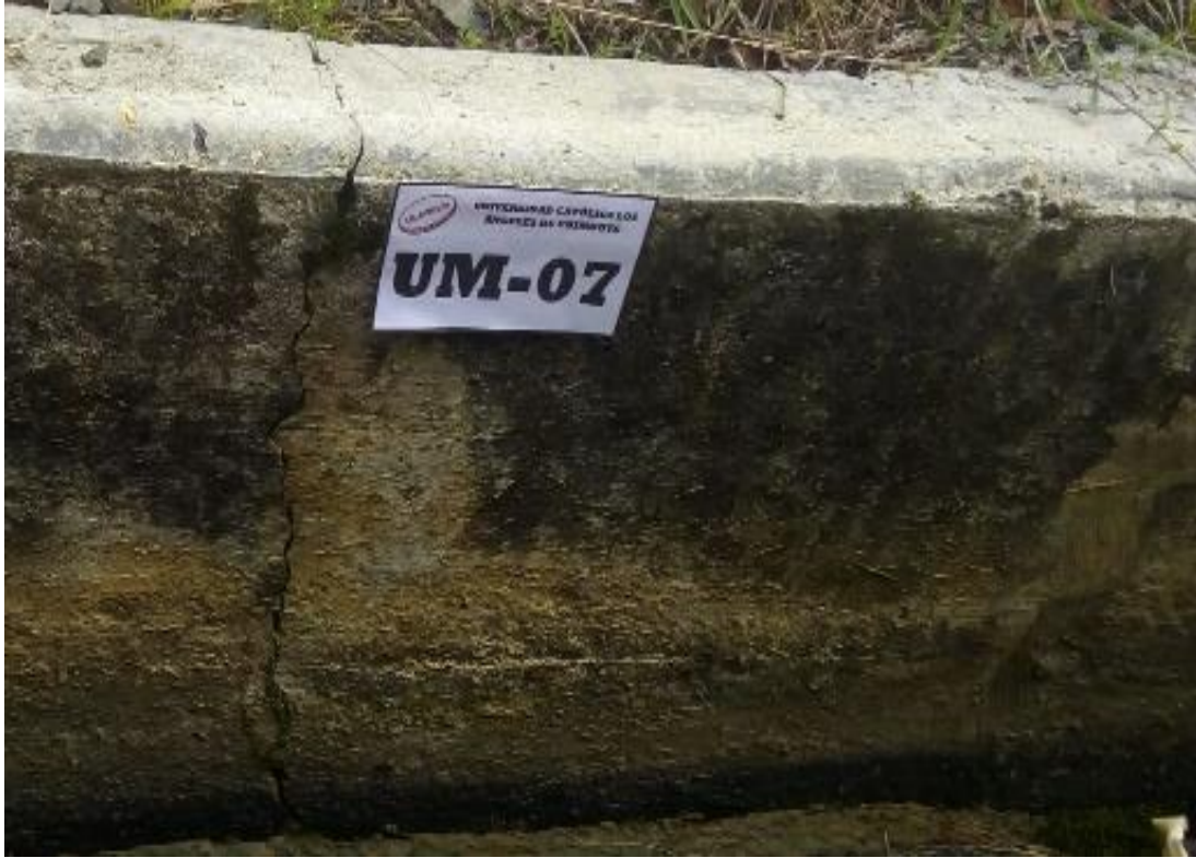
Presencia de grieta en la UM-07
