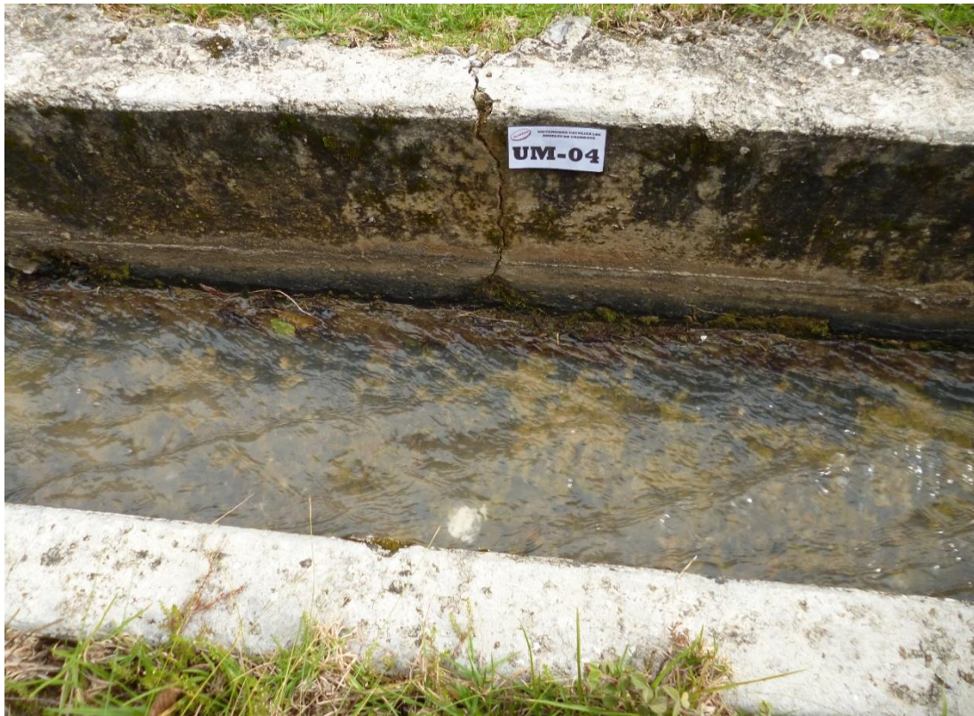
Presencia de grieta en la UM-04
