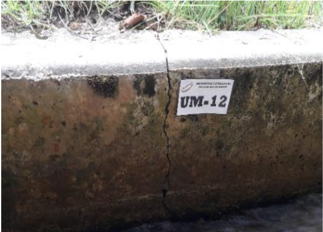
Presencia de grieta en la UM-12
