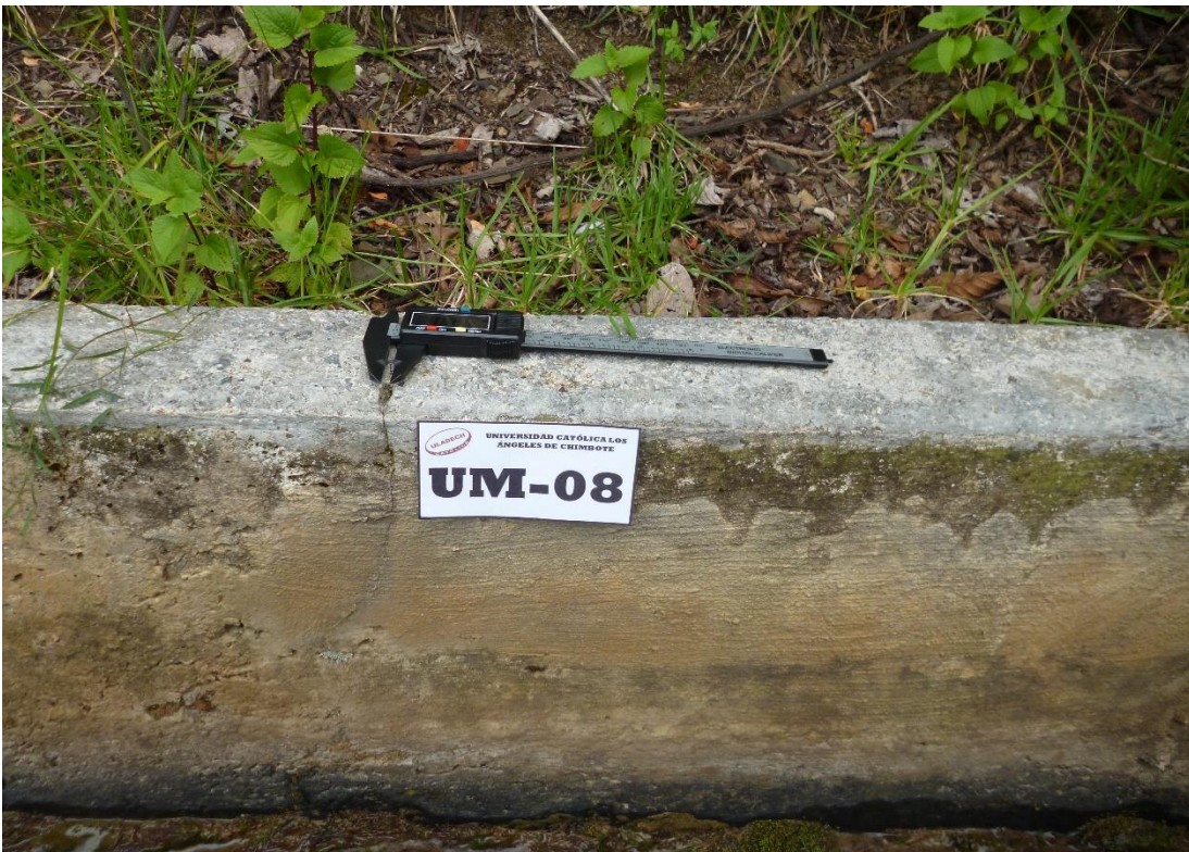
Presencia de fisura en la UM-08
