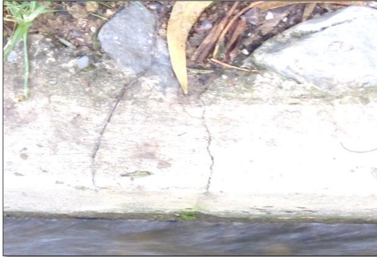
Gráfico N° 12: Grietas vertical en el muro del canal Fuente: Elaboración Propia
