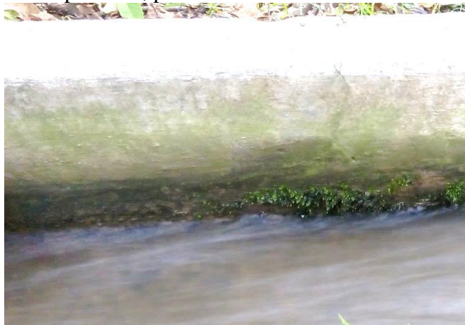
Gráfico N° 14: Erosión en el canal de concreto Fuente: Elaboración Propia
