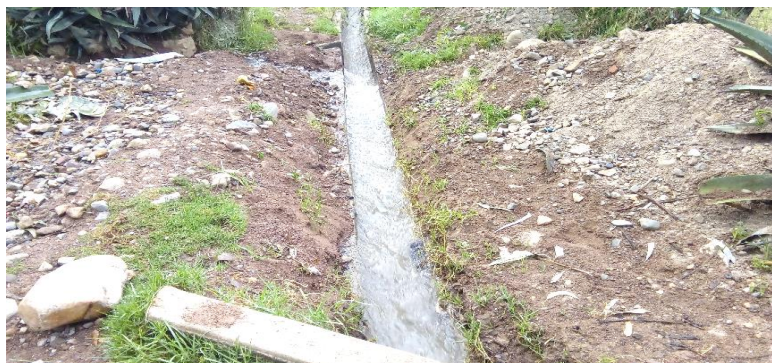
Imagen 1: Sedimento en la caja hidráulica del canal
