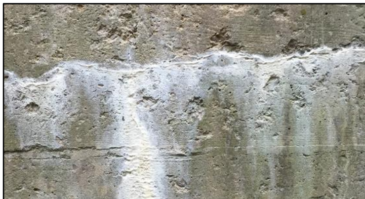
Gráfico N° 15: Descascaramiento en canal de concreto
