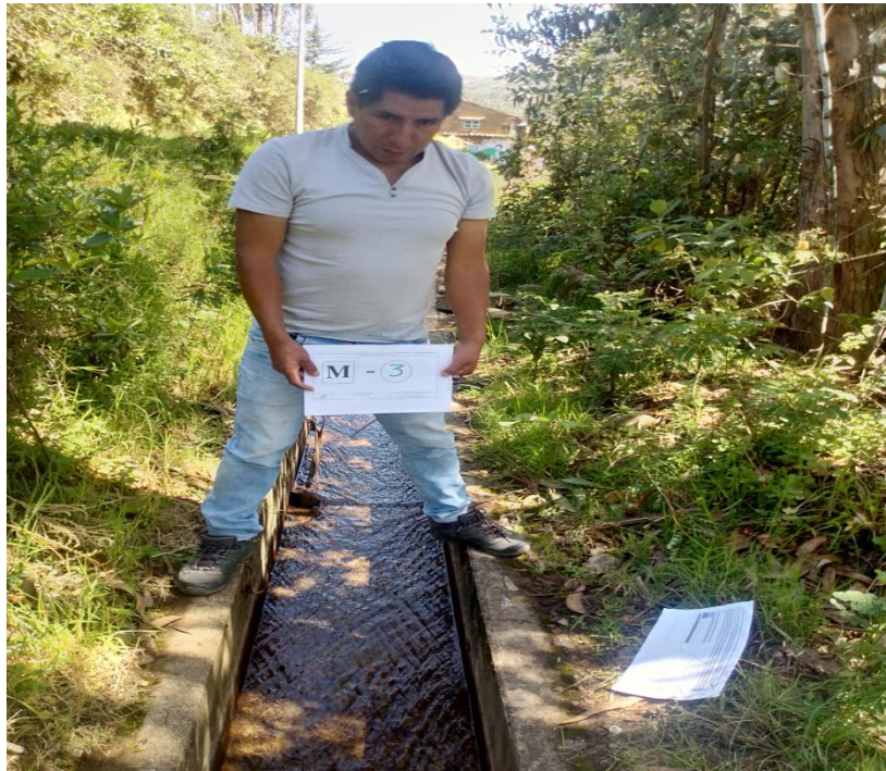
FOTOGRAFIA N° 06: Patologías observadas en canal de riego Poyac – sector
