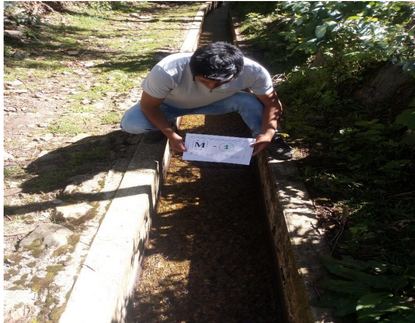
FOTOGRAFIA N° 04: Patologías observadas en canal de riego Poyac – sector
