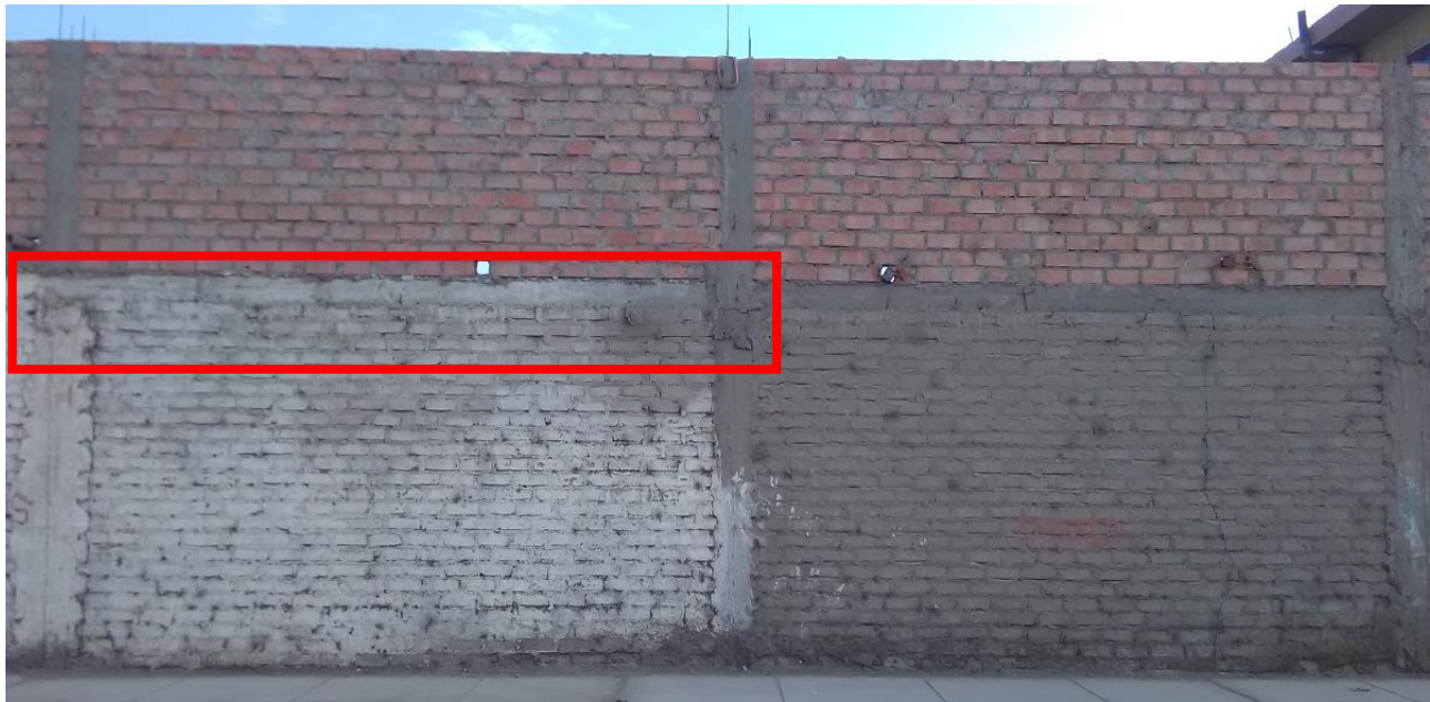
Fotografía 4: UM-02 afectado por el desprendimiento, con un porcentaje de 7.74% y un nivel MODERADO.
