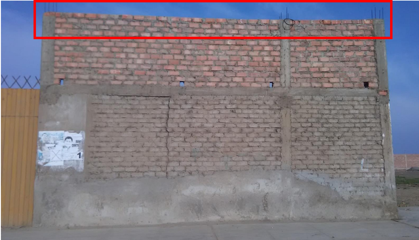
Fotografía 7: UM-14 afectado por la CORROSIÓN, con un porcentaje de 0.98% y un nivel SEVERO.
