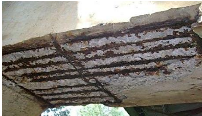
Gráfico 16: Corrosión del acero en una viga. Fuente: León A. (2015).
