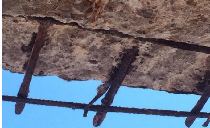
Gráfico 19: Oxidación en vigas de concreto armado. Fuente: Roslin R. (2016).
