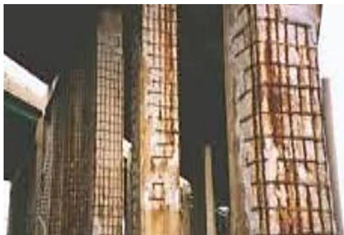
Gráfico 17: Corrosión del acero en una columna. Fuente: León A. (2015).
