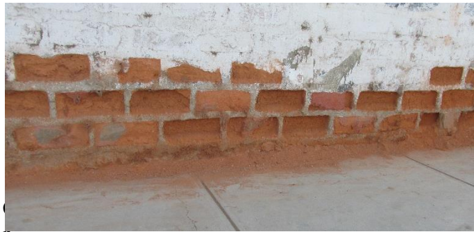
Figura 10: Erosión en muros de mampostería. Fuente: Elab. Propia (2019).
