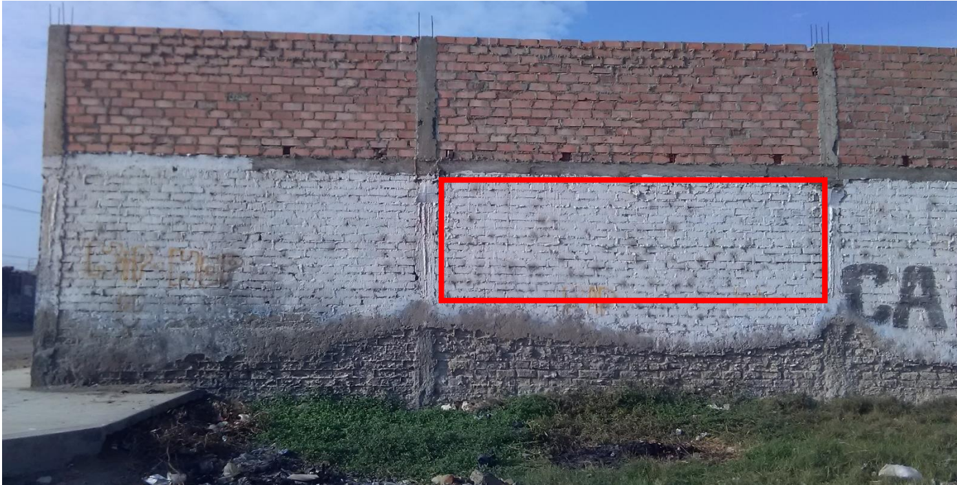
Fotografía 6: UM-15 afectado por las FISURAS, con un porcentaje de 1.32% y un nivel MDOERADO.
