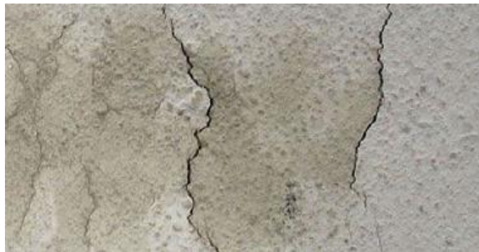
Gráfico 11: Fisuras en Muros de Mampostería. Fuente: Monjo J. (1997).
