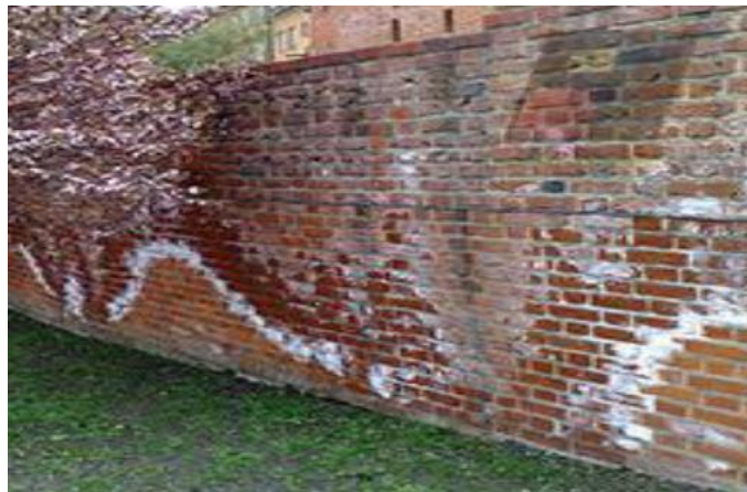
Gráfico 18: Eflorescencia en muro de mampostería. Fuente: Rincón J, Romero M. (2001).
