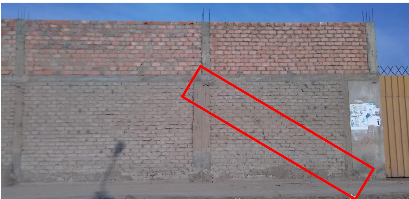
Fotografía 5: UM-13 afectado por la GRIETA, con un porcentaje de 2.85% y un nivel SEVERO.
