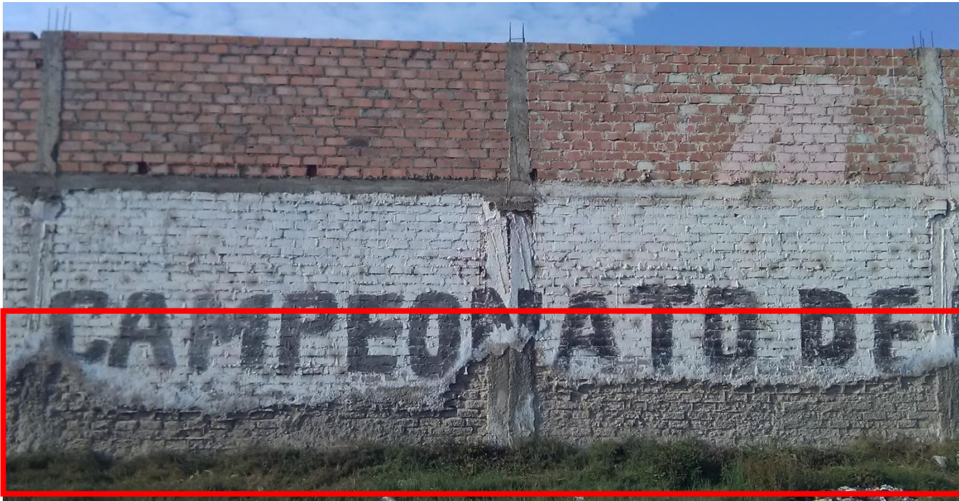
Fotografía 3: UM-16 afectado por la erosión, con un porcentaje de 20.51% y un nivel SEVERO.
