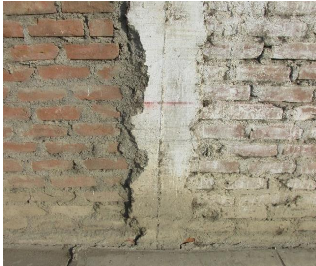
Gráfico 15: Desprendimiento del concreto en columnas.
