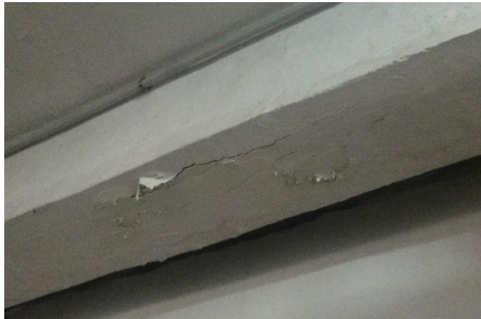
Gráfico 12: Grieta en viga de concreto armado. Fuente: Elaboración Propia. (2019).
