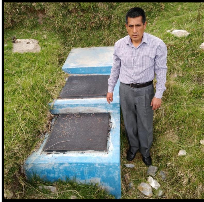
Foto 01: Se puede observar la captación (galería filtrante, cámara colectora, cámara de válvula)
