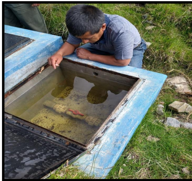
Figura 09: Vista de la cámara de válvulas, tipo ladera, regular estado de conservación, no posee cerco perimétrico.
