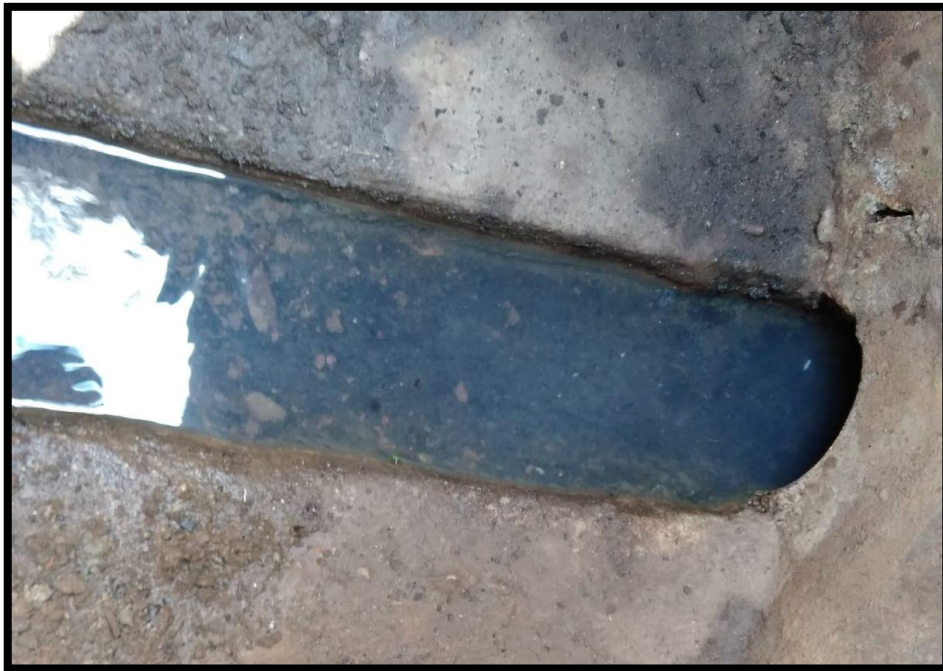
Foto 07: Se puede visualizar el interior del buzón colector que presento pequeñas acumulaciones de agregado.
