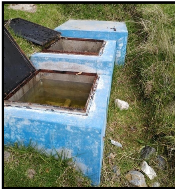
Foto 02: Fue necesario abrir las tapas de la cámara filtrante y cámara de válvula para ver la condición actual en la que se encuentran estas.
