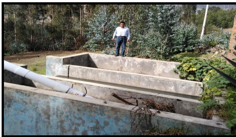
Figura 17: Vista del tanque IMHOFF.
