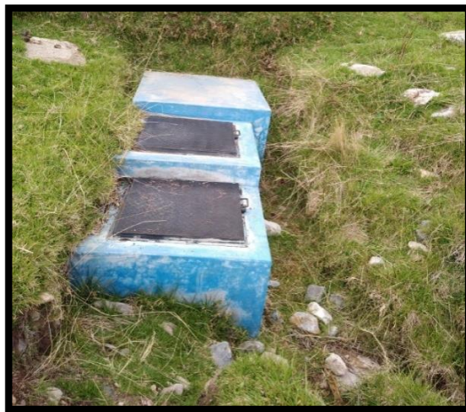
Figura 07: Galería filtrante tipo ladera, regular estado de conservación, no posee cerco perimétrico.
