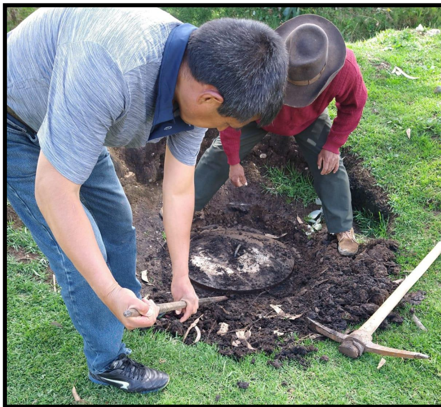
Foto 06: Se tubo que limpiar el entorno del buzón colector para poder ver su interior.
