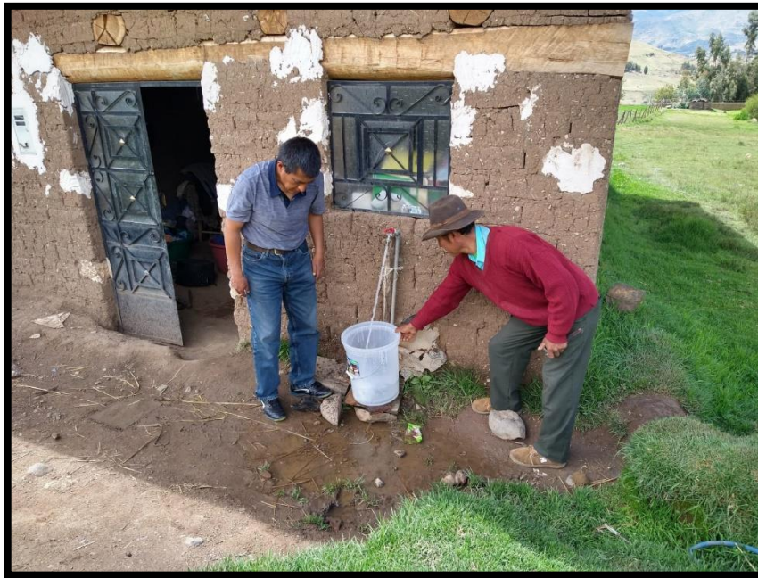
Foto 05: Se observa el funcionamiento de las instalaciones domiciliarias y a la vez se aprecia que tiene una buena presión.
