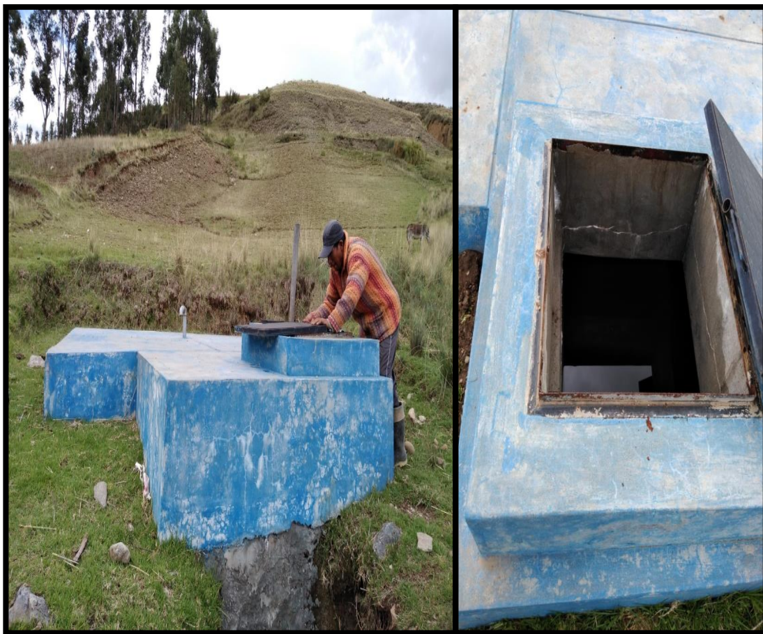
Figura 10: Vista del tanque de almacenamiento, tipo ladera, regular estado de conservación, no posee cerco perimétrico.
