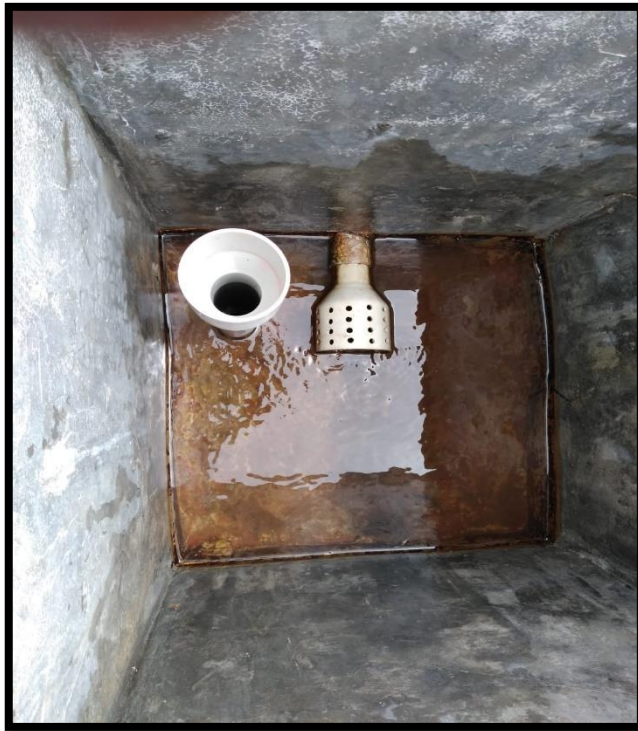
Figura 08: Vista de la cámara colectora, tubo de rebose y la canastilla de conducción de agua, regular estado de conservación, no posee cerco perimétrico.
