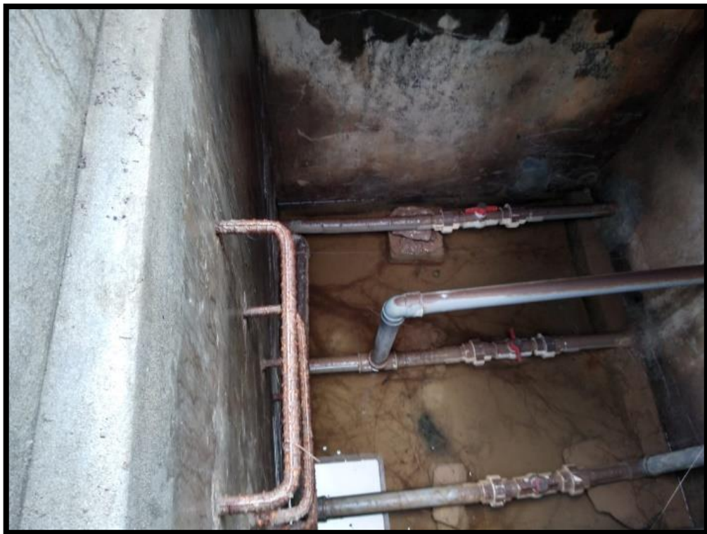
Figura 11: Vista del interior de la caseta de válvulas, regular estado de conservación, no posee cerco perimétrico.
