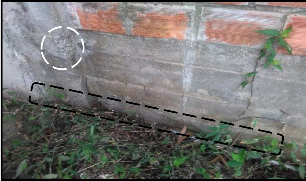
Figura 94: Presencia de corrosión en la columna y una humedad.
