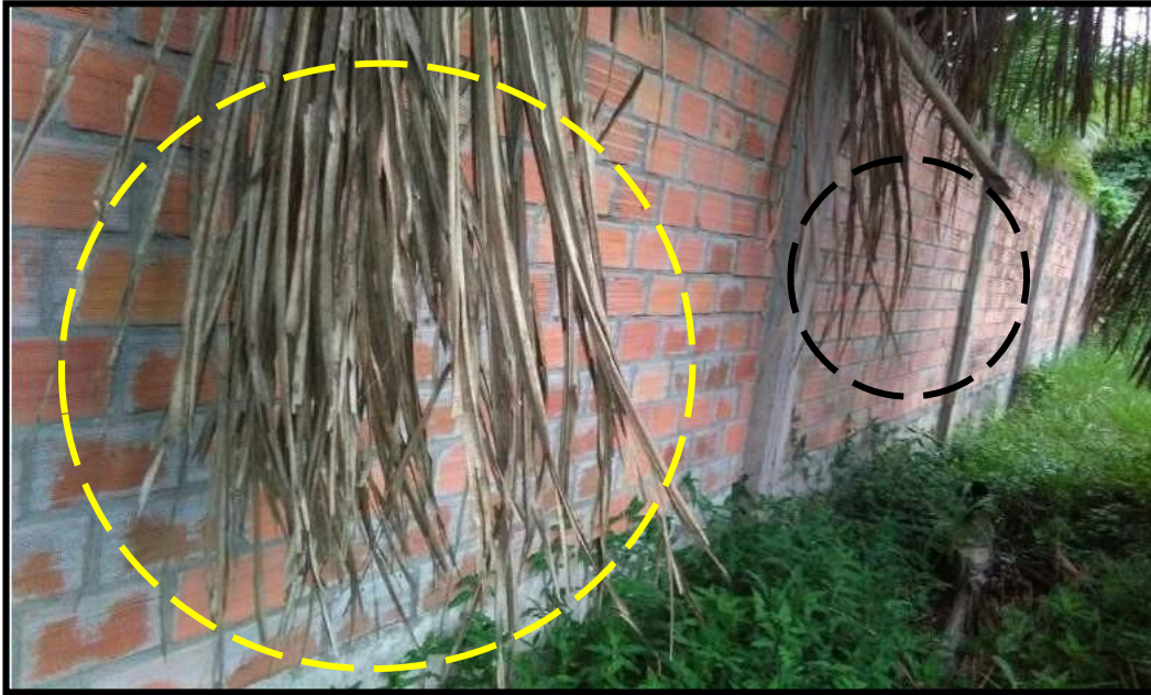
Figura 90: Se obtuvo resultados de eflorescencia en toda la estructura.
