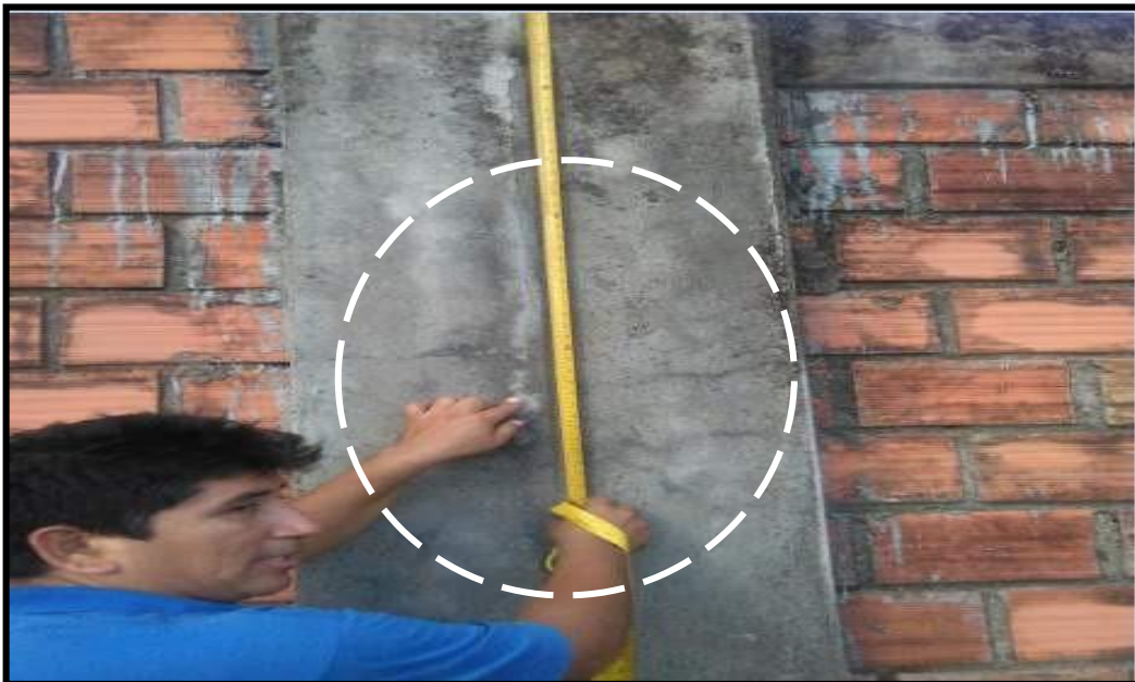
Figura 95: Se observa fisuras horizontales de leve severidad.
