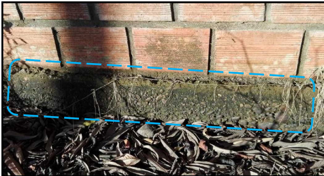
Figura 103: Se observa una desintegración de la viga de cimentación.
