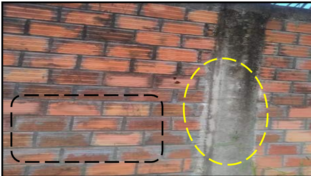
Figura 101: Presencia de eflorescencia en la columna y muro de la estructura.
