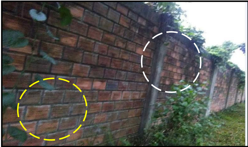
Figura 84: Presencia de eflorescencia en toda la estructura confinada.
