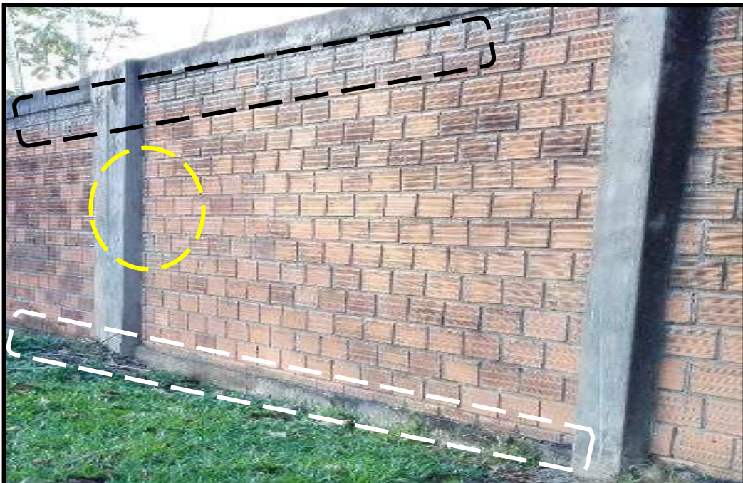
Figura 99: Se observa una eflorescencia y humedad en vigas.
