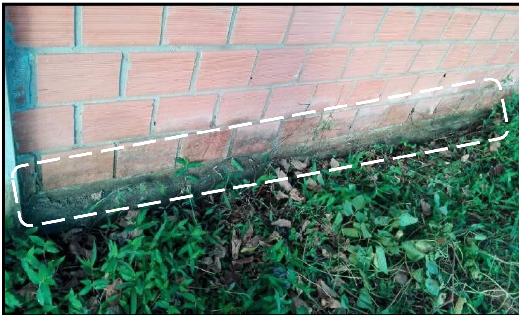
Figura 83: Se aprecia una patología de humedad de severidad severa.
