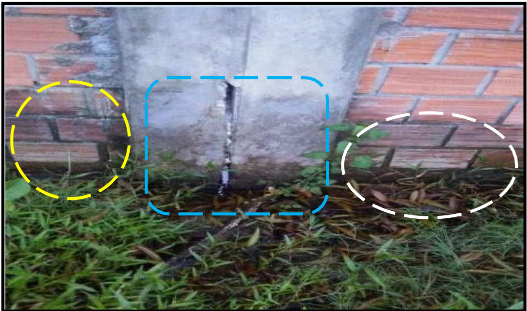
Figura 85: Se observa una humedad en muros, vigas y una desintegración.
