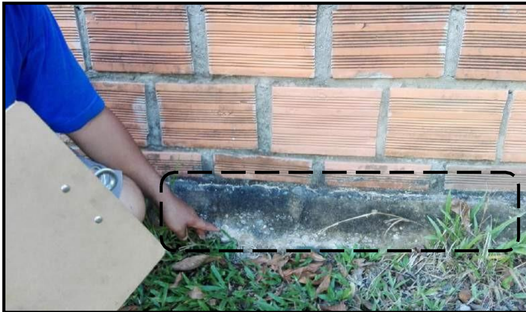
Figura 81: Identificando una desintegración de la viga.
