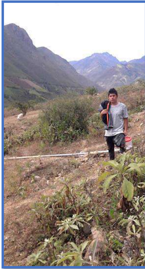
Imagen 10. Tubería de la línea de conducción.
