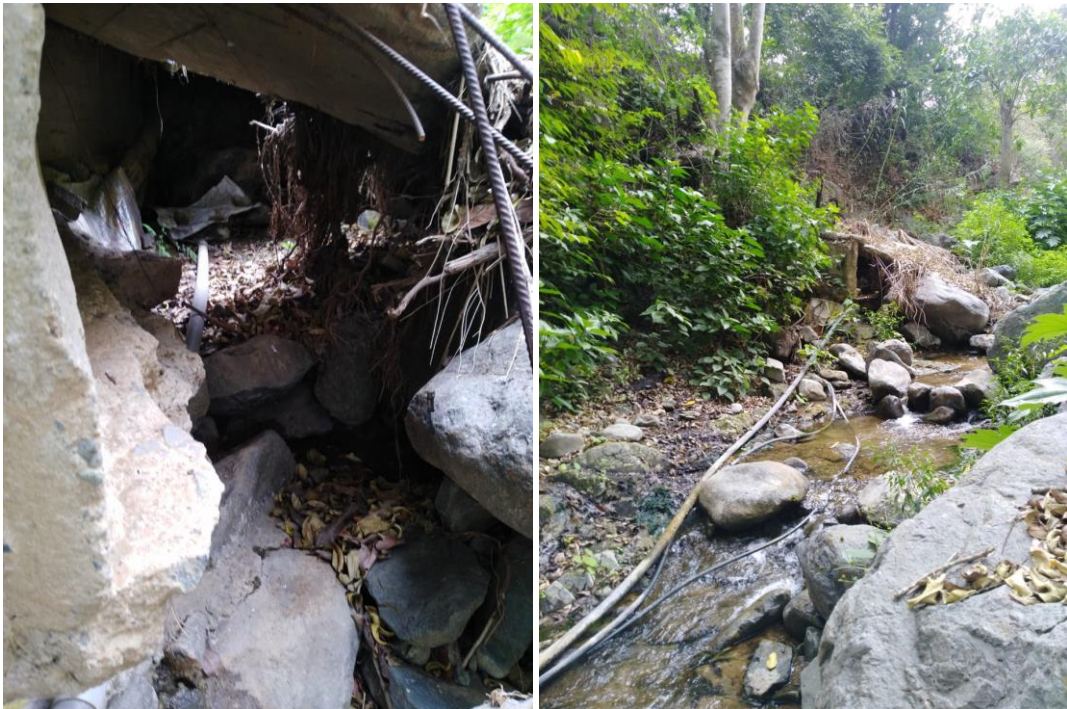
Captación en mal estado de conservación y tubería expuesta.
