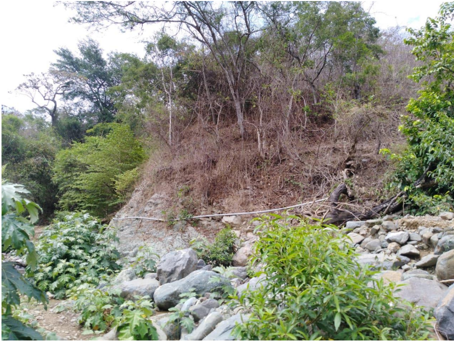
Tubería expuesta a rotura
