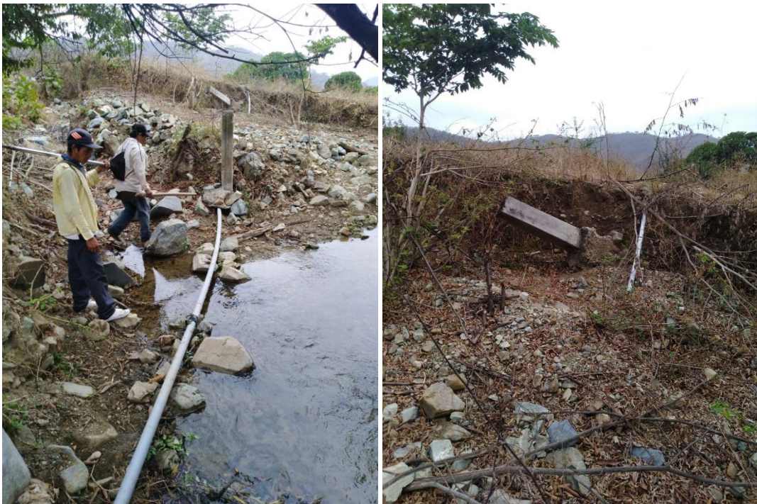
Tubería expuesta a rotura
