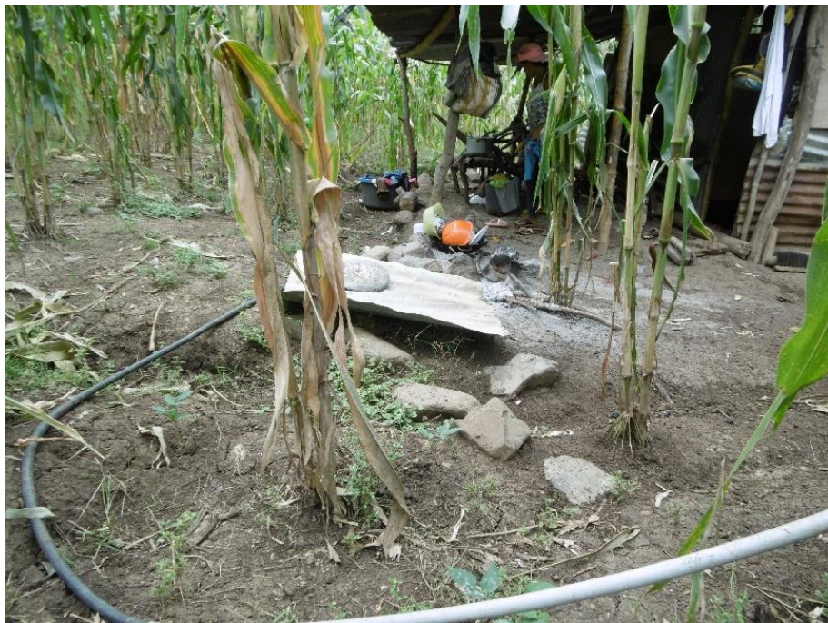
Casa beneficiada y Red de distribución expuesta a rotura.
