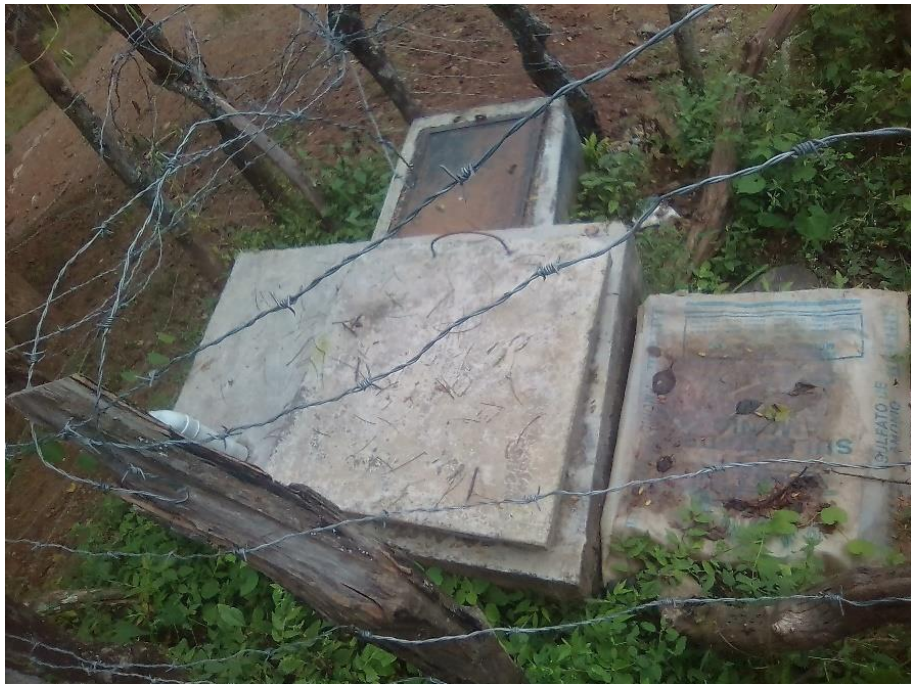
Caseta de distribución y cerco perimétrico en mal estado.
