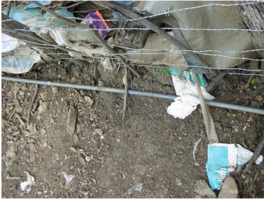
Red de distribución expuesta a rotura
