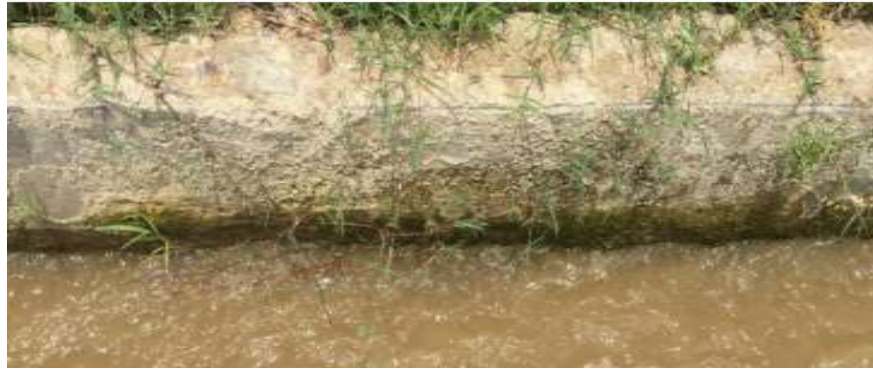
Figura 29: Mohos en el Elemento Estructural.
