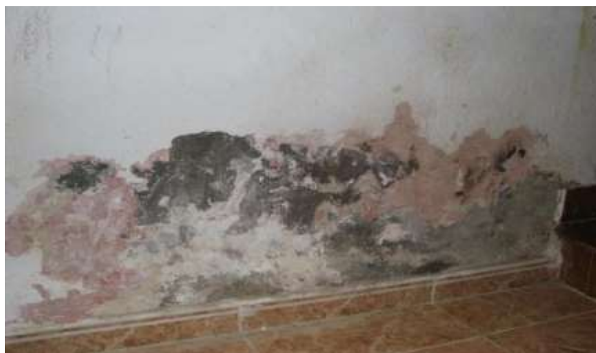
Figura 25: Eflorescencia presente en un Muro.
