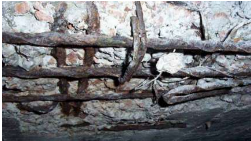
Figura 23: Corrosión del acero de una viga.
