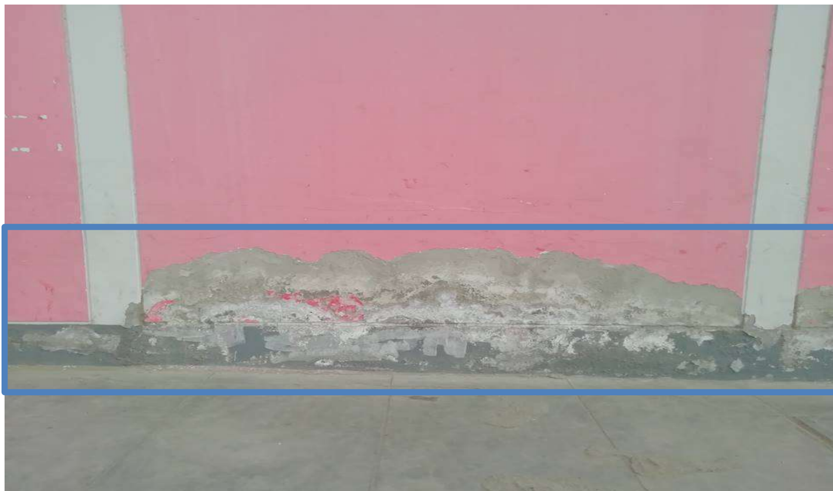
Fotografía 4: Vista de la patología Eflorescencia presente en el Sobrecimiento y Muro de la Unidad Muestral 11 del Cerco Perimétrico de la Institución Educativa N° 88229 San Juan, Distrito de Chimbote, provincia del Santa, región Áncash.
