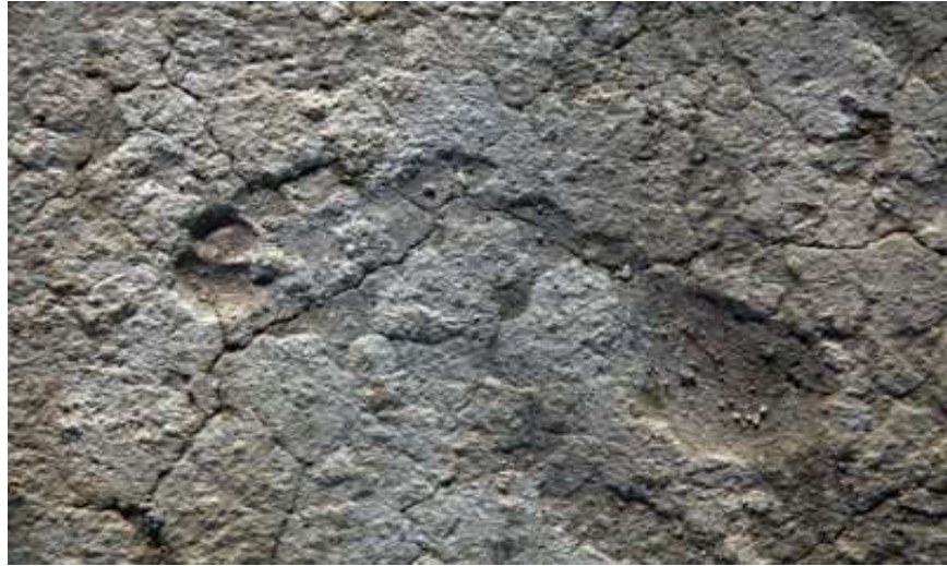
Figura 28: Desintegración del revestimiento de un Muro.
