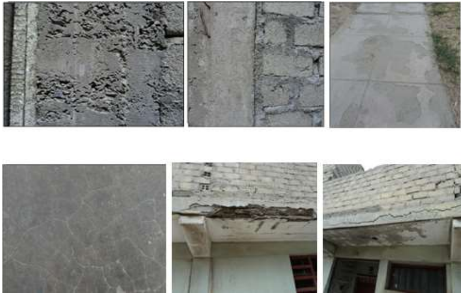
Figura 20: Diversas patologías del Concreto.
