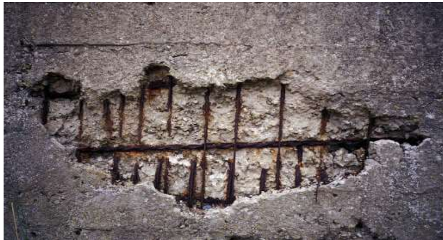
Figura 27: Desprendimiento del revestimiento de un Muro.
