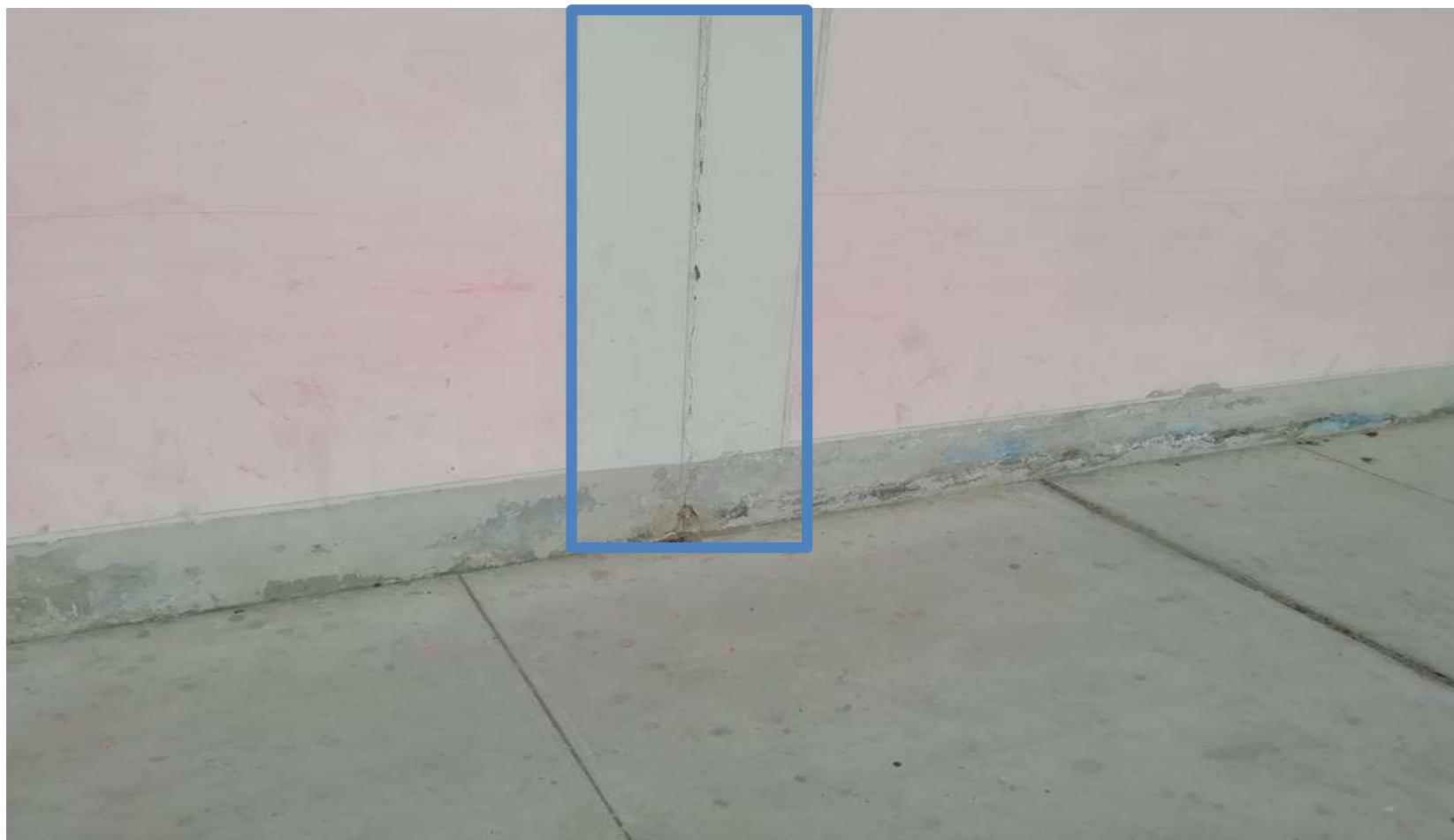
Fotografía 5: Vista de la patología Fisura presente en la Columna de la Unidad Muestral 15 del Cerco Perimétrico de la Institución Educativa N° 88229 San Juan, Distrito de Chimbote, provincia del Santa, región Áncash.
