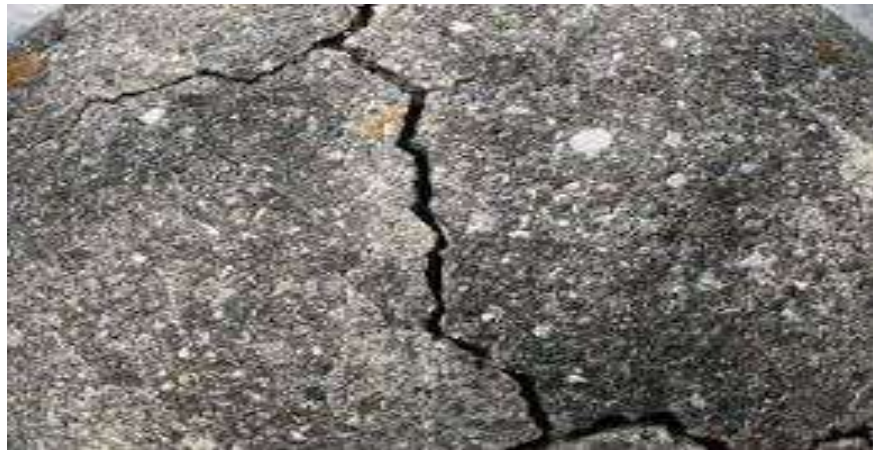
Figura 22: Grieta presente en un Muro.
