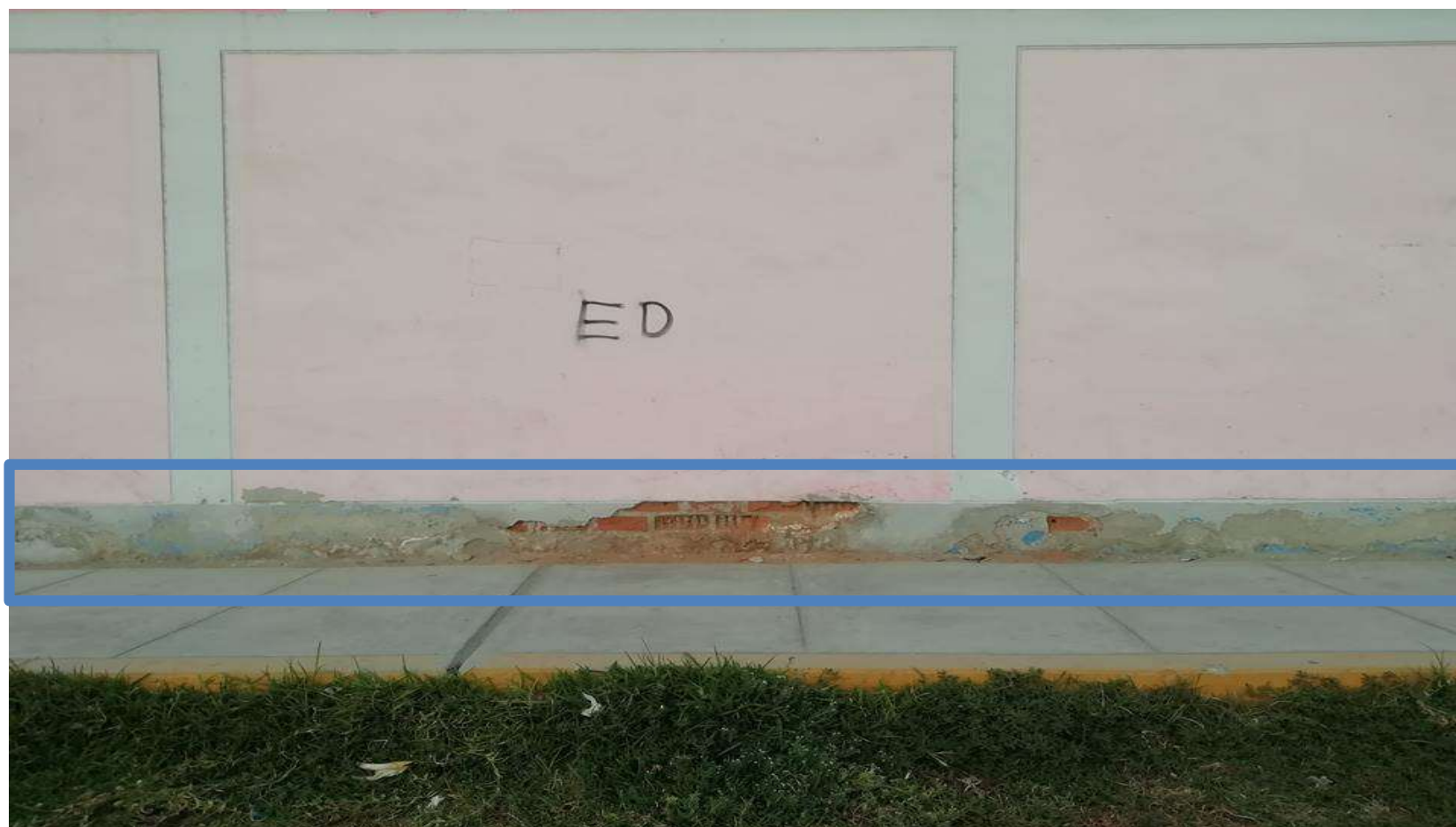
Fotografía 3: Vista de la patología Erosión presente en el Sobrecimiento de la Unidad Muestral 20 del cerco perimétrico de la Institución Educativa N° 88229 San Juan, Distrito de Chimbote, provincia del Santa, región Áncash.
