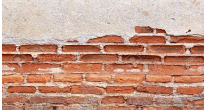
Figura 26: Erosión del ladrillo presente en un Muro.
