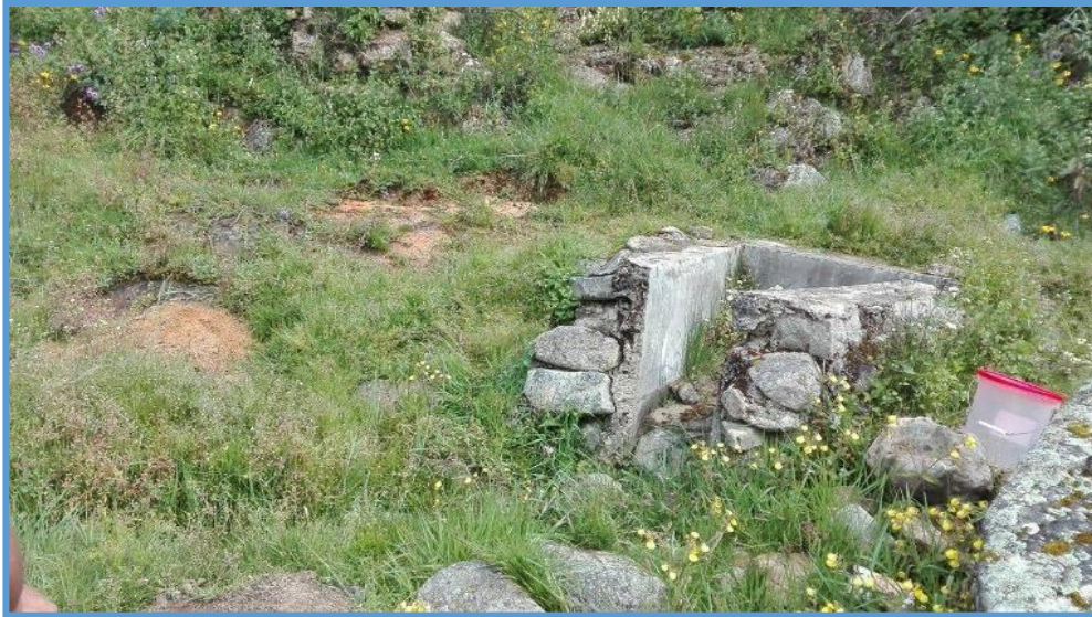
Fotografía 5: En esta fotografía se puede apreciar la cámara de captación que se encuentra en mal estado, también se puede visualizar que no cuenta con un cerco perimétrico, siendo una construcción artesanal y actualmente se encuentra en función.
