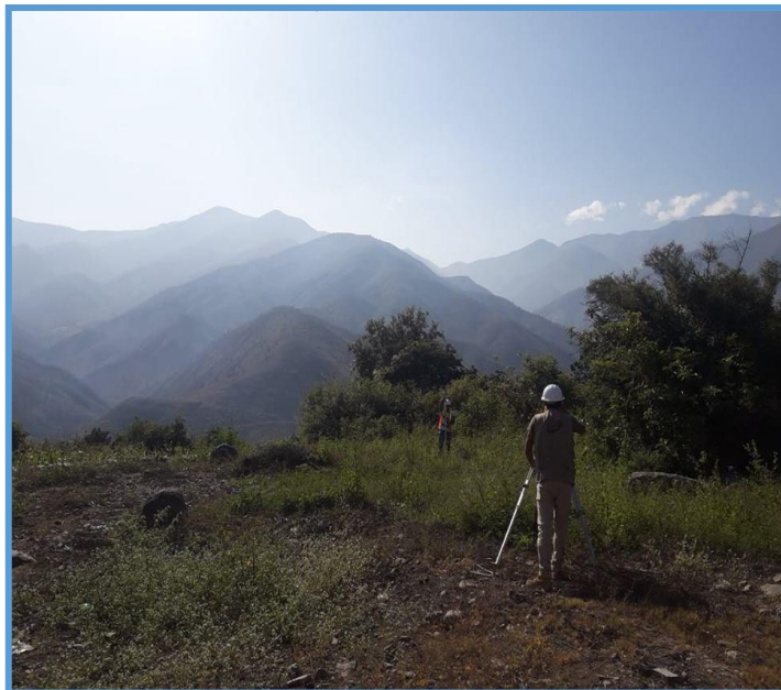
Fotografía 20: En la fotografía se puede apreciar el proceso del trabajo de levantamiento topográfico, en la línea de conducción.
