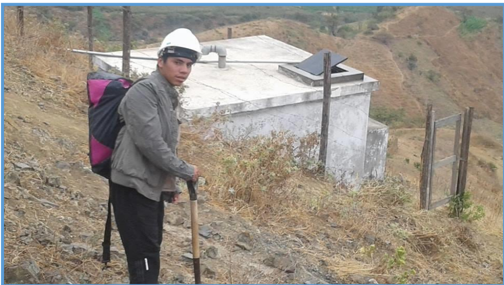
Fotografía 8: En esta fotografía se puede apreciar el reservorio de almacenamiento, se encuentra en mal estado, esto se da por falta de mantenimiento y limpieza.
