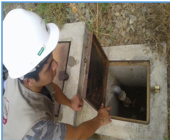
Fotografía 6: En esta fotografía se puede apreciar la cámara rompe- presión, que se encuentra en mal estado, como se puede visualizar la tapa metálica se encuentra en un estado oxidación, también en la válvula compuerta también se presentó fuga de agua, esto se da por falta de mantenimiento y limpieza.
