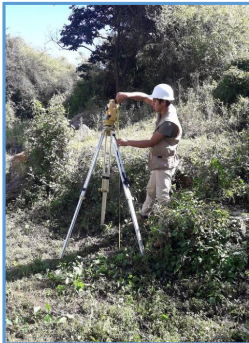
Fotografía 18: En la fotografía se puede apreciar el proceso de medición del hilo de instrumento que sirvió como dato para el cálculo de levantamiento topográfico.
