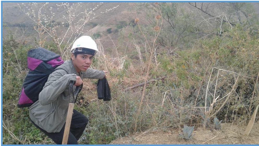
Fotografía 7: En esta fotografía se puede apreciar, en el tramo de la línea de conducción, la tubería que se encuentra entre la intemperie y se encuentran en una posición mal ubicada, esto se da por falta de mantenimiento.
