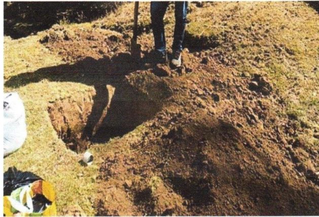
Imagen n° 5: En la imagen se puede apreciar parte de excavación de la calicata C-3 (Línea de conducción), de tal modo las muestras tomadas para procesarlas en el laboratorio.
